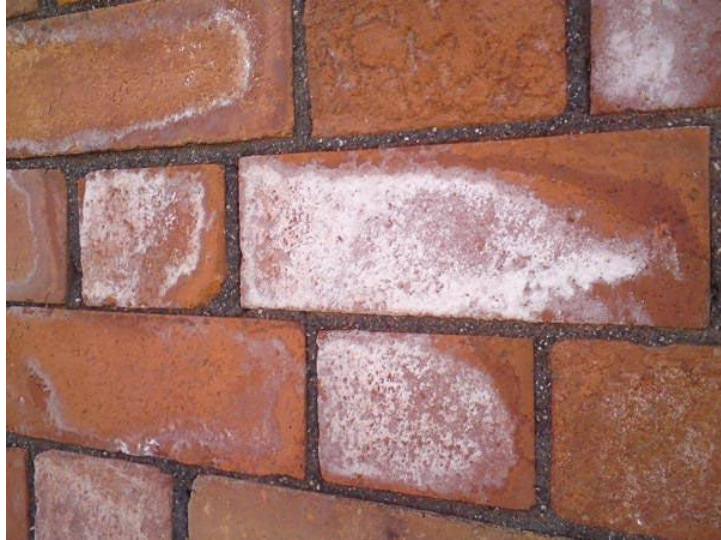
Figura 16. Imagen de eflorescencia en muro. Nota. Fuente: Soluciones especiales (2018).
