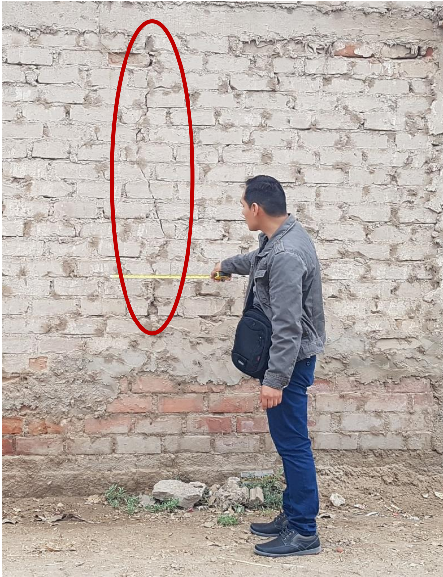
Fotografía 5. Se presenta la grieta en unidad muestral 15, provocado por asentamientos diferenciados, con un nivel de severidad Moderado en el muro lateral centro social Shindol.
