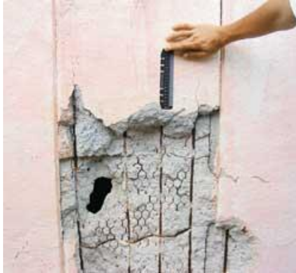
Figura 12. Imagen de patología del concreto. Nota. Fuente: Gómez, G. (2005)
