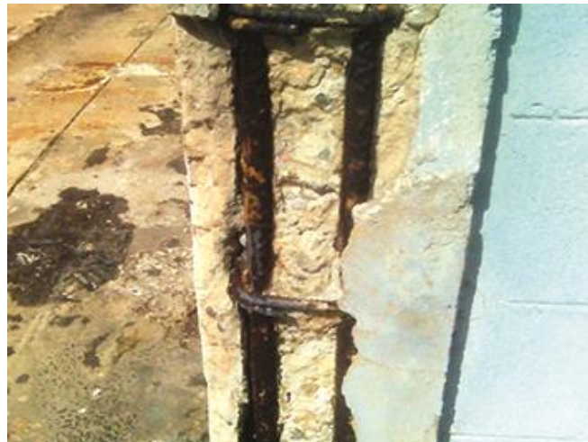
Figura 13. Imagen de corrosión en el acero de refuerzo. Nota. Fuente: Carrillo, A. (2017).
