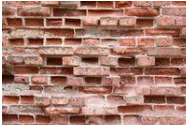
Figura 17. Imagen de erosión en muro de ladrillo. Nota. Fuente: Construmatica (2007).
