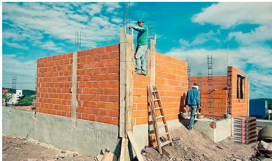
Figura 6. Imagen de albañilería. Nota. Fuente: Cemento Inka (2018).
