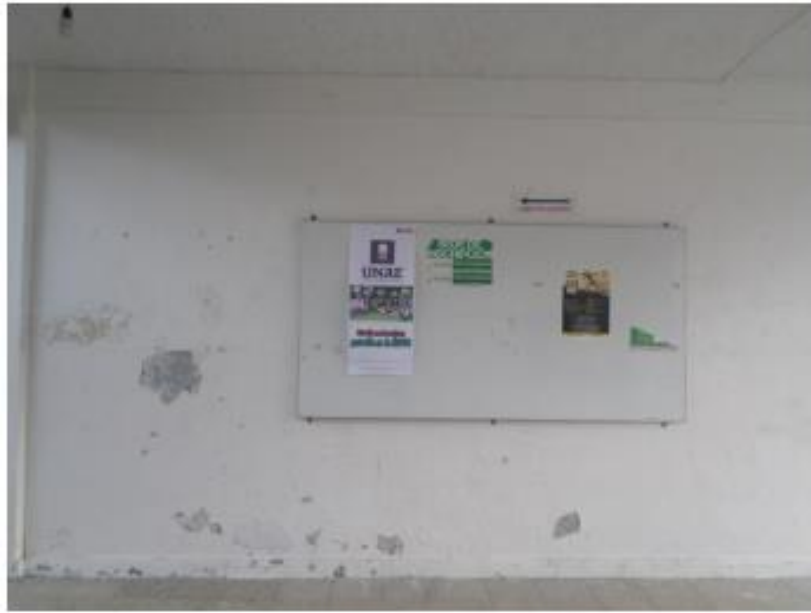
Figura 2. Eflorescencias internas en la primera planta del bloque 3 del colegio Antonio Ávila Maldonado. Nota. Fuente: Nieto, J. (2017).
