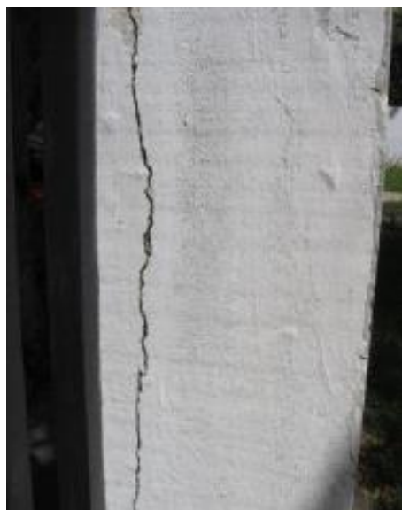
Figura 18. Imagen de grieta en columna. Nota. Fuente: Astorga y Rivero (2009).
