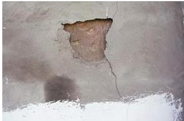
Figura 15. Imagen de proceso de desprendimiento. Nota. Fuente: Construmatica (2018).
