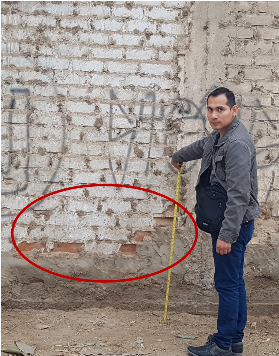
Fotografía 4. Se presenta la erosión en unidad muestral 9, provocado por la presencia de humedad, con un nivel de severidad Moderado en el muro lateral del centro social Shindol.
