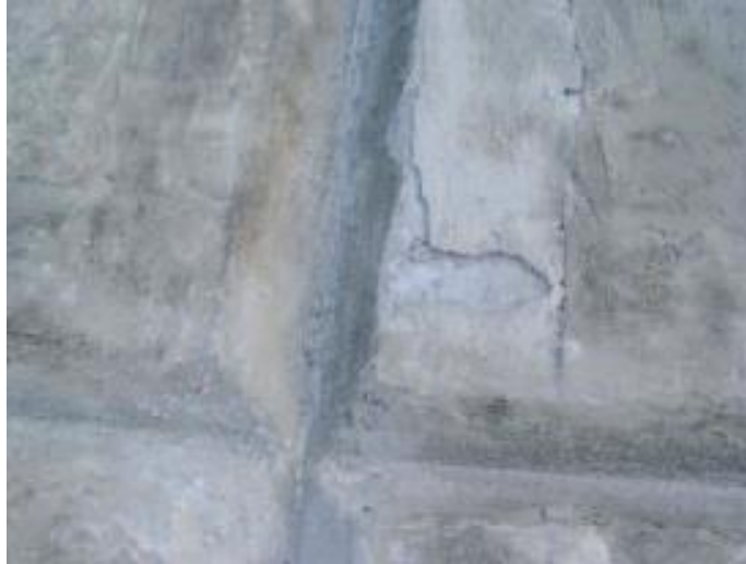
Figura 14. Delaminación del concreto debida al afinado muy temprano de la superficie.
