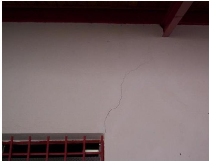
Figura 19. Imagen fisura en esquina de ventana. Nota. Fuente: Astorga y Rivero (2009).
