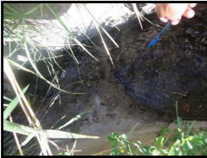
Imagen 14: Erosión en la base del Canal.
