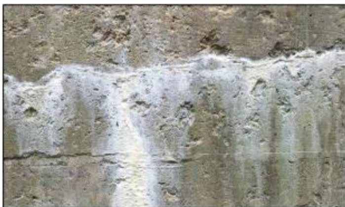
Imagen 15: Eflorescencia en las paredes del Canal.
