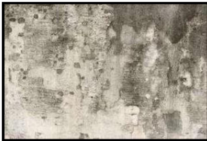
Imagen 17: Presencia de Mohos.
