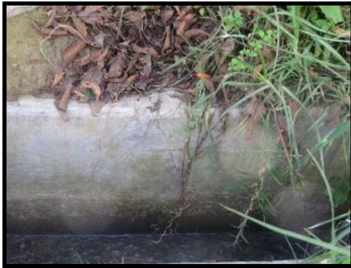
Imagen 13: Fisura en las paredes de la caja del Canal.
