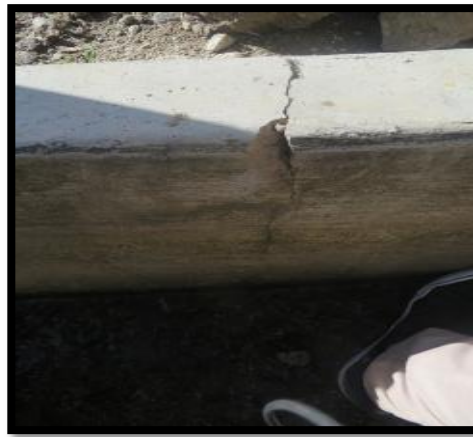
Imagen 12: Grieta en Estructura del Canal.
