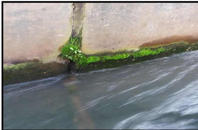
Figura 13. Musgo en las paredes del canal.
