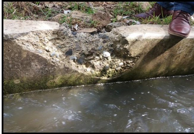
Figura 16. Rotura por impacto en la pared del canal.
