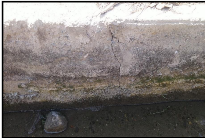
Figura 12. Fisuras en las paredes del canal.
