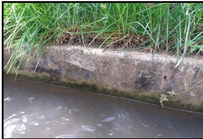
Figura 17. Moho en la pared del canal.
