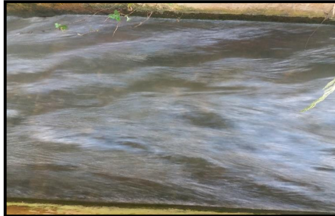
Figura 14. Erosión en el piso del canal.
