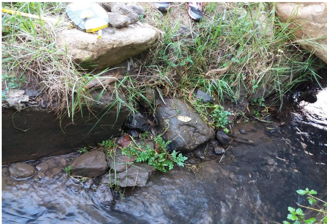
Fotografía N° 03: Agrietamiento e impacto en el muro izquierdo producto del deslizamiento de tierras y rocas de taludes altos.
