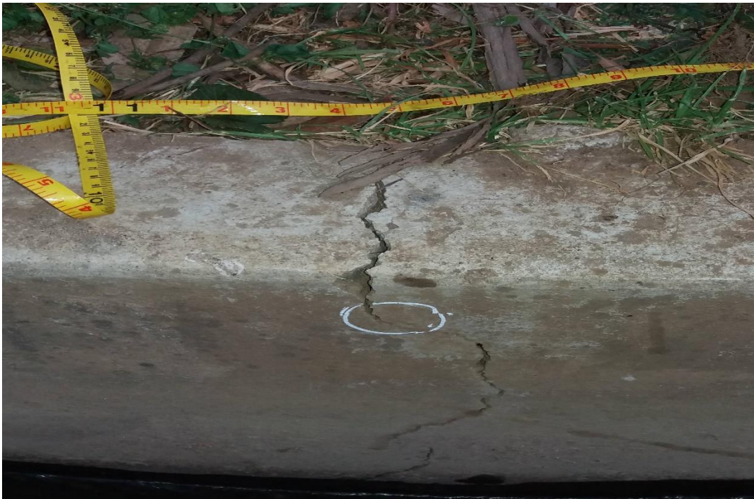
Fotografía N° 02: Patología del concreto, grieta en el muro del Canal 2.
