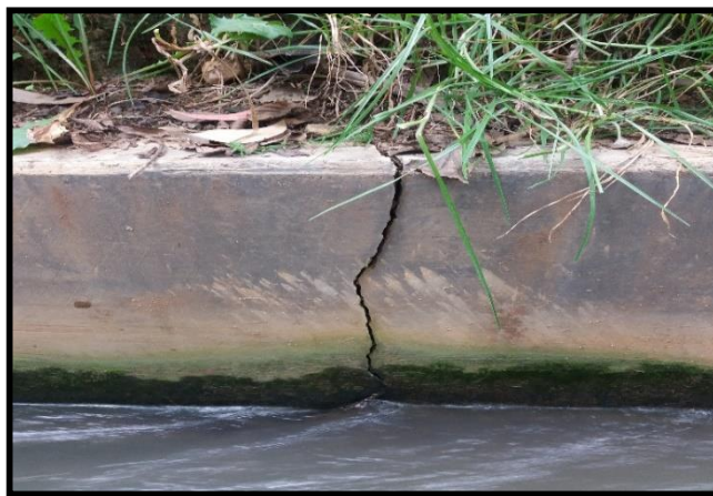
Figura 11. Grietas en las paredes del canal.
