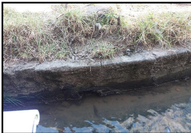
Figura 15. Fracturamiento en el muro izquierdo del canal.
