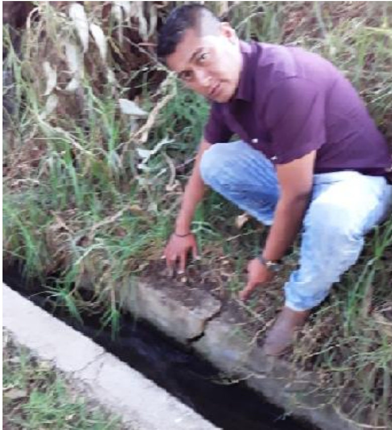
Grieta en canal.
