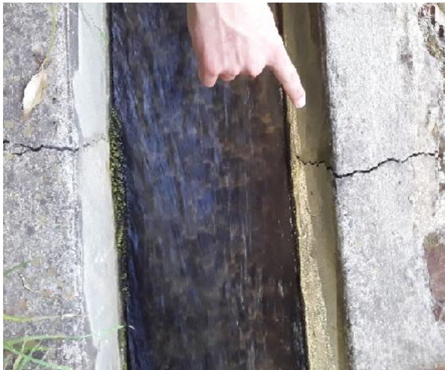
Grieta en canal.
