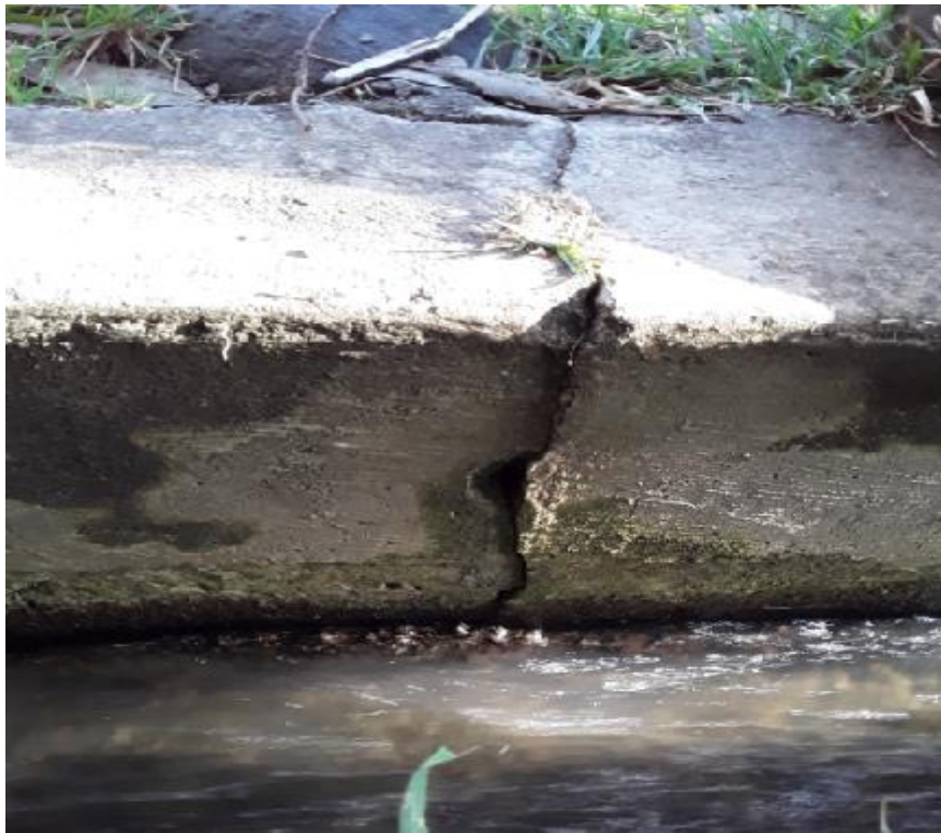
Grieta en canal.
