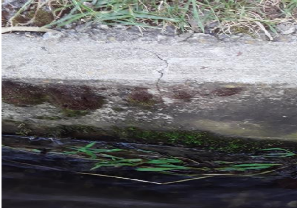
Grieta, musgo y moho en canal.
