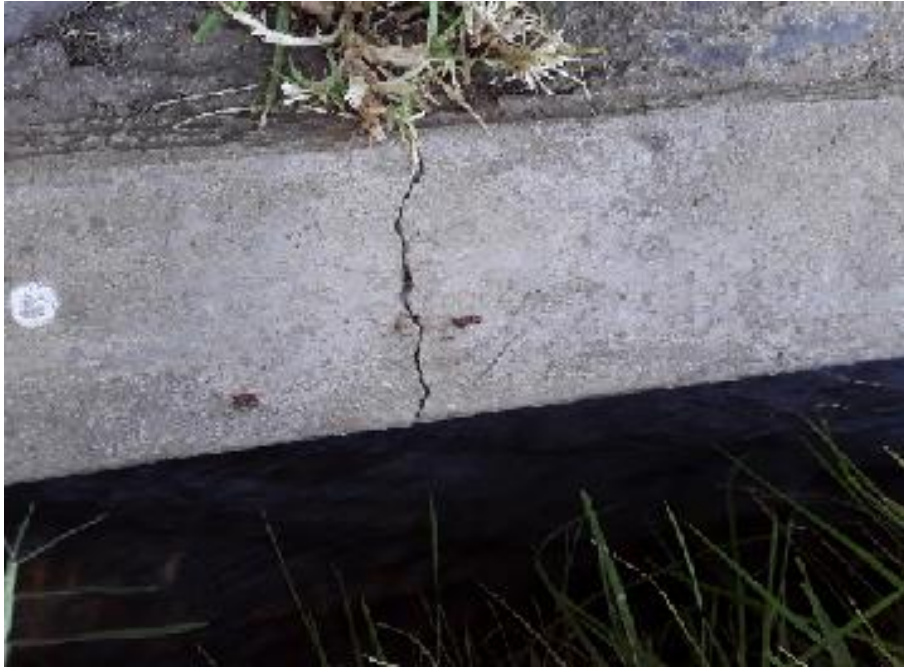
Grieta en canal.
