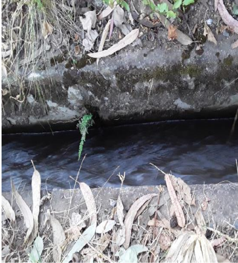
Musgo y Moho en canal.
