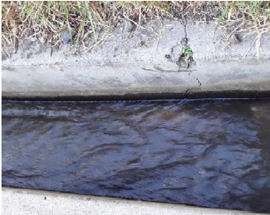
Grieta en canal.
