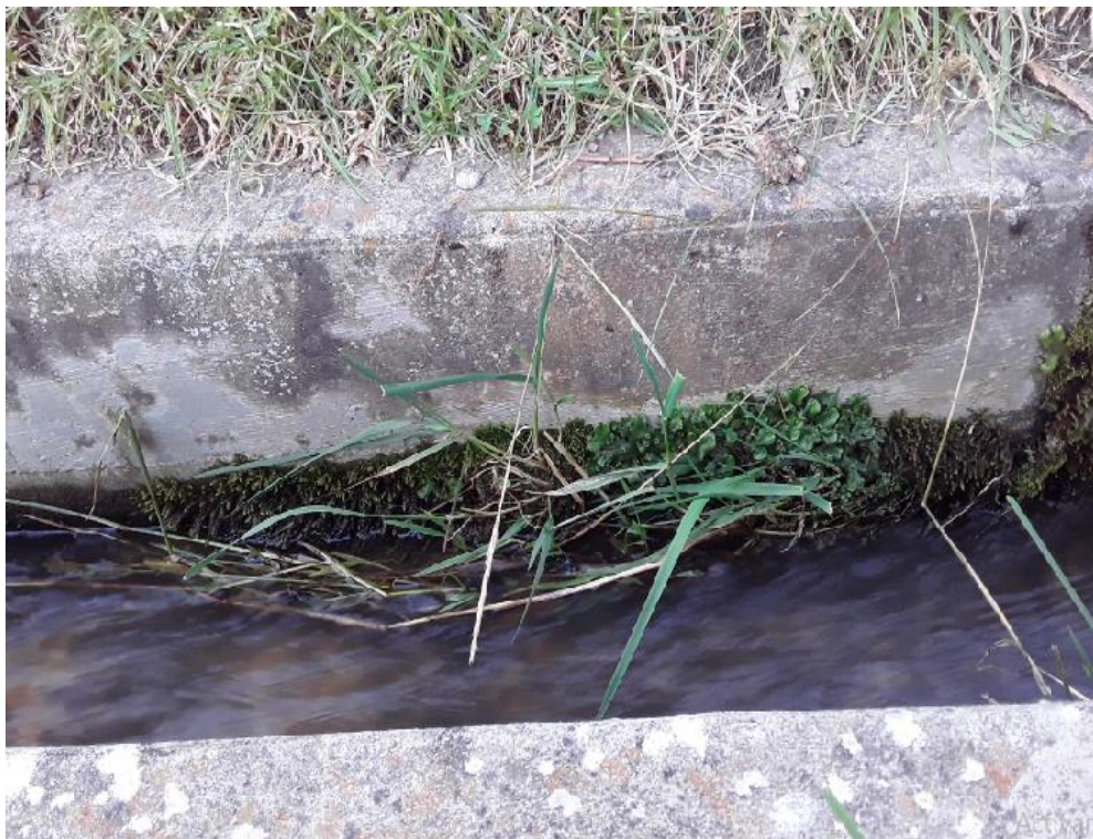
Musgo y moho en canal
