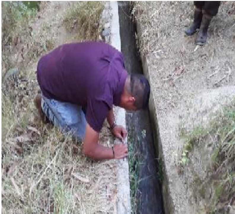
Midiendo la fisura de lado izquierdo.
