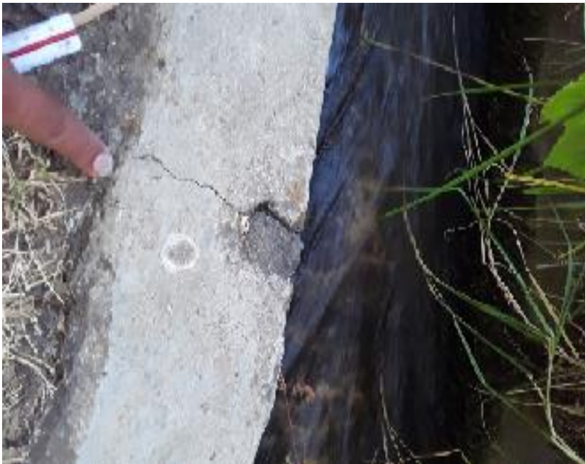
Grieta en canal.
