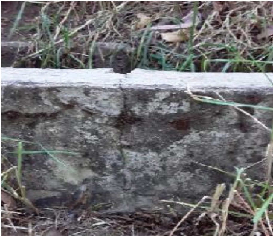
Grieta en canal.
