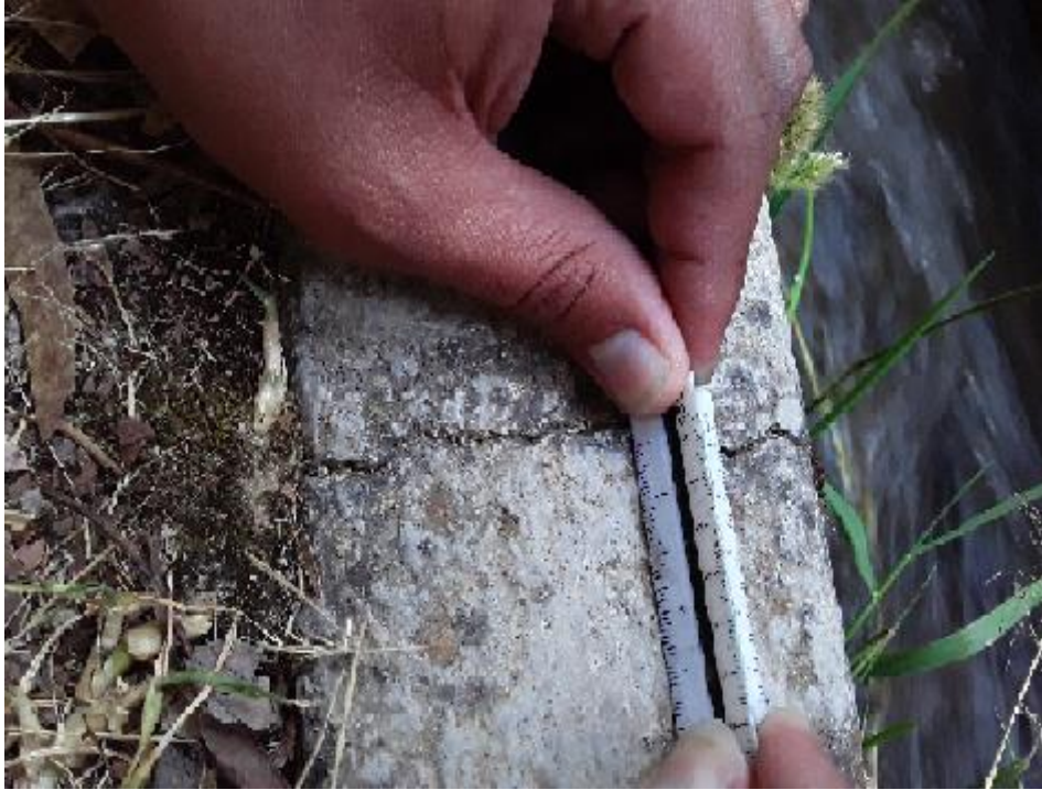
Grieta en canal.
