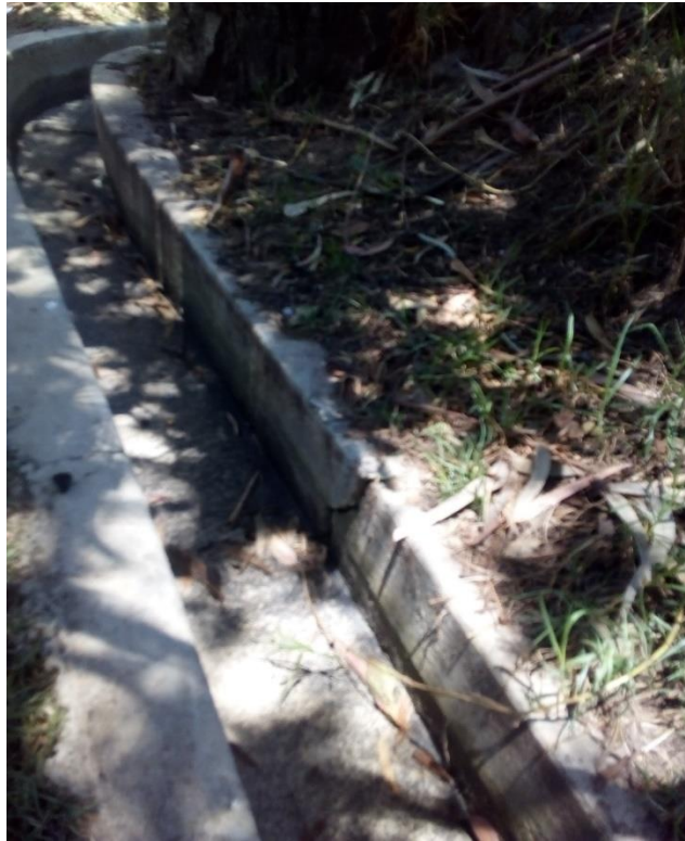
Grieta en canal.
