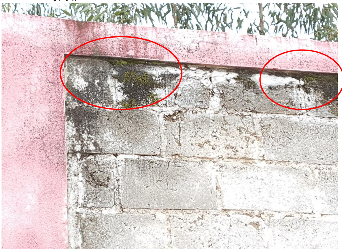
Fotografía 9: Presencia de organismos en la parte superior izquierda del muro de albañilería en la unidad de muestra N°10.
