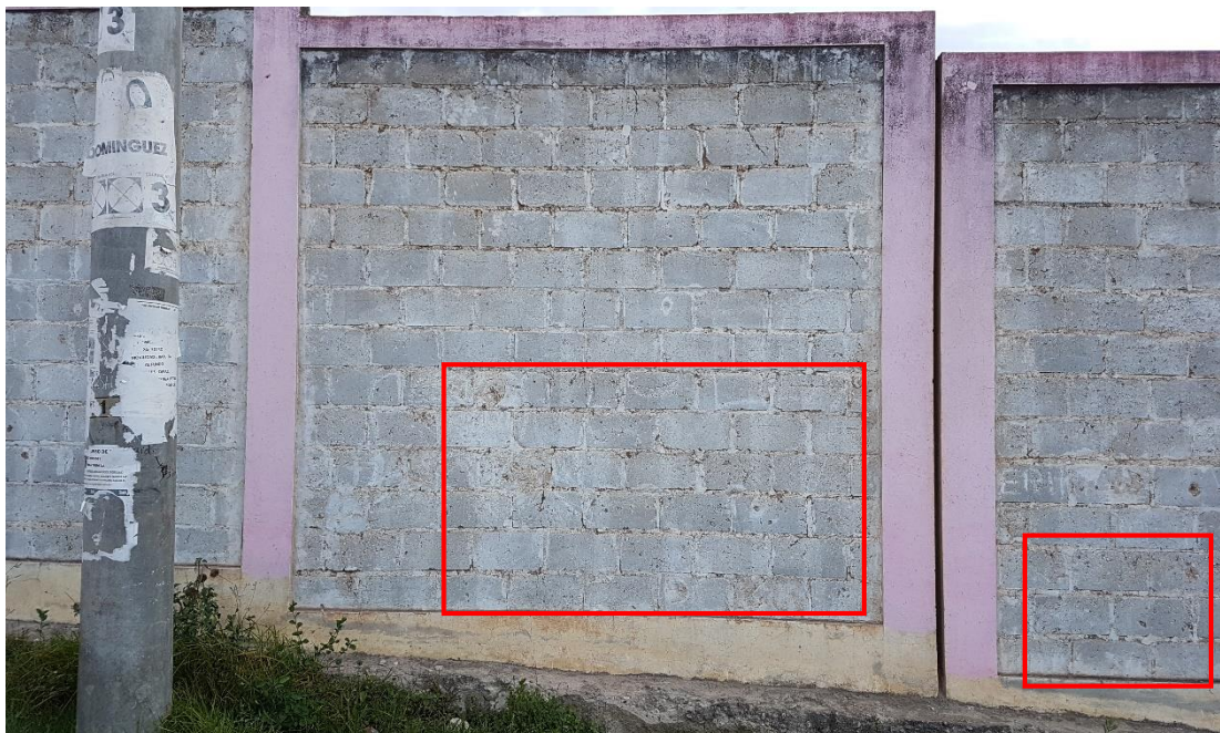
Fotografía 11: Presencia de erosión de origen físico en los muros de albañilería producido por las abundantes precipitaciones de lluvia existentes en la zona en la unidad de muestra N°10.
