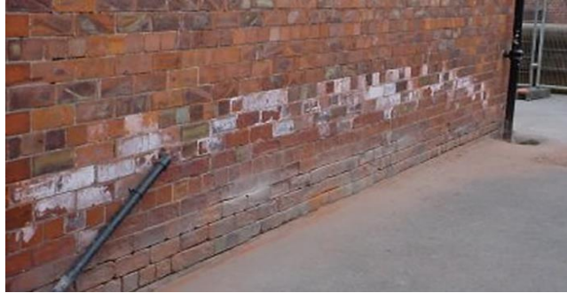
Gráfico 17 : Detalle de la eflorescencia en el muro.
