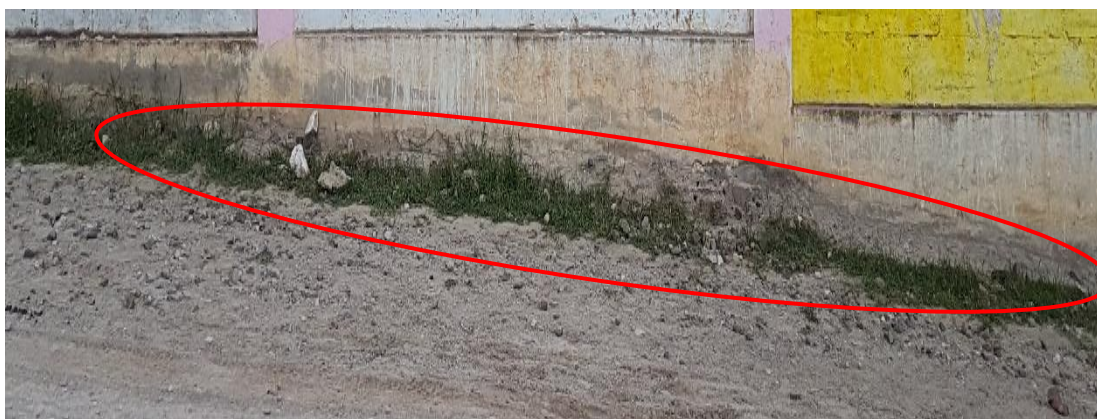
Fotografía 8: Sobrecimiento afectado por el erosión física en la unidad de muestra N°04.
