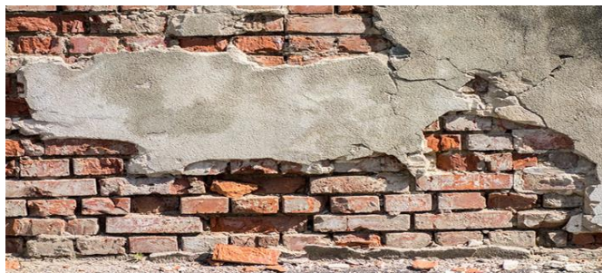
Gráfico 14: Muro afectado por la erosión física. Nota Fuente: Vásquez J. (2016).
