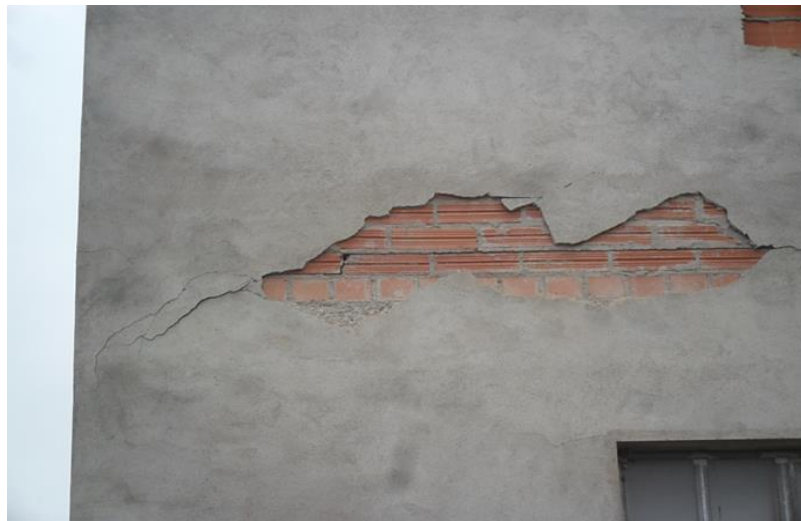
Gráfico 16: Detalle del desprendimiento del acabado del muro.
