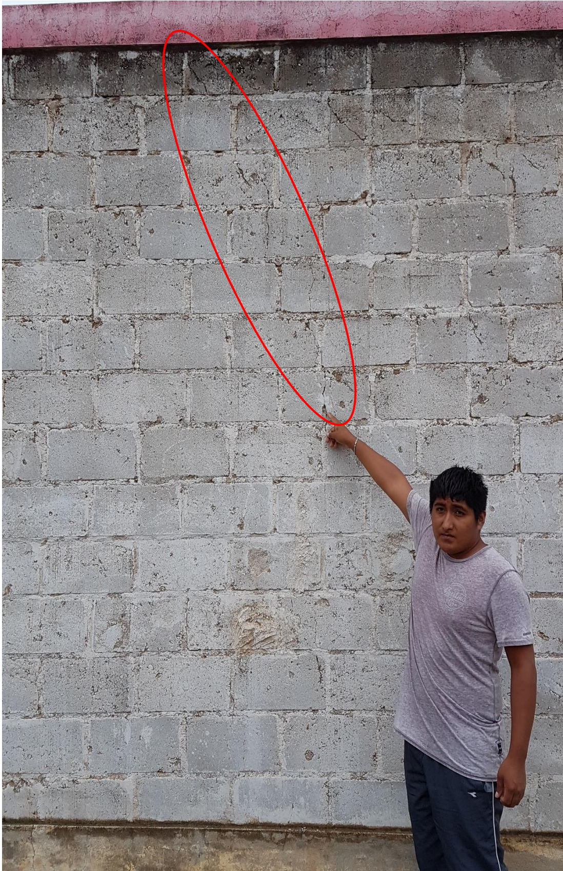
Fotografía 3: Muro de albañilería afectada por la grieta en la unidad de muestra N°04
