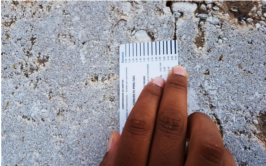
Fotografía 4: Medición del ancho de la grieta 3.50 mm con un comparador de grietas que afecta al muro de albañilería en la unidad de muestra N°02.
