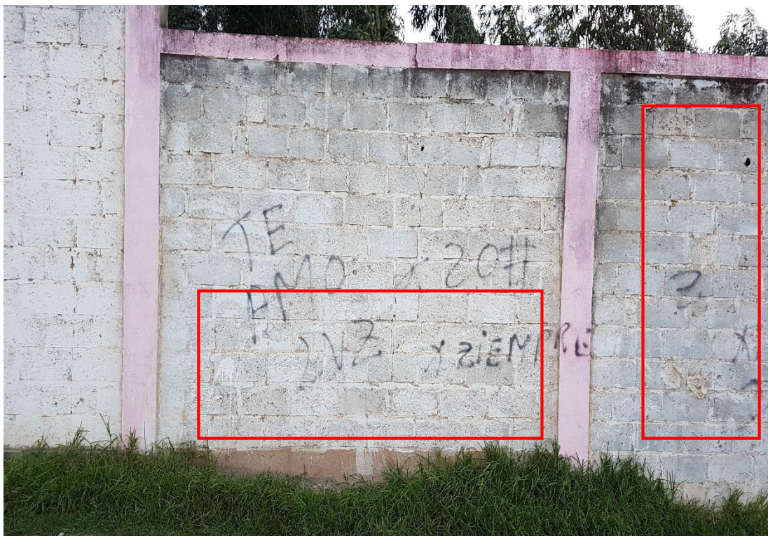
Fotografía 12: Presencia de erosión de origen físico en los muros de albañilería producido por las abundantes precipitaciones de lluvia existentes en la zona en la unidad de muestra N°03.
