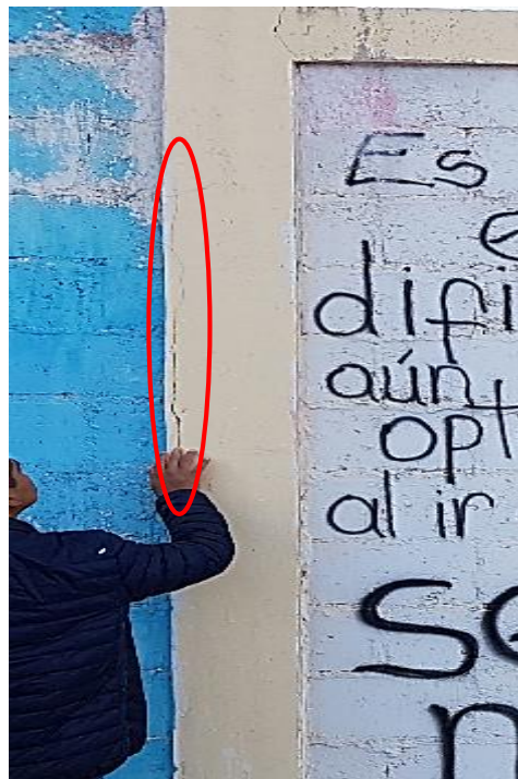
Fotografía 5: Columna de confinamiento afectada por la fisura en la unidad de muestra N°08.
