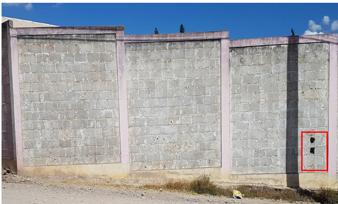
Fotografía 13: Detalle de la unidad de albañilería erosionada parcialmente, este desgaste de la unidad está representada por una abertura cuadrada en la unidad de muestra N°11.
