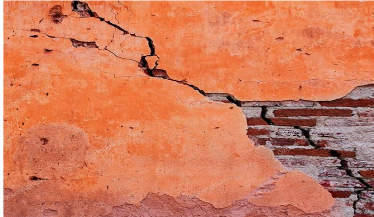
Gráfico 15: Detalle de grieta por corte.
