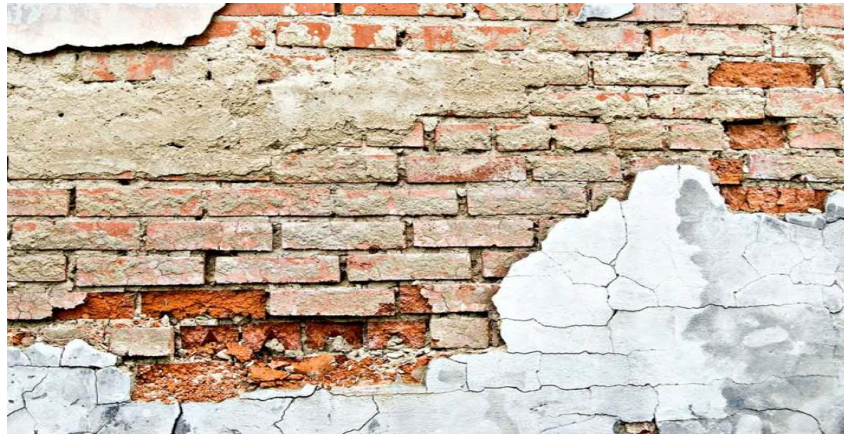
Gráfico 12: Presencia de fisuras, desprendimiento y erosión en muro.
