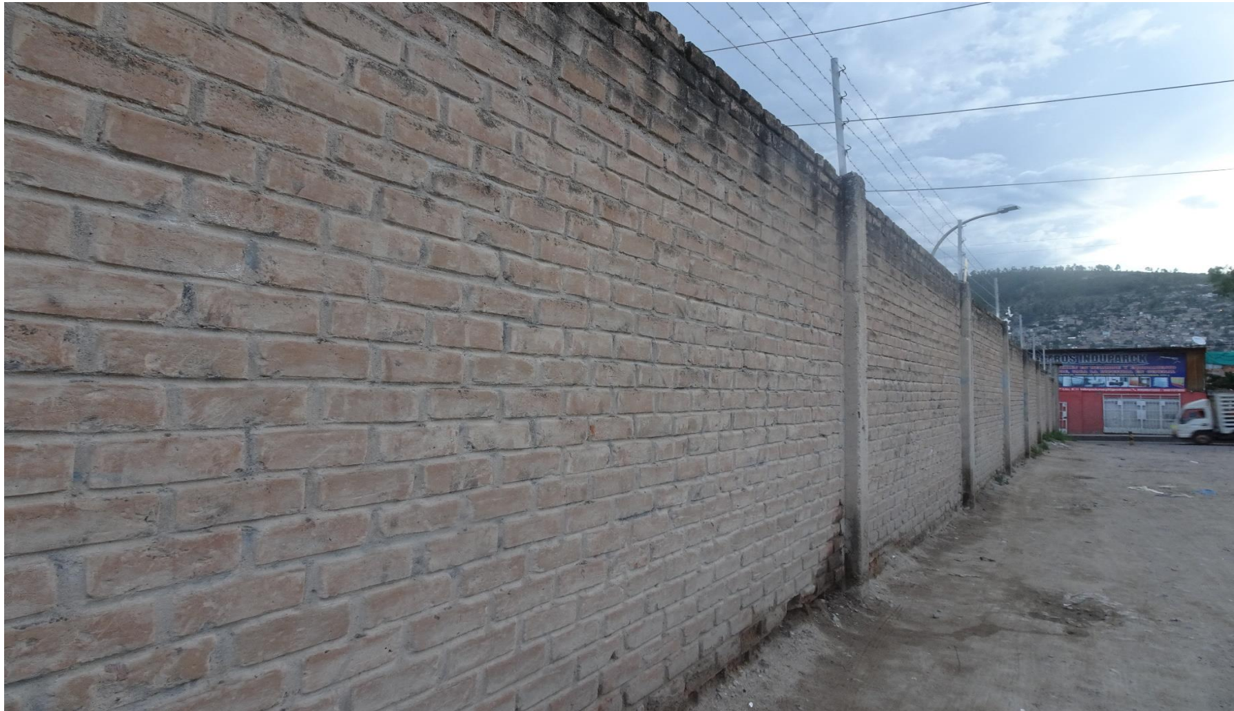
Fotografía 3: Tramo B–C del cerco perimétrico de la Empresa ELECTROCENTRO S.A. Ayacucho, ubicado en la Av. Del Deporte N° 400 - Ayacucho, provincia de Huamanga, región de Ayacucho.
