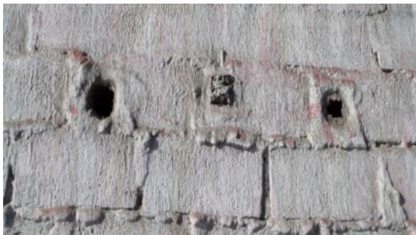
Figura 12. Erosion Mecánica Sánchez y Boldú (24)
