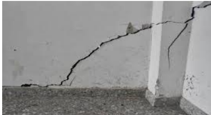
Figura 15. Grieta en Muro Nota. Fuente: Del Chiaro (31)
