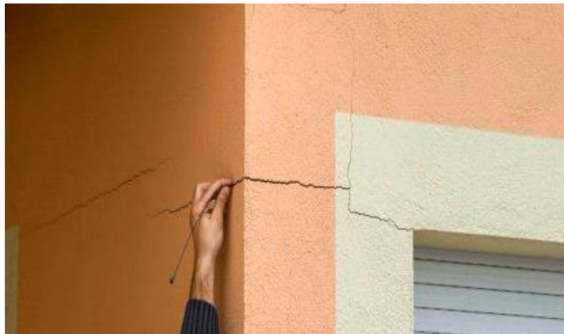
Figura 16. Fisura en revoque Nota. Fuente: Halvorsen y Poston (32)
