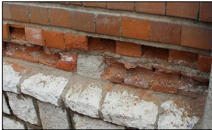
Figura 13. Erosión Química Nota. Fuente: Sánchez y Boldú (24)
