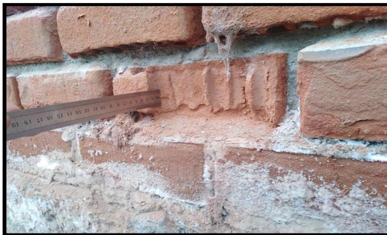
Figura 18: Erosión (Mecánico) del cerco perimétrico del almacén de cueros
