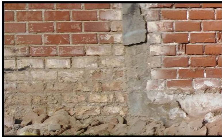
Figura 21: Erosión (Químico) del cerco perimétrico del almacén de cueros
