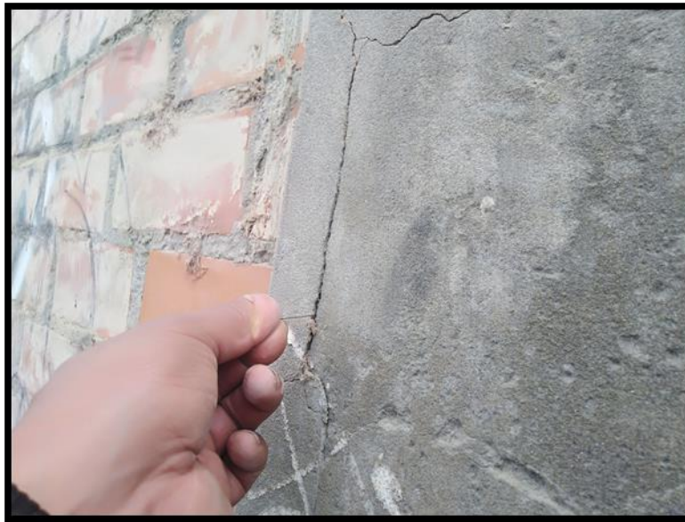
Figura 16: Fisura del cerco perimétrico del almacén de cueros
