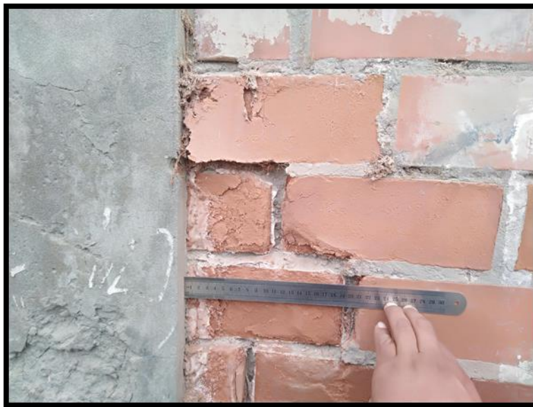
Figura 14: Erosión (Físico) del cerco perimétrico del almacén de cueros Fuente: Elaboración propia (2019)
