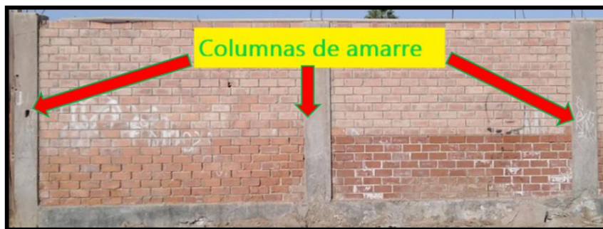
Figura 4: Columnas de Amarre Fuente: Elaboración Propia (2019)
