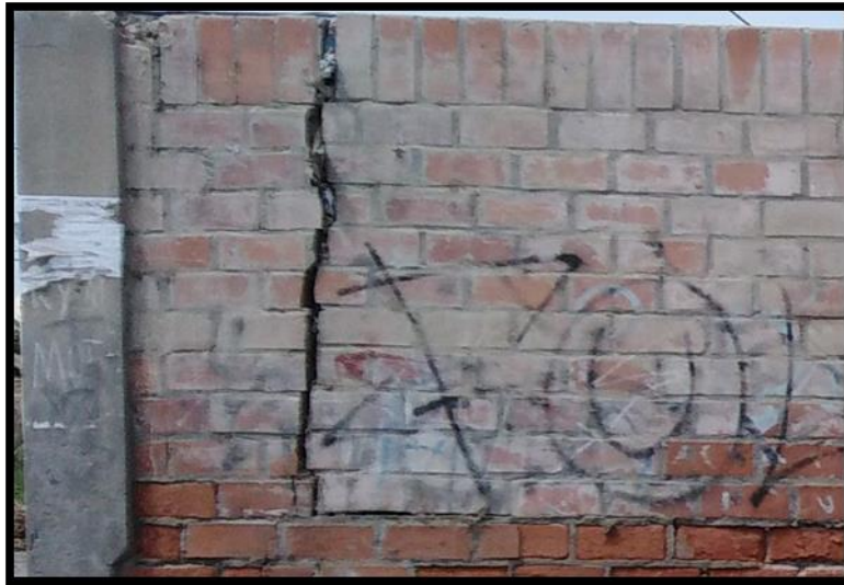
Figura 15: Grieta del cerco perimétrico del almacén de cueros Fuente: Elaboración propia (2019)
