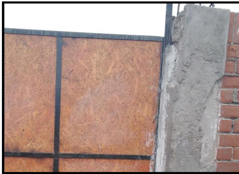
Figura 17: Desprendimiento del cerco perimétrico del almacén de cueros
