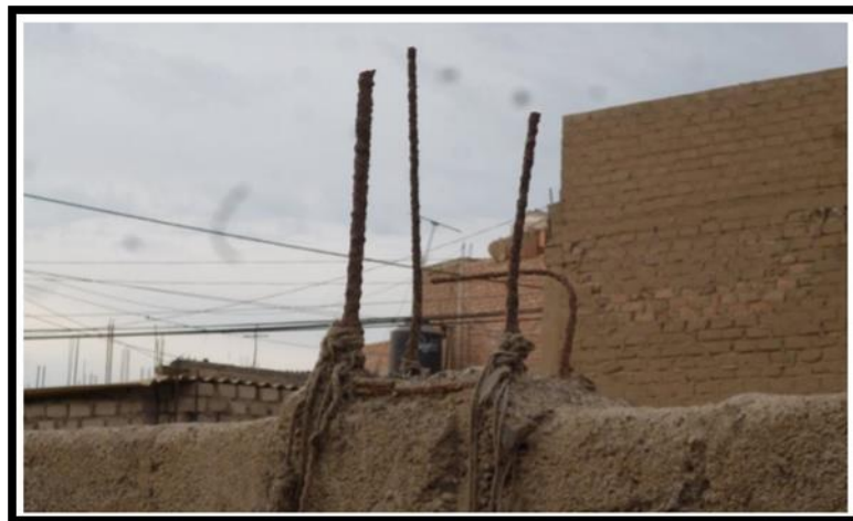
Figura 20: Acero de columna afectada por la corrosión y oxidación provocada por la falta de protección hacia los agentes ambientales
