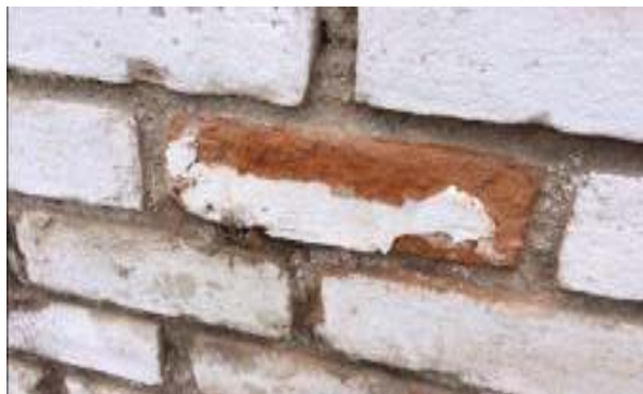
Figura 10. Disgregación del ladrillo
