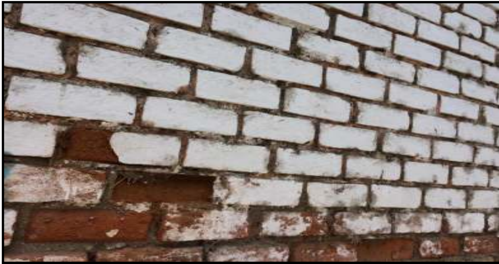
Fotografía 03: Parte exterior del cerco perimétrico en límite con Parque “La Esmeralda” (Eje 3-4) el cual presenta patologías de Disgregación.
