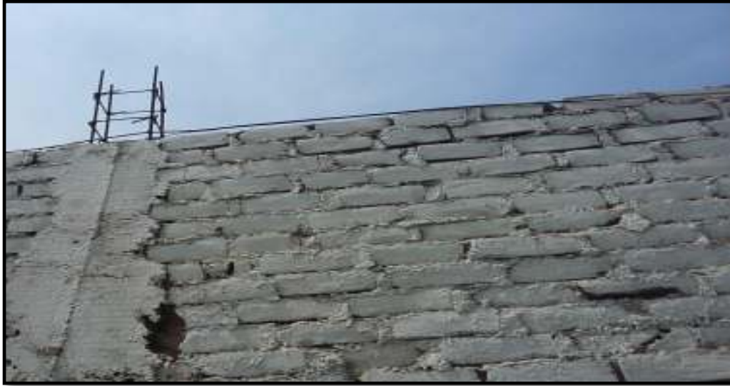
Fotografía 02: Parte exterior del cerco perimétrico en límite con Parque “La Esmeralda” (Eje 1-2) el cual presenta patologías de Corrosión en el acero Ø1/2” de la columna.
