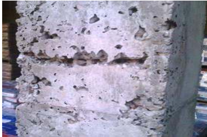
Figura 06. Patología del concreto
