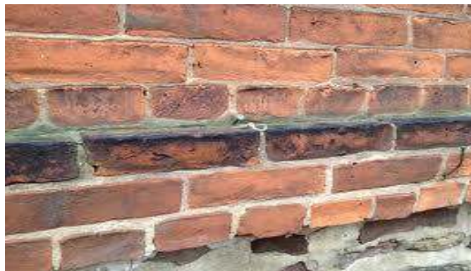
Figura 07. Patología en muro
