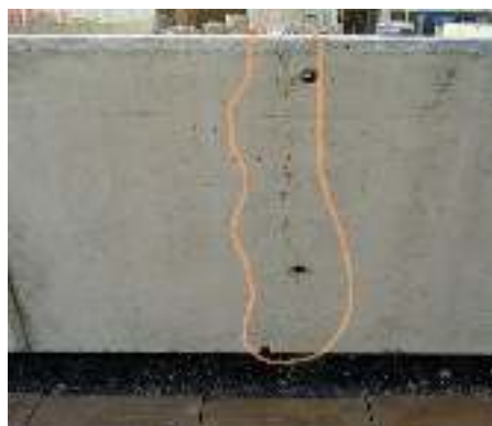
Figura 11. Fisura en concreto
