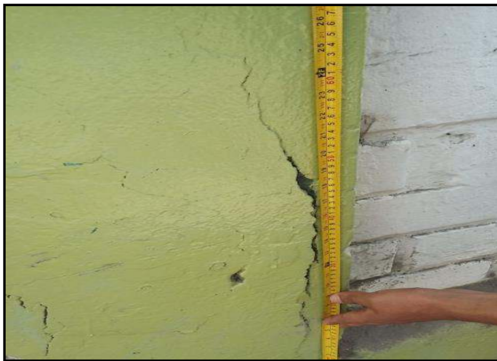
Fotografía 04: Cerco perimétrico, Jr. Daniel Hernández (Eje A-B) el cual presenta patologías de Fisuras y Grietas.
