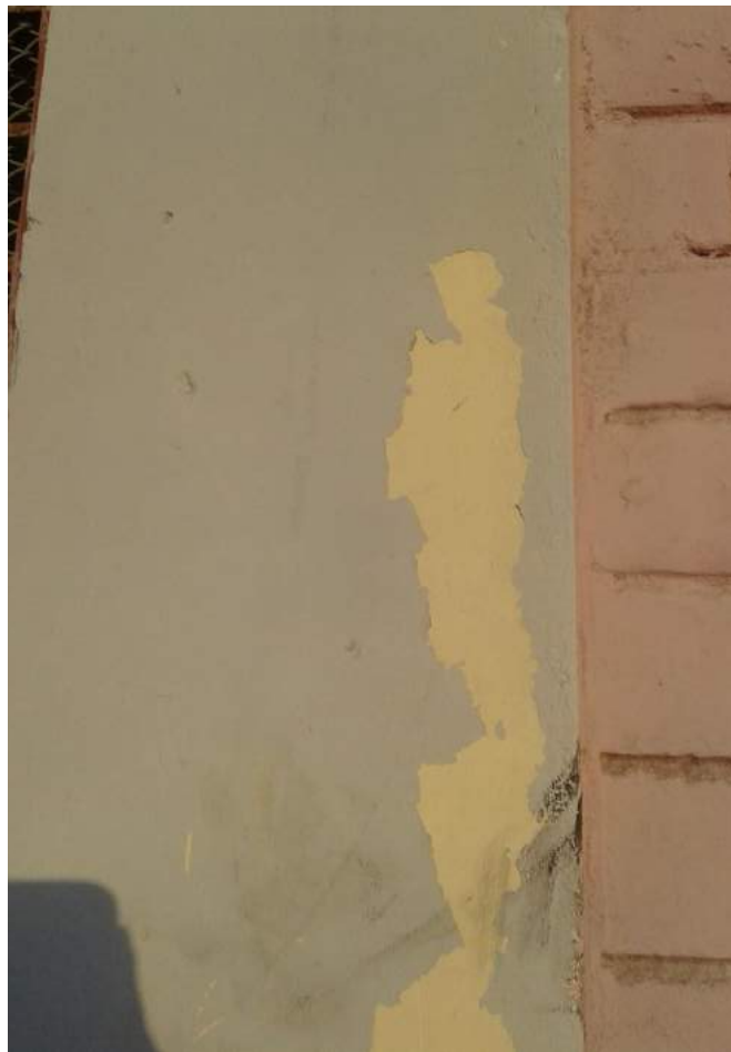
Figura 201: patología de descascaramiento
