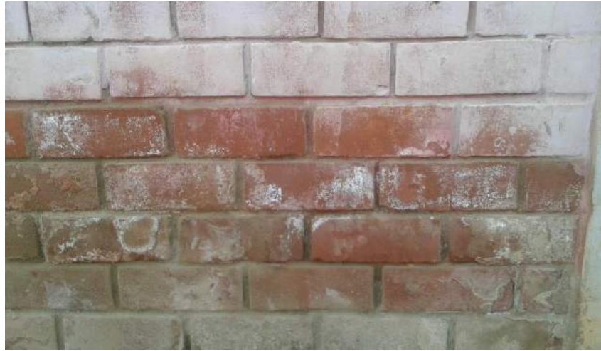
Figura 10: Imagen de eflorescencia.
