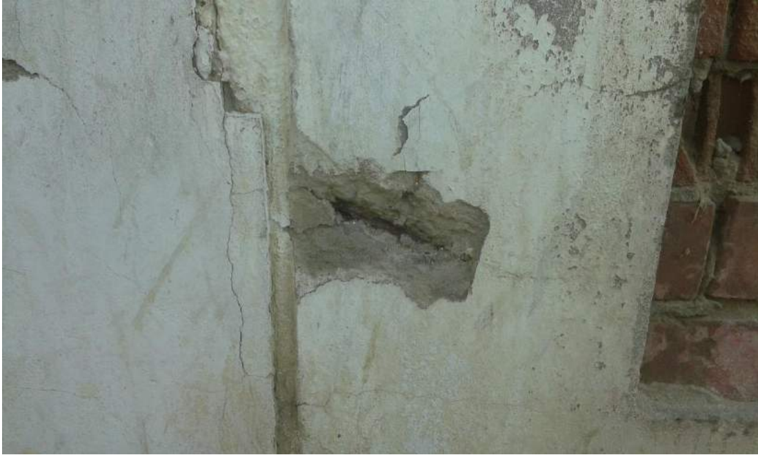
Figura 198: patología de corrosión
