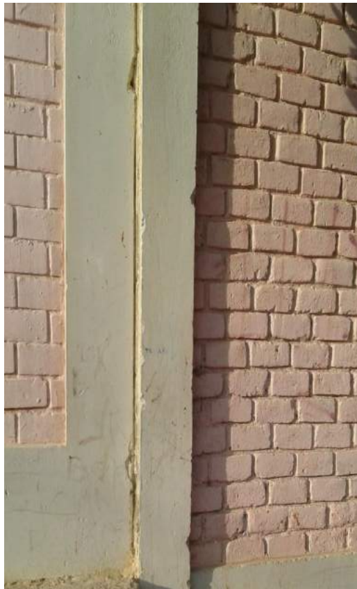
Figura 195: patología de Fisura
