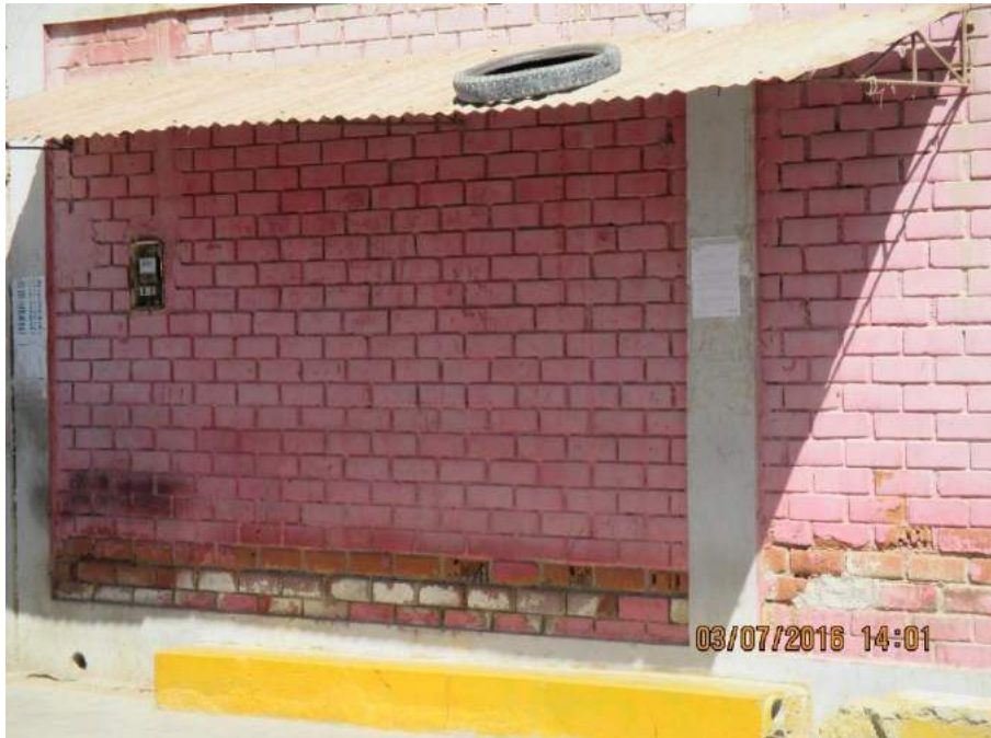
Figura 197: patología de eflorescencia
