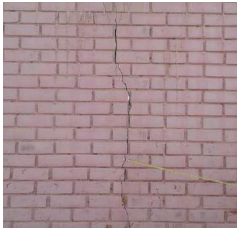
Figura 9: Imagen de grieta. Fuente: Elaboración propia.
