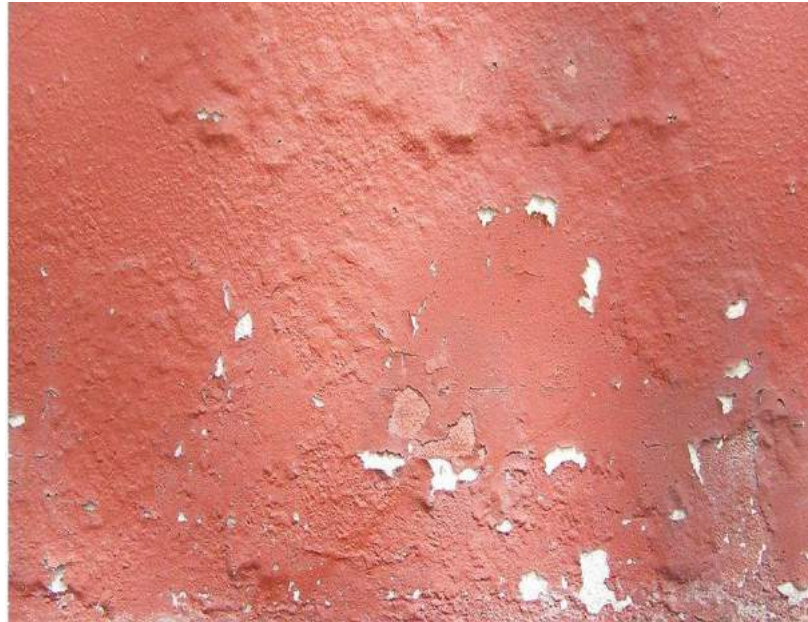
Figura 14: Imagen de descascaramiento. Fuente: Kirschbaum
