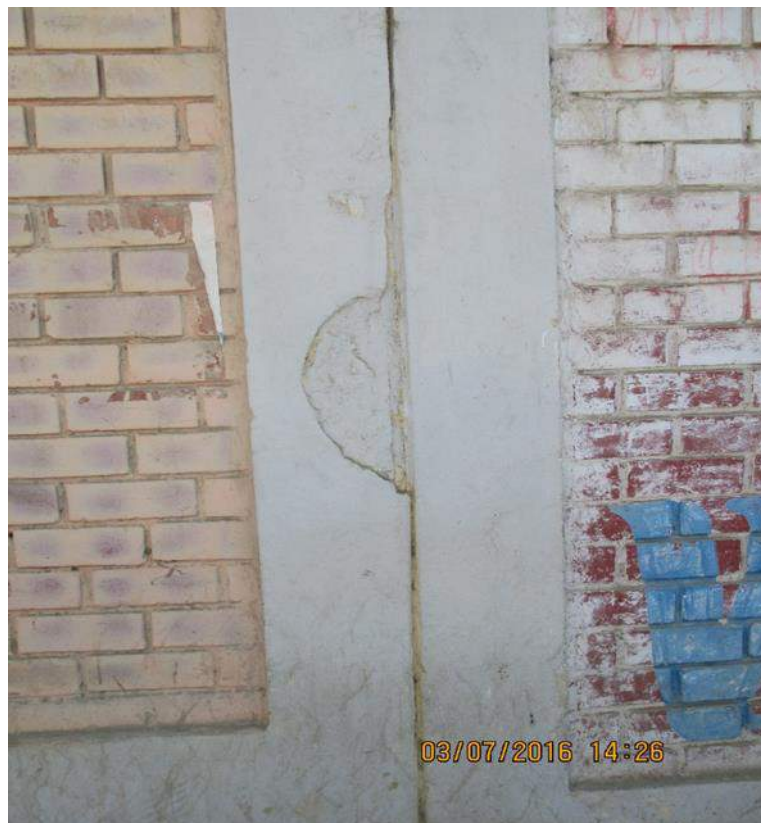
Figura 199: patología de desprendimiento
