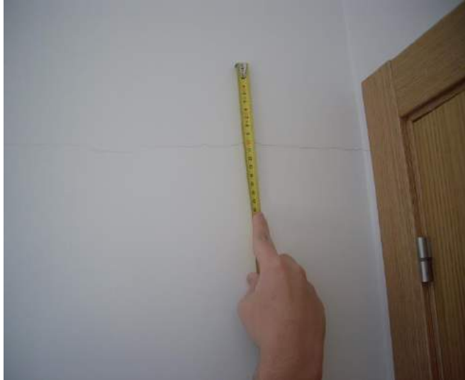
Figura 8: Imagen de fisura. Fuente: Solo arquitectura
