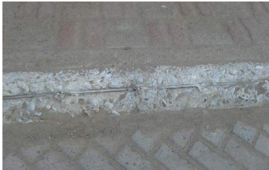
Figura 11: Imagen de corrosión. Fuente: Elaboración Propia
