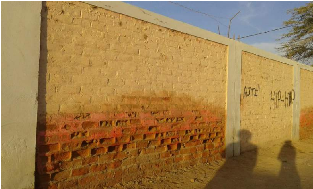
Figura 194: patología de erosión
