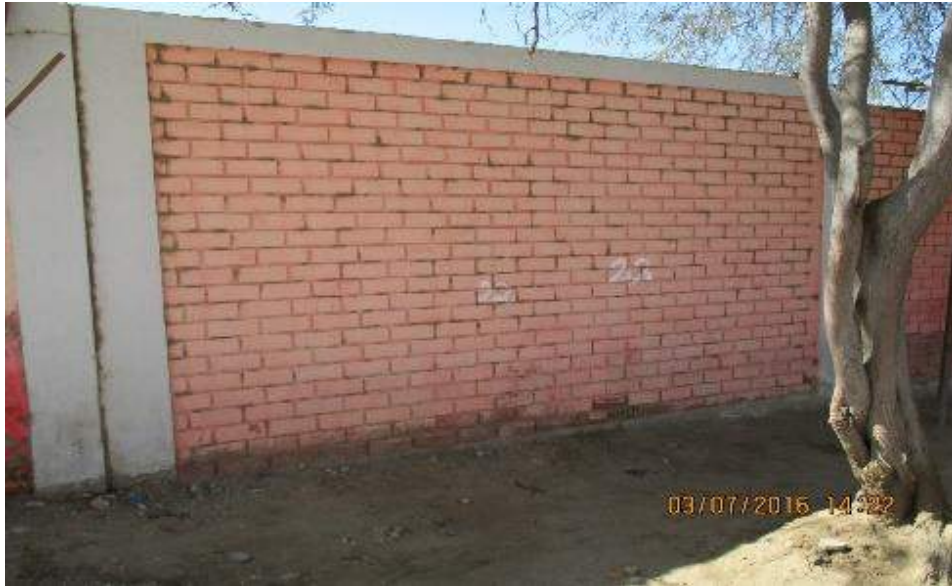
Figura 200: patología de suciedad
