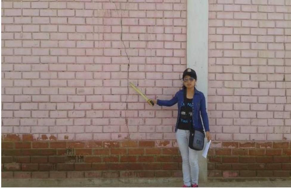
Figura 196: patología de grieta
