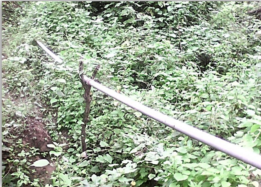
Fotografía 12. Estado actual de línea de conducción sin pase aéreo. Fuente: Elaboración propia
