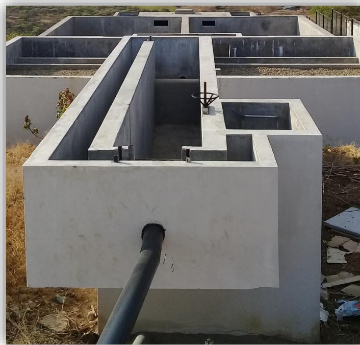
Fotografía 2. Sedimentador de planta de tratamiento. Fuente: Elaboración propia
