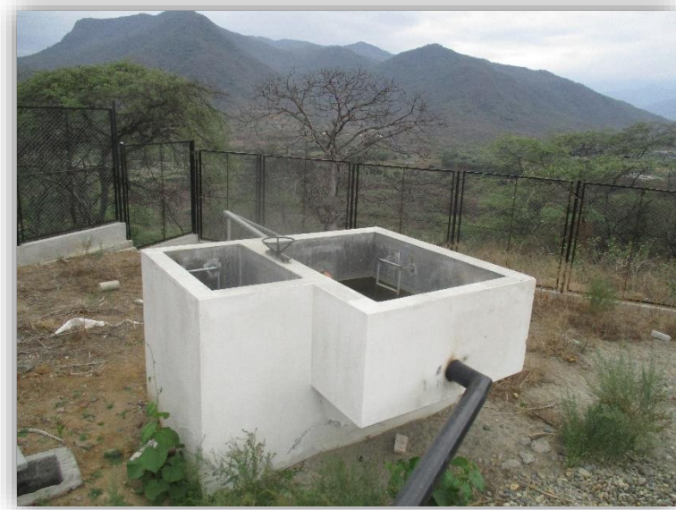
Fotografía 1. Desarenador de planta de tratamiento. Fuente: Elaboración propia
