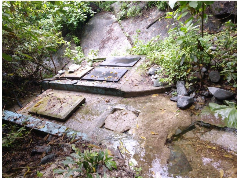
Fotografía 5 captación Actual del sistema de agua. Fuente: Elaboración propia
