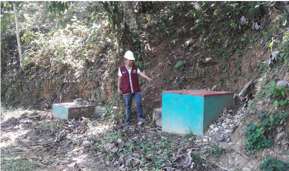
Figura 52. En esta imagen se puede observar la cámara de captación en mal estado expuesta al ingreso de las personas.
