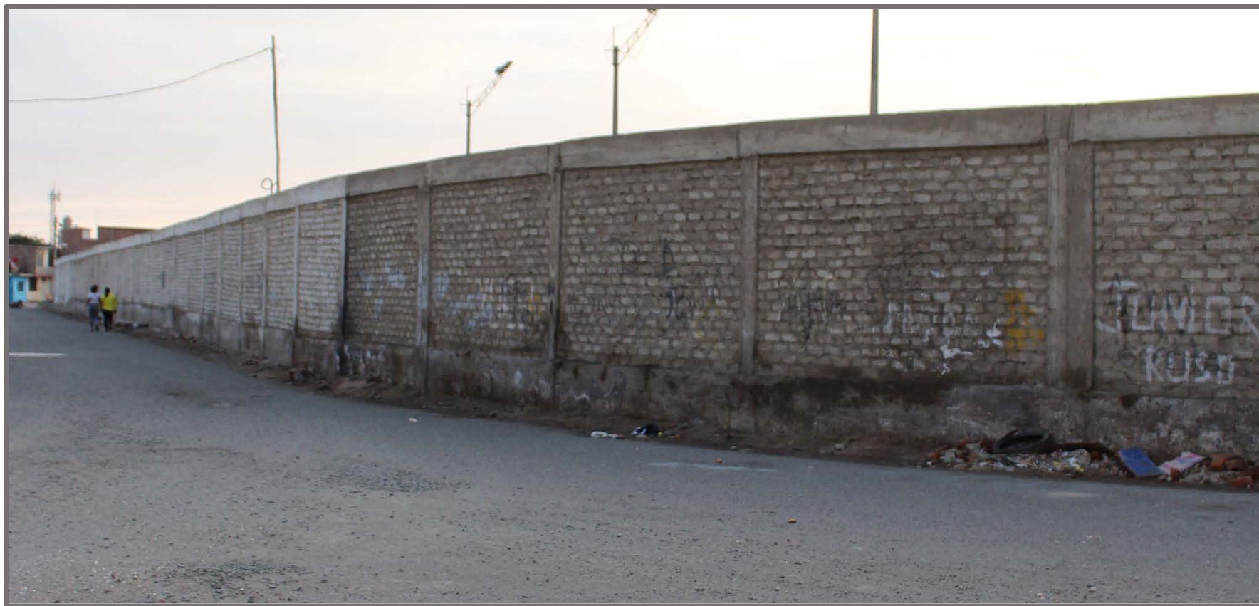
Fotografía 03: Vista del cerco perimétrico exterior eje 2-2 del cerco perimétrico del estadio municipal José Céspedes Bravo del distrito de Salaverry, provincia de Trujillo, región la Libertad.
