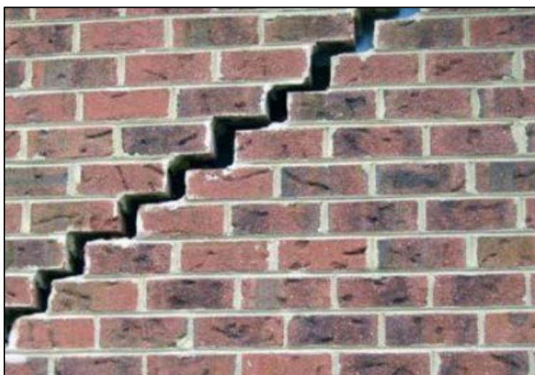
Imagen 21. Grieta en muro de albañilería
