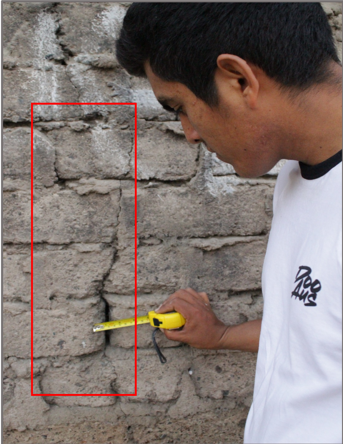
Fotografía 05: Muro afectado por grieta en la unidad muestral 17, con un ancho de 2.40 mm y un nivel de severidad alto, medida con un medidor de cinta métrica.
