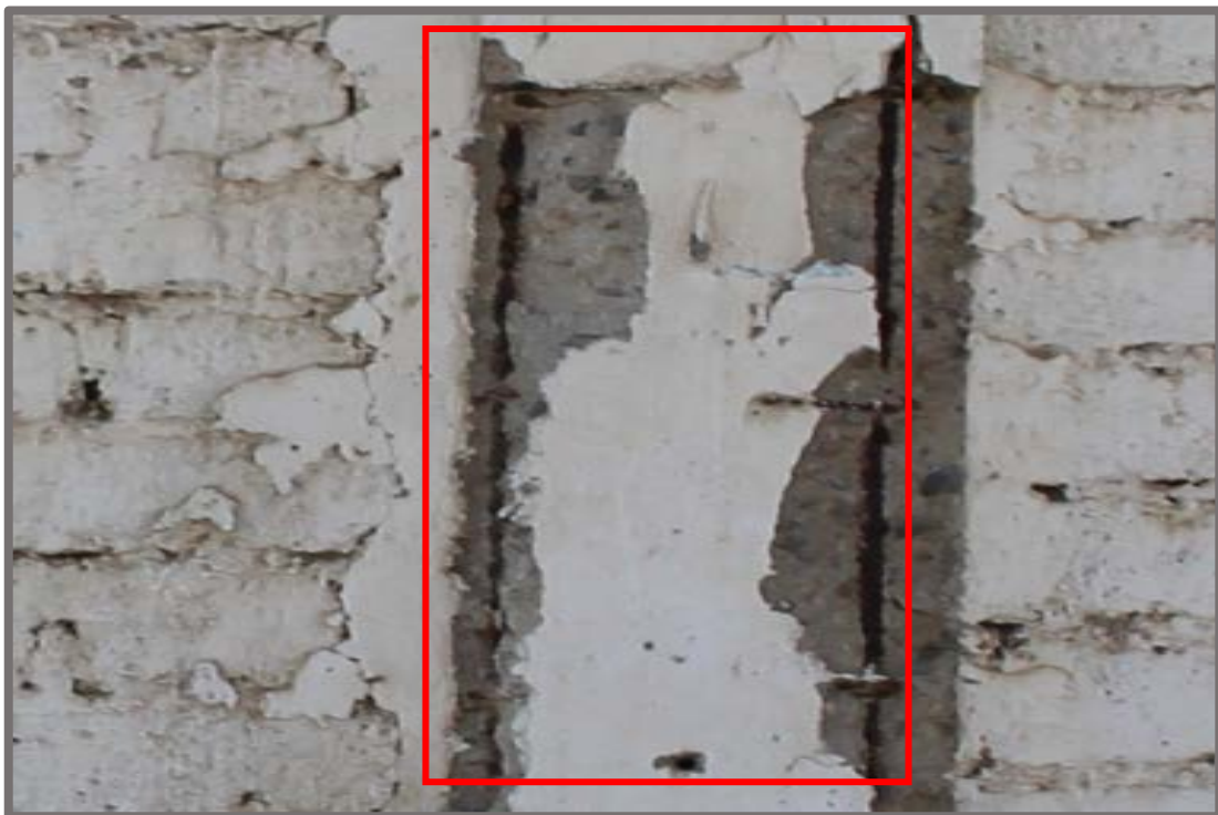
Fotografía 14: Columna afectada por corrosión en la unidad muestral 03, con un porcentaje de área afectada de 4.21% y un nivel de severidad alto.
