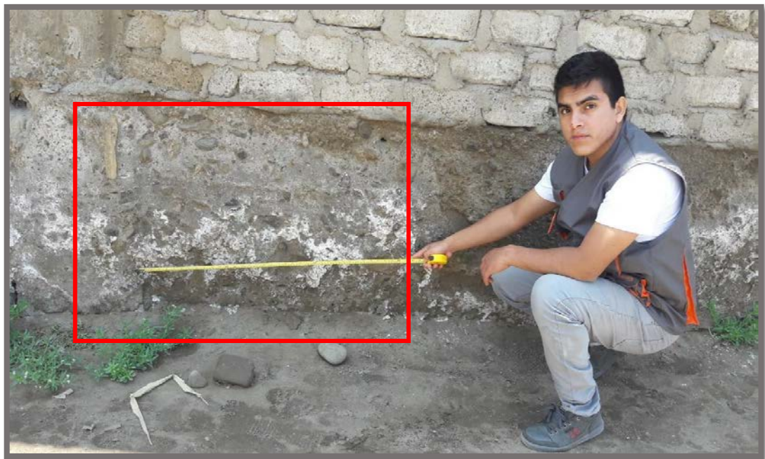
Fotografía 12: Toma de medidas de la patología eflorescencia en sobrecimiento de la unidad muestral 16.
