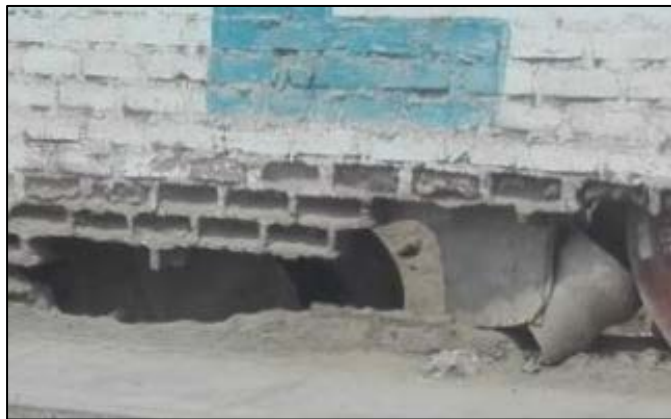
Imagen 24. Desintegración en muro de albañilería
