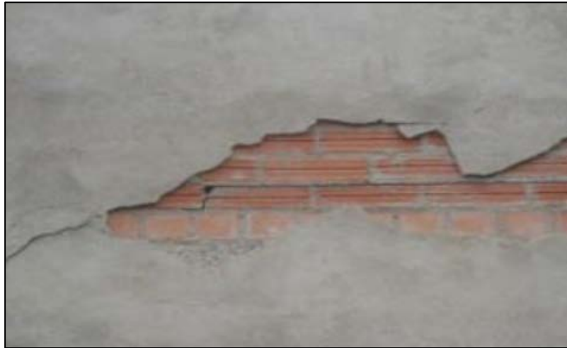
Imagen 22. Desprendimiento en muro de albañilería
