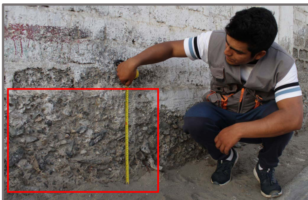
Fotografía 10: Sobrecimiento afectado por erosión en la unidad muestral 02, con un área afectada de 17.97% y un nivel de severidad Bajo.
