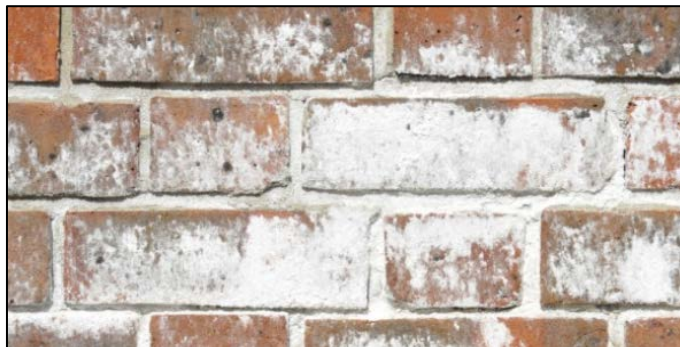
Imagen 17. Eflorescencia en muro de albañilería
