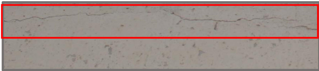
Fotografía 18: Viga afectada por fisura en la unidad muestral 34, con un ancho de 0.15 mm y un nivel de severidad bajo.
