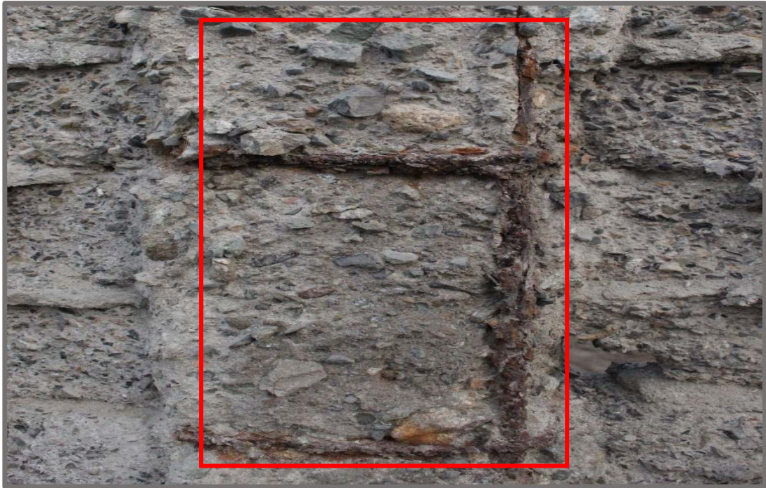
Fotografía 13: Columna afectada por corrosión en la unidad muestral 02, con un porcentaje de área afectada de 6.80% y un nivel de severidad alto.
