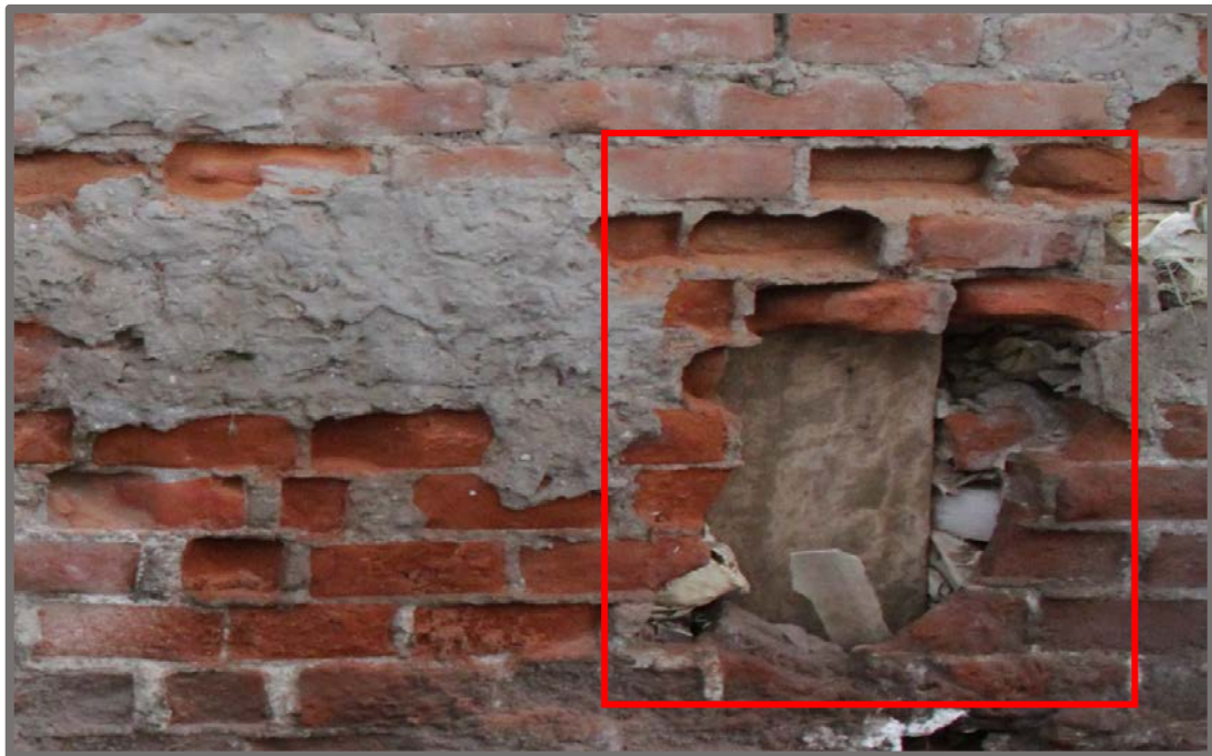
Fotografía 08: Muro afectado por desintegración en la unidad muestral 20, con un porcentaje de área afectada de 31.47% y un nivel de severidad bajo.
