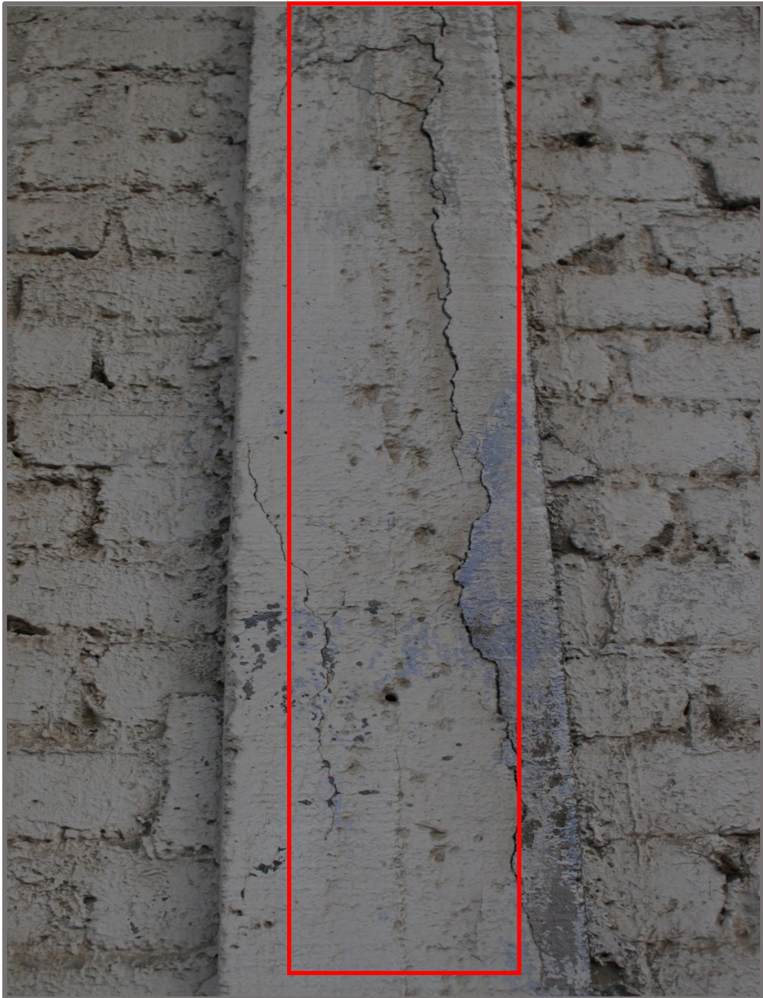
Fotografía 06: Muro afectado por grieta en la unidad muestral 11, con un ancho de 2.30 mm y un nivel de severidad alto, medida con un medidor de cinta métrica.
