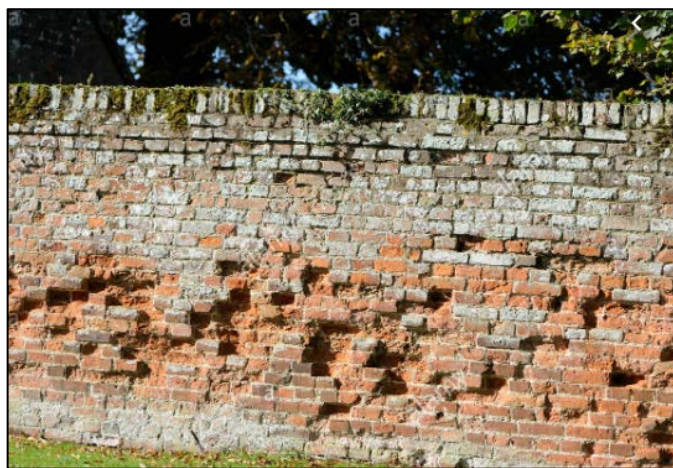
Imagen 19. Erosión en muro de albañilería
