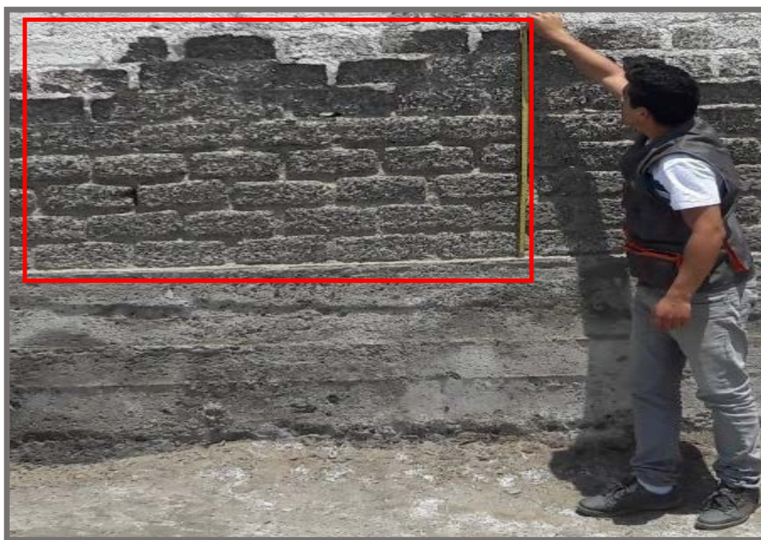
Fotografía 09: Muro afectado por erosión en la unidad muestral 01, con un área afectada de 12.93% y un nivel de severidad Alto.
