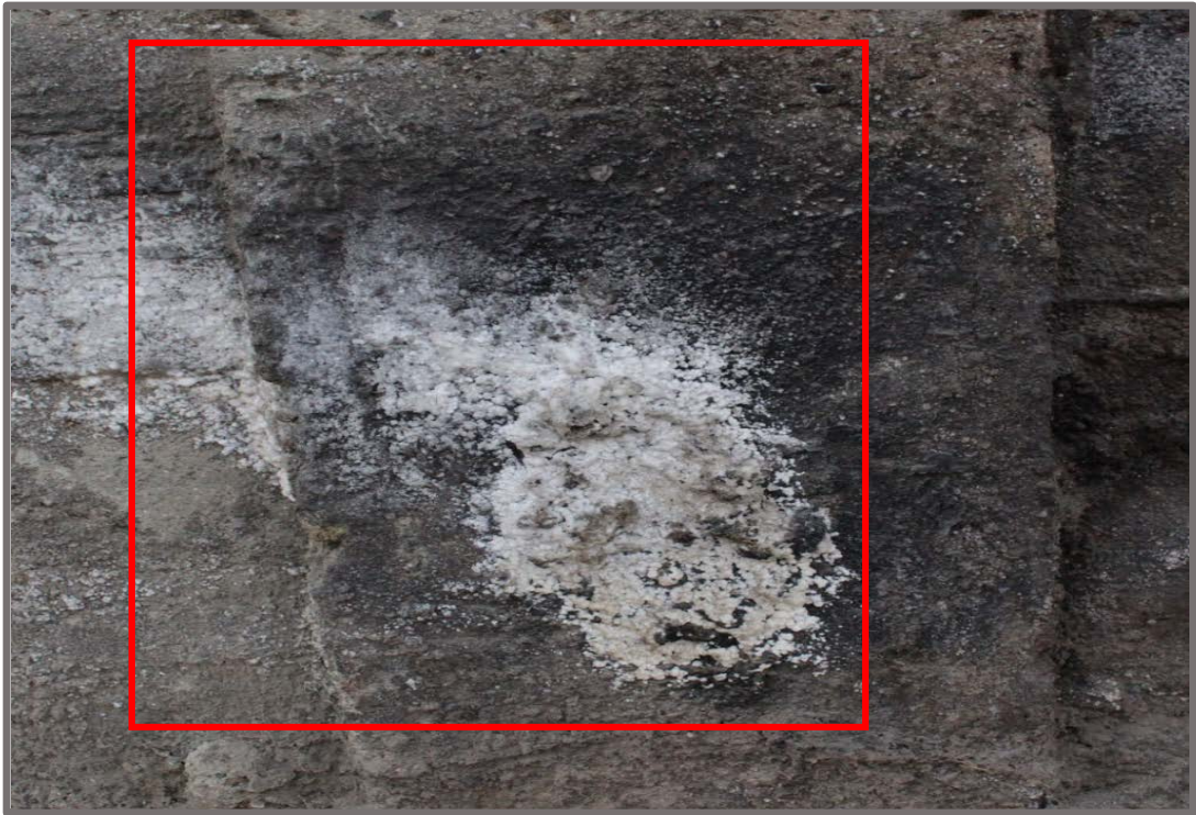
Fotografía 11: Columna afectada por eflorescencia en la unidad muestral 17.
