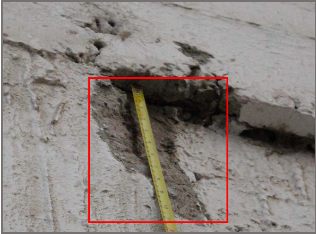
Fotografía 07: Columna afectada por desintegración en la unidad muestral 26, con un porcentaje de área afectada de 0.24% y un nivel de severidad bajo.
