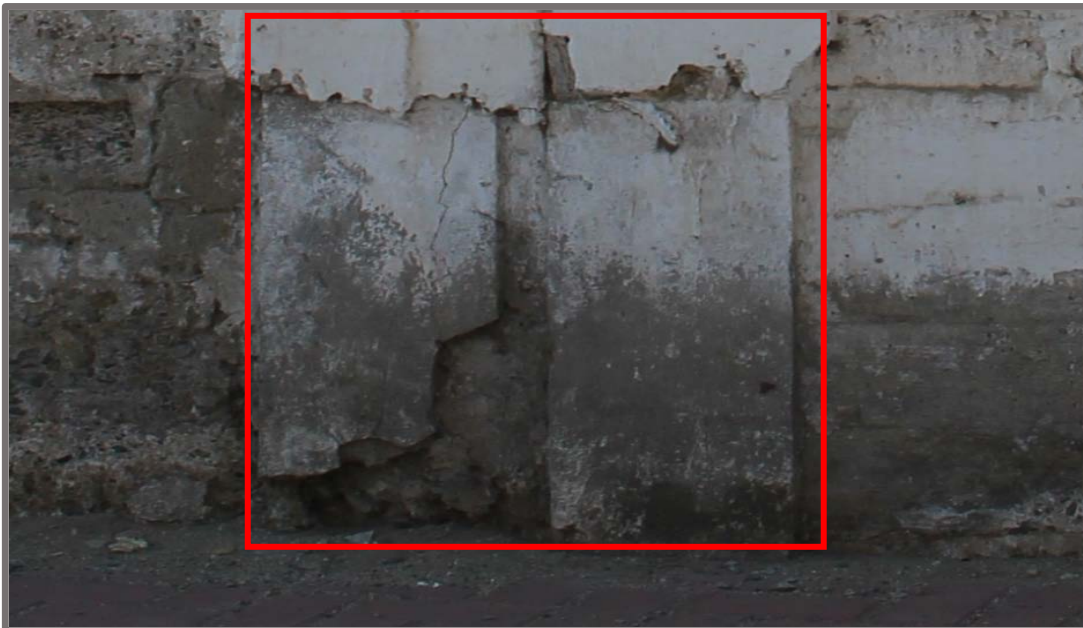
Fotografía 16: Columna afectada por desprendimiento en la unidad muestral 29, con un área afectada de 50.58% y un nivel de severidad medio.
