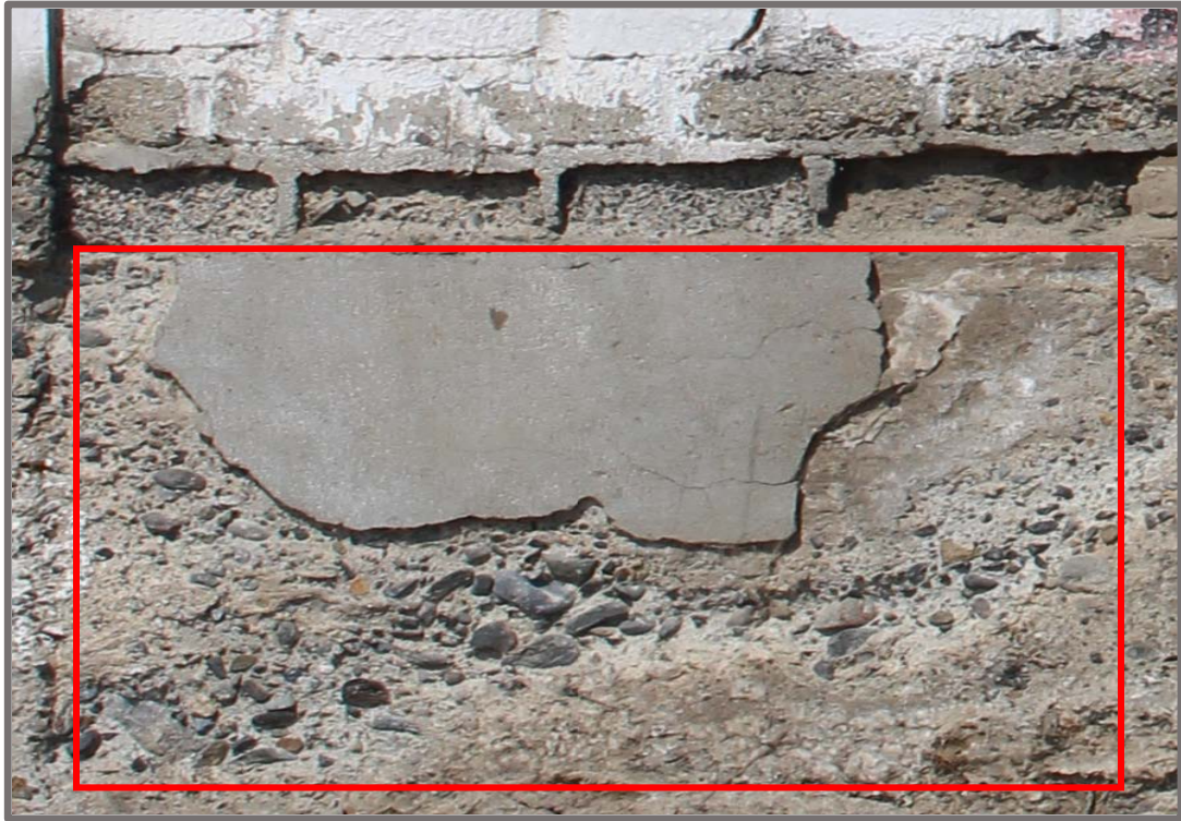
Fotografía 15: Sobrecimiento afectado por desprendimiento en la unidad muestral 03, con un área afectada de 13.64% y un nivel de severidad medio.
