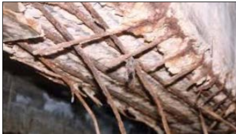
Imagen 18. Corrosión del acero de refuerzo
