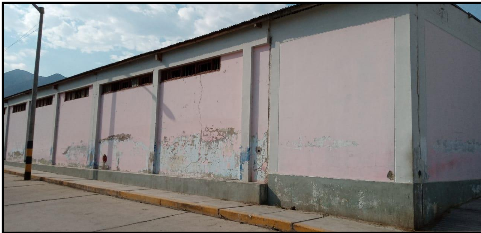
Fotografía 03. Vista panorámica del cerco de la institución educativa 88050, ubicado en la Jirón Francisco Bolognesi.
