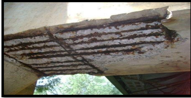
Gráfico 15: Presencia de corrosión del acero en viga. Nota. Fuente: Marco (2013).
