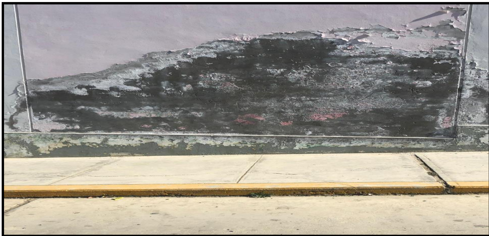
Fotografía 04. Muro, sobrecimiento y columna afectados por la patología eflorescencia – Unidad muestral 02.
