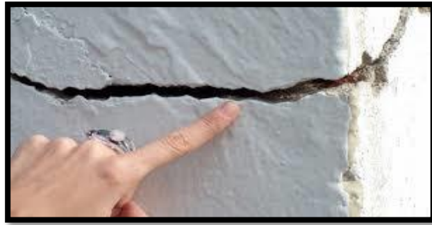
Gráfico 10: Presencia de grieta en columna Nota. Fuente: Umacon (2019).
