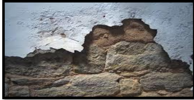
Gráfico 12: Desprendimiento en sobrecimiento Nota. Fuente: Clarín (2019).
