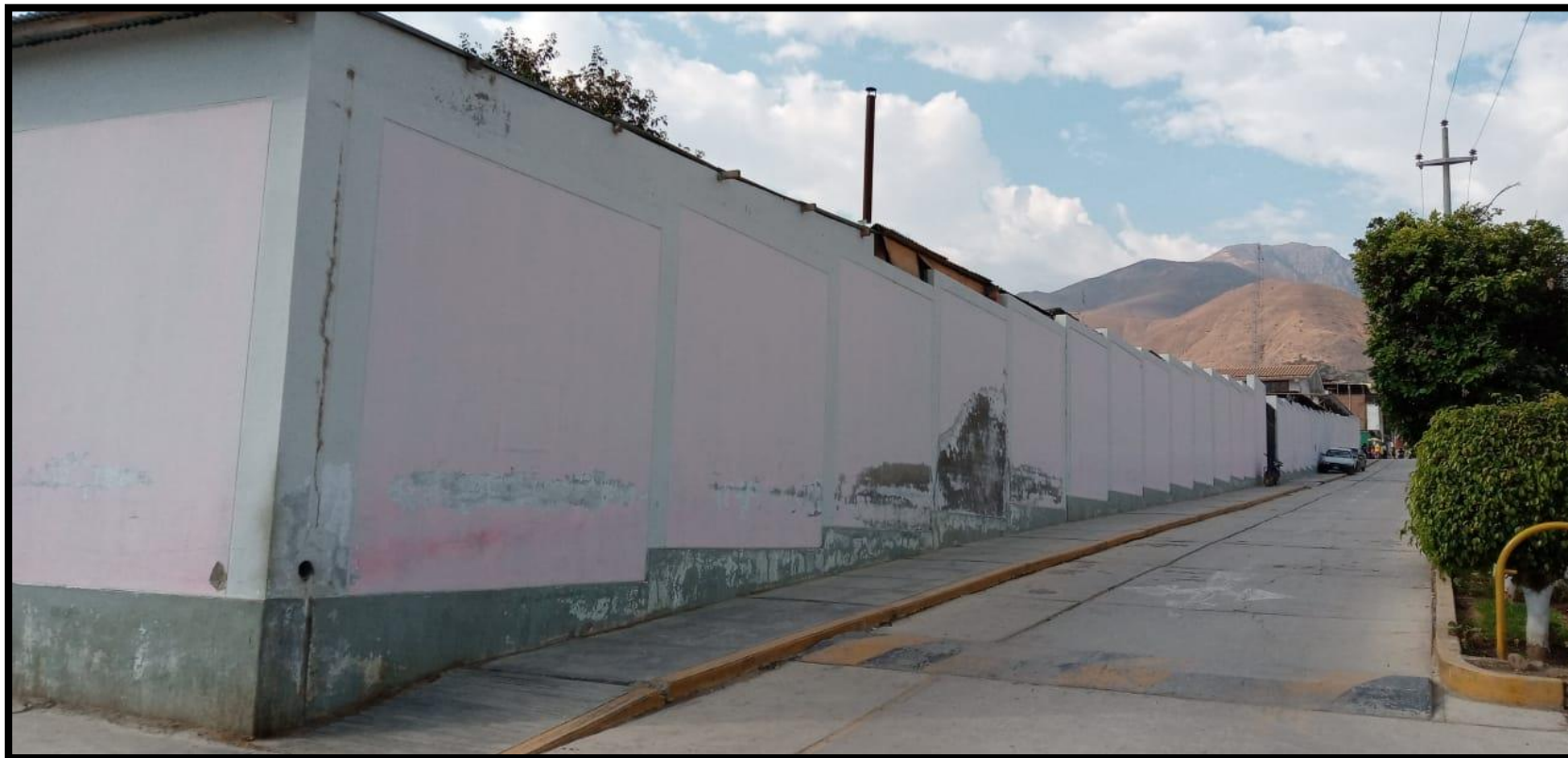
Fotografía 01. Vista panorámica del cerco de la institución educativa 88050, ubicado en la avenida Ramón Castilla
