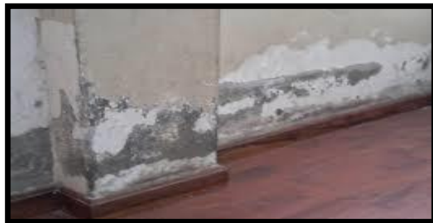
Gráfico 14: Eflorescencia en columna Nota. Fuente: Marco (2013).
