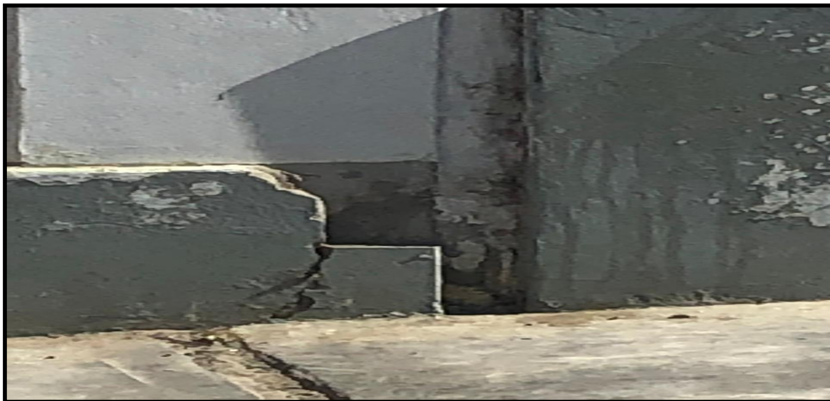
Fotografía 07. Presencia de desprendimiento en sobrecimiento – Unidad muestral 09.
