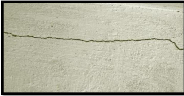
Gráfico 11: Presencia de fisura en muro de albañilería Nota. Fuente: Umacon (2019).
