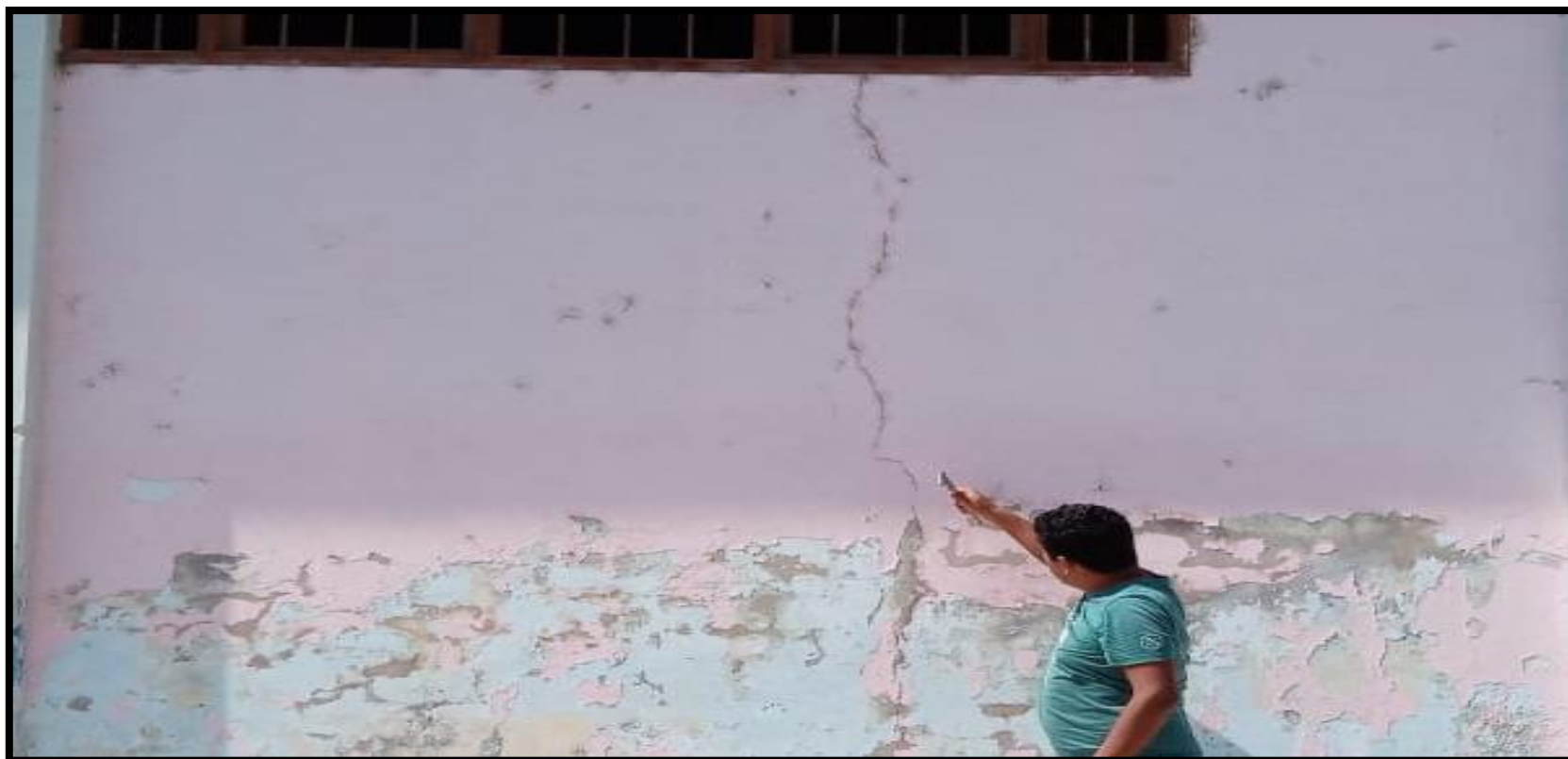
Fotografía 05. Presencia de Grieta – Unidad muestral 28.
