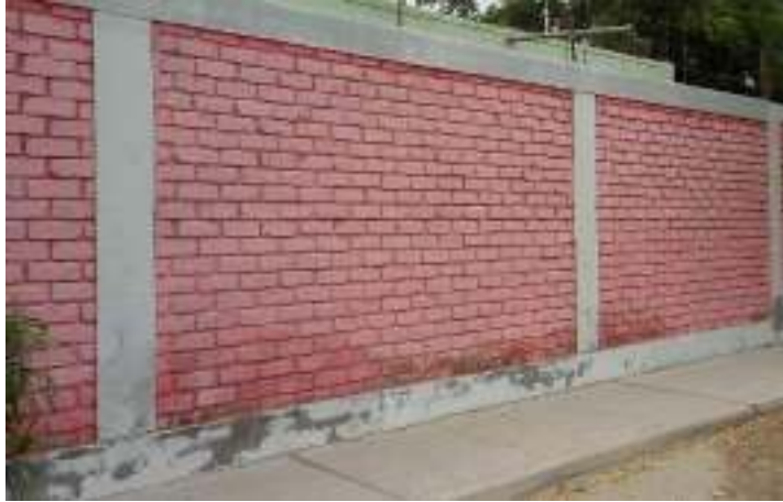
Grafico 5: Humedad en muro.
