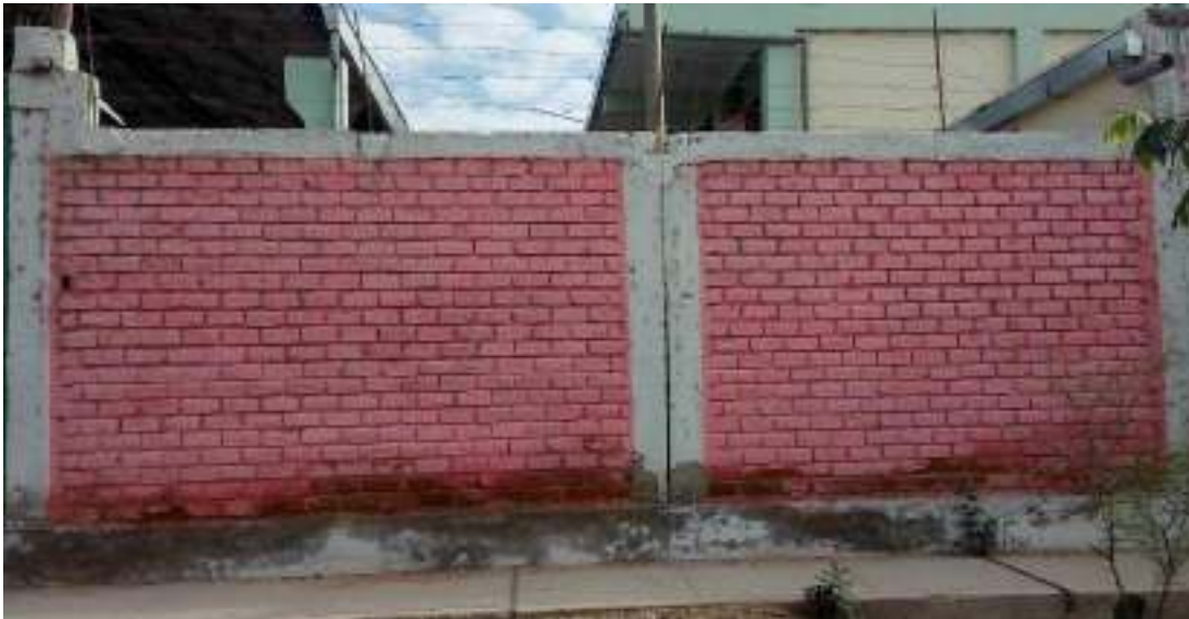
Presencia de erosión y humedad en la unidad de muestra 02.
