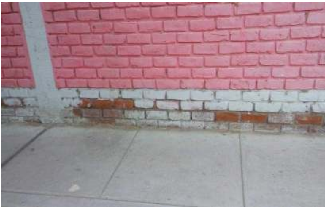
Fotografía de patología de la erosión presente en el muro.
