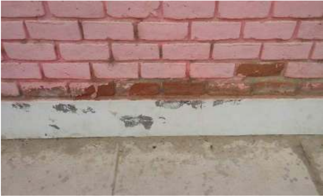
Fotografía de erosión presente en el muro.
