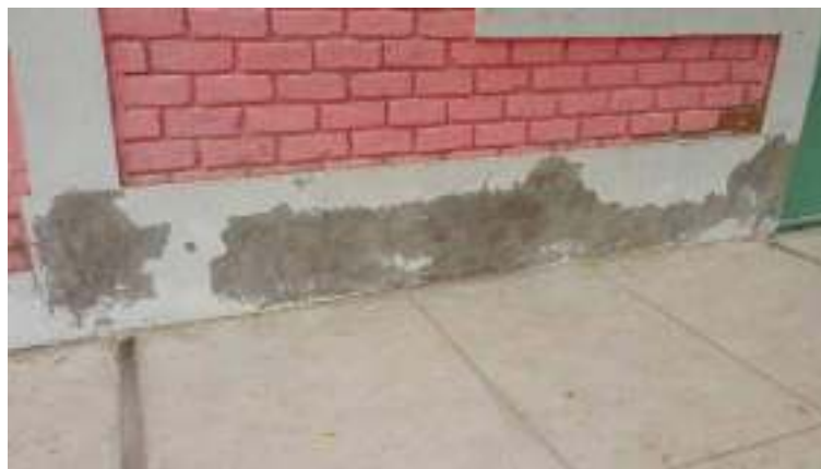
Grafico 4: Eflorescencia en muro de ladrillo.
