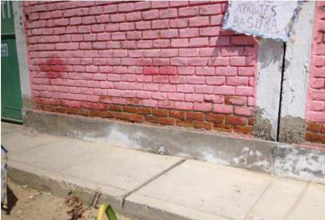
Fotografía de patología de la humedad presente en el muro.
