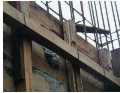
Fallas en encofrados.
