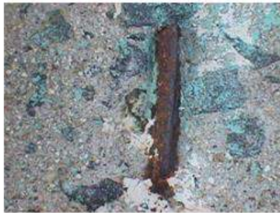
Oxidación de armaduras.
