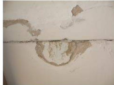
Falla de junta de dilatación.
