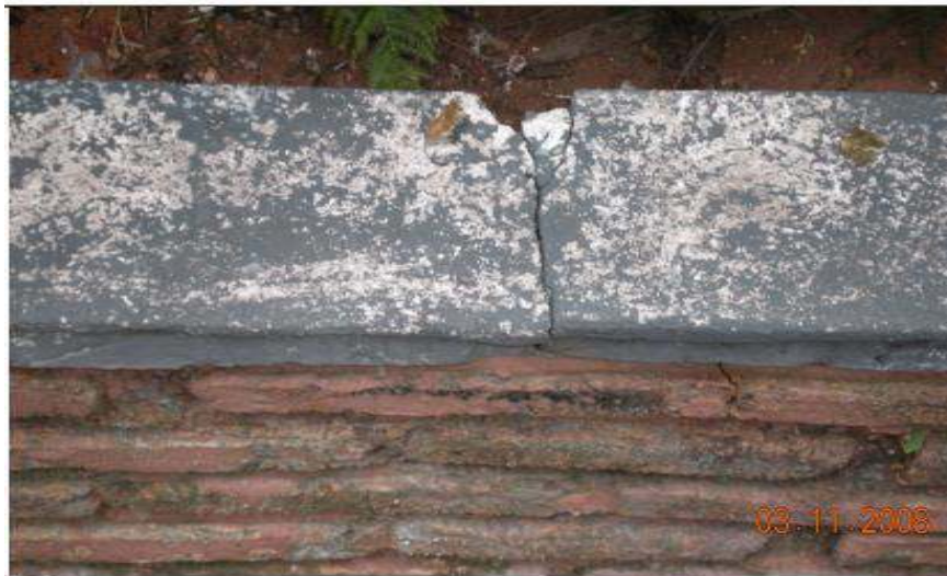
Figura 1: Fisura en muro de albañilería
