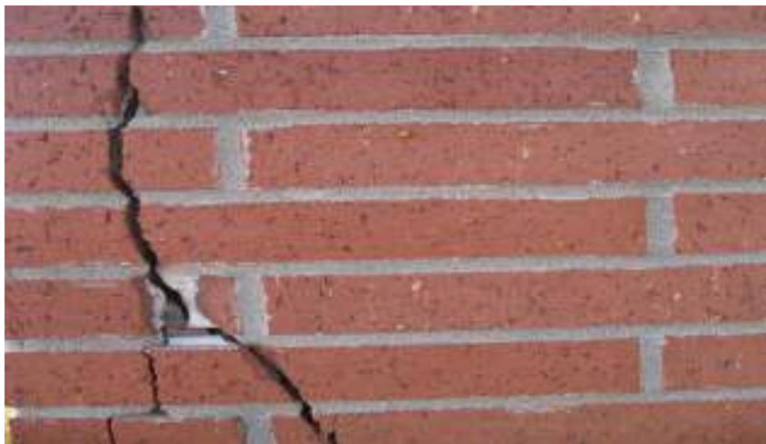
Figura 2: Grieta en muro de Albañilería.
