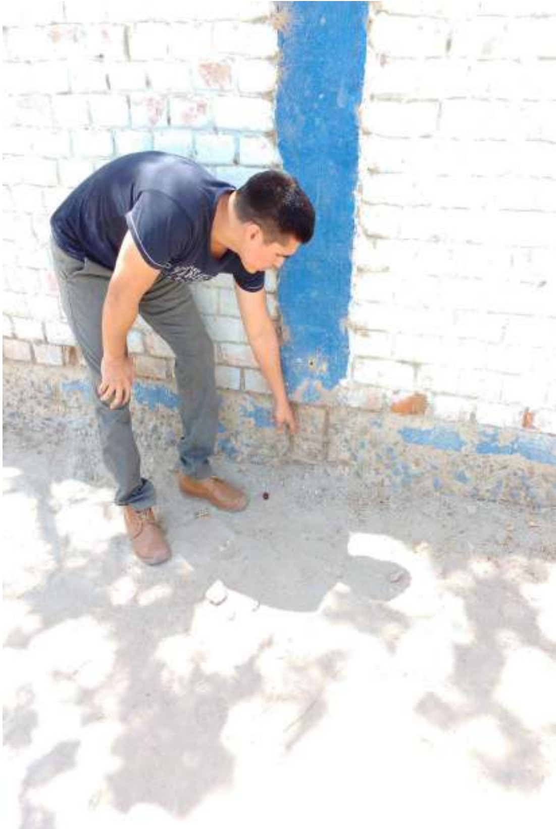
Figura 172: Fotografía donde se identifica la patología corrosión
