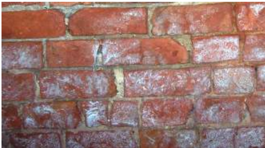
Figura 7: Eflorescencia en muro de albañilería
