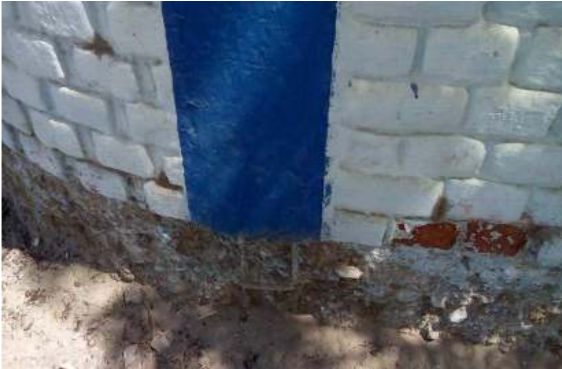
Figura 176: Oxidación del acero
