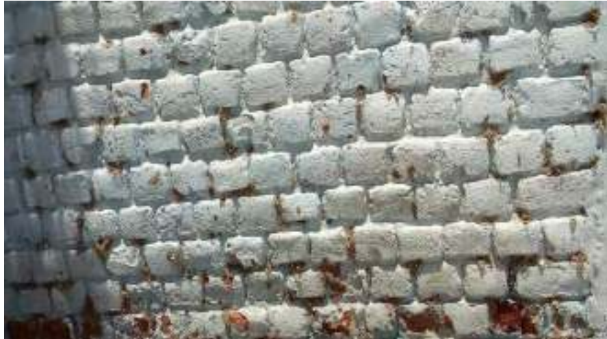
Figura 9: humedad en muro.
