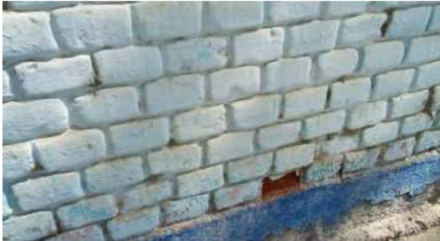
Figura 5: Picadura en muro de albañilería
