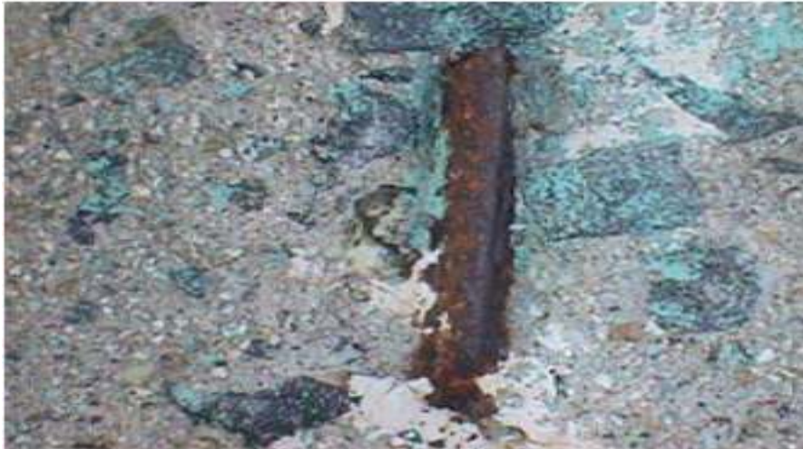
Figura 6: Oxidación en acero
