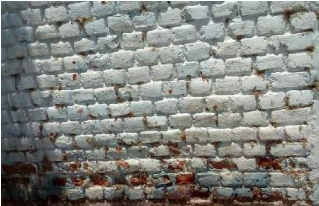
Cuadro 27: Causas y soluciones de la patología humedad
