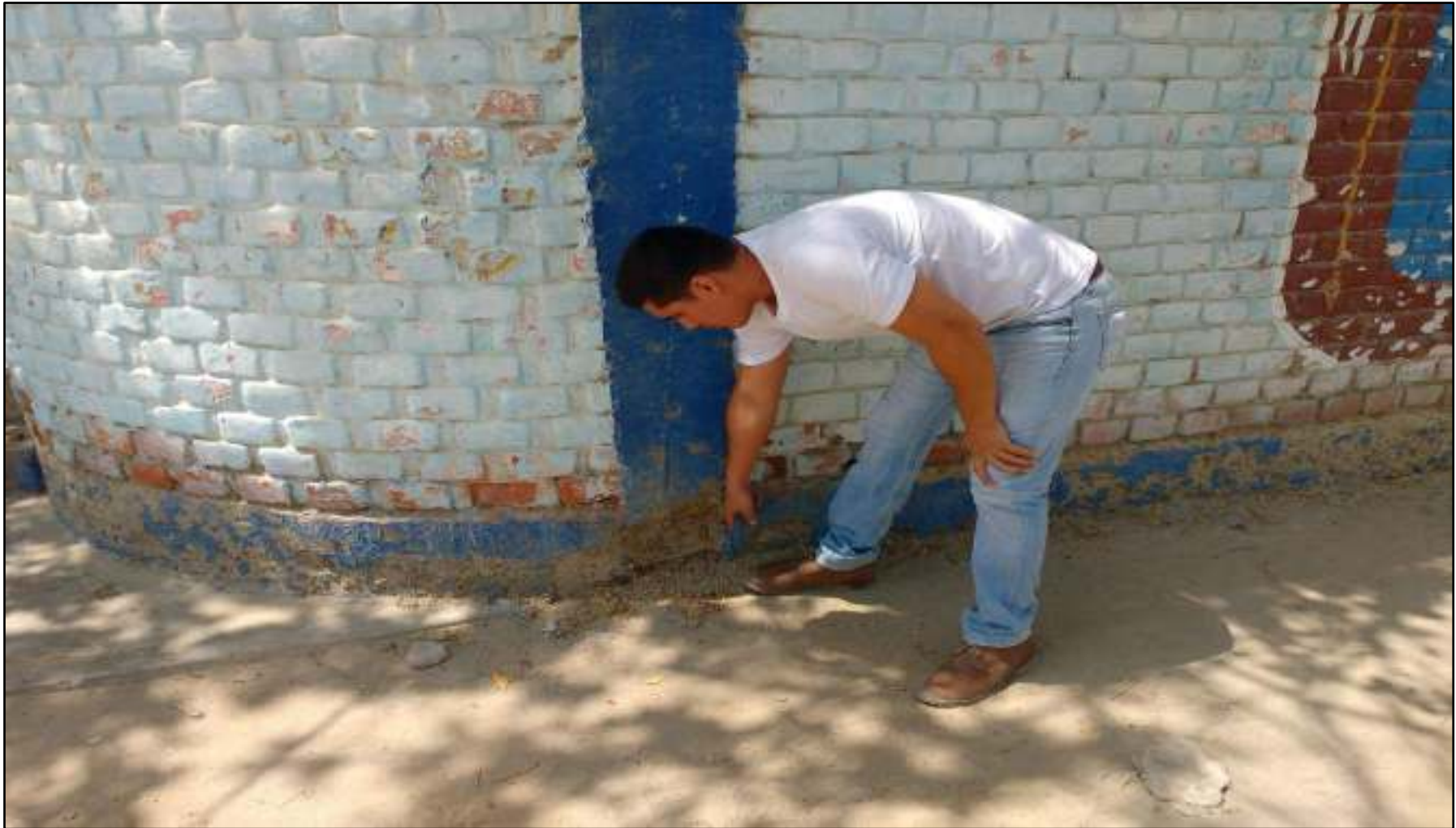
Figura 169: Fotografía donde se identifica la patología de erosión y oxidación
