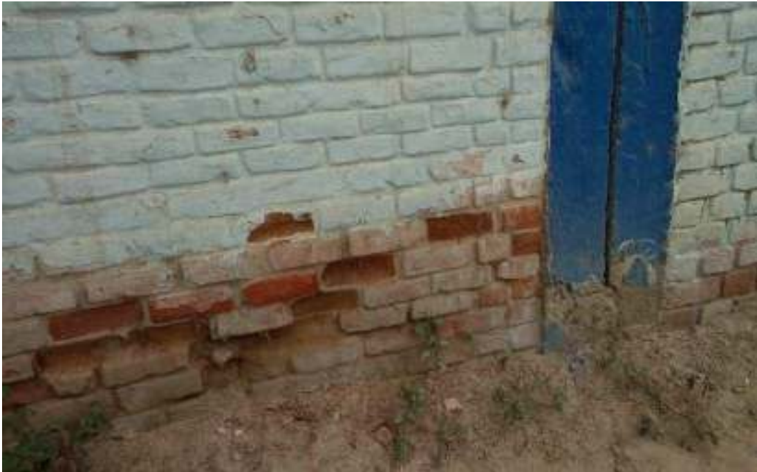
Figura 173: Erosión en muro y columna
