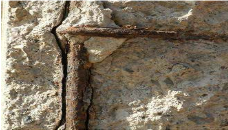
Figura 8: Corrosión en columna
