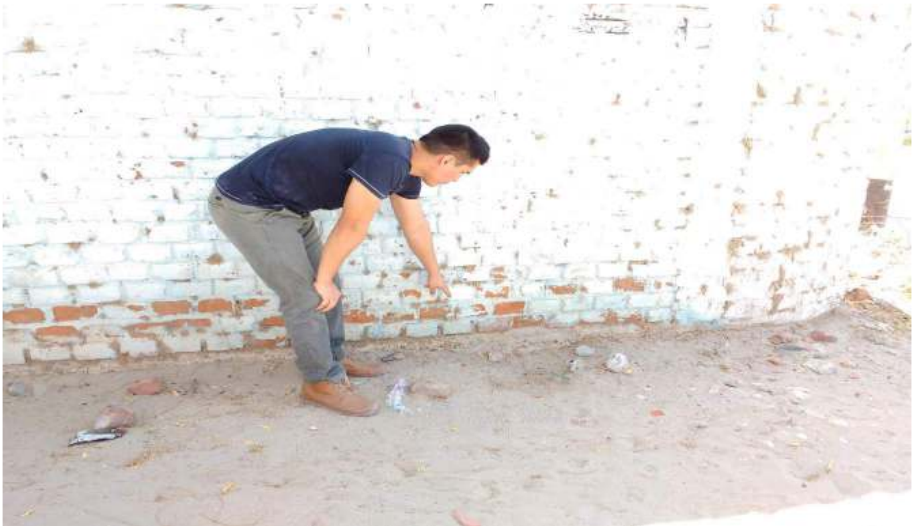
Figura 171: Fotografía donde se identifica la patología erosión derivada de la humedad.
