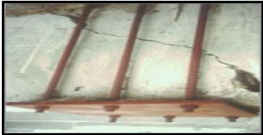
Figura 15 grietas en losa de concreto. Fuente. Revista Ingeniería de la construcción.
