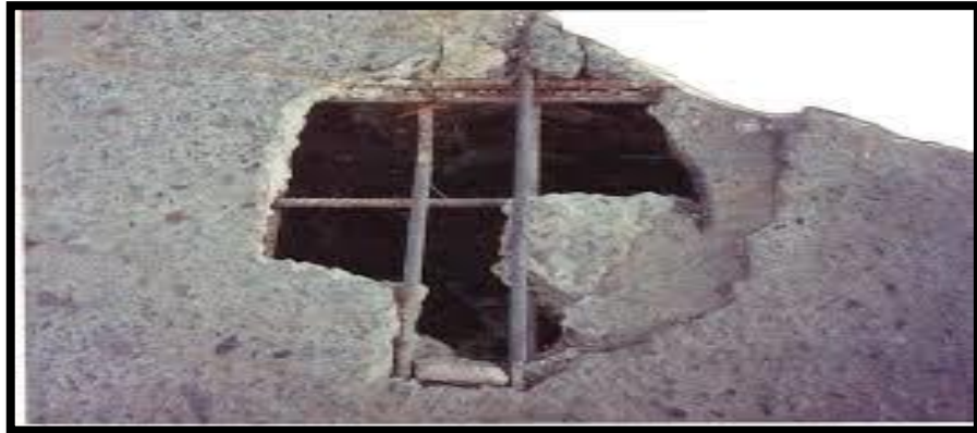
Figura 17 Fallas en puente. Fuente. Huanca A
