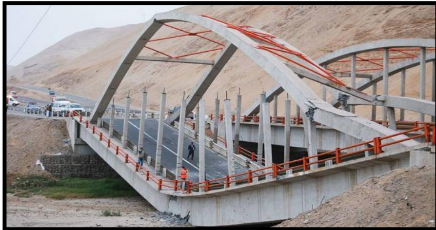
Figura 14. Deformaciones en Puentes. ESTUDIOSASSANI ingeniería estructural. Ing. Sheila C.S.S 7 .
