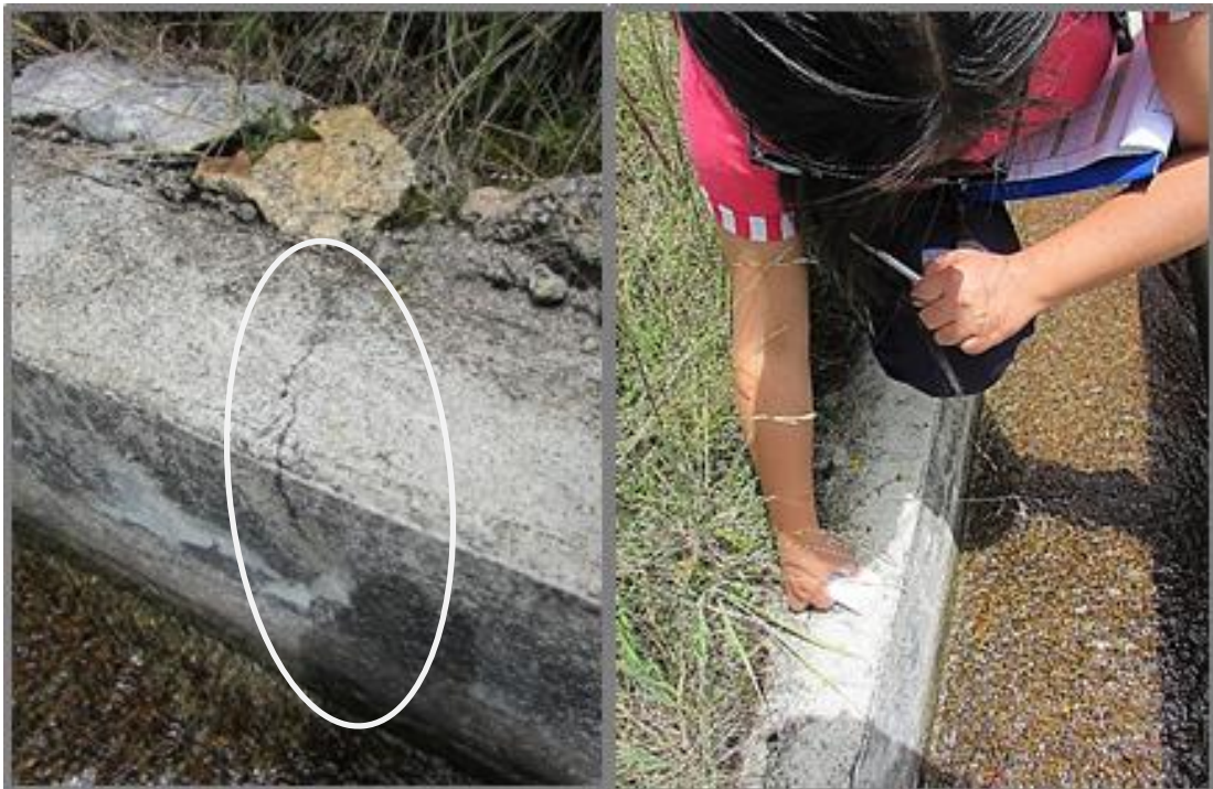
Fotografía 12. Medida de la abertura de la fisura ubicada en el margen izquierdo de la UM 20
