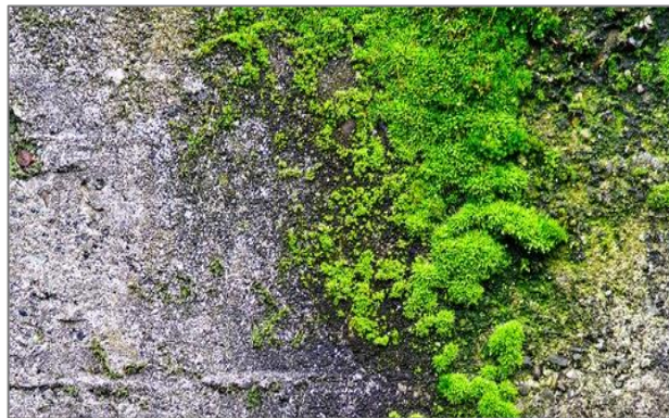
Figura 7. Musgo en el concreto
