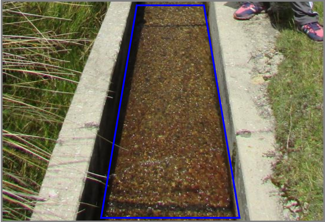
Fotografía 7. Presencia de erosión en la losa del canal en el que se realizó la medida por área y profundidad ubicado en la UM 5
