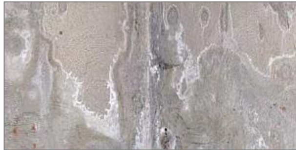
Figura 6. Eflorescencia en el concreto Fuente: Construmática (27)
