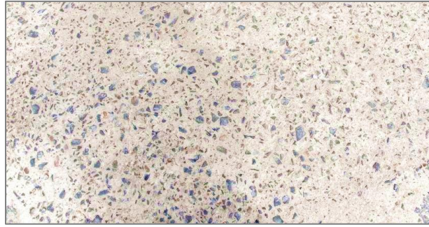
Figura 3. Erosión en el concreto
