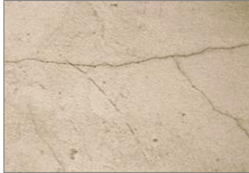
Figura 4. Fisuras en concreto
