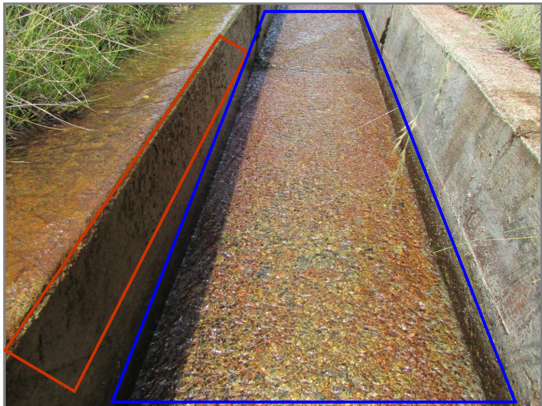
Fotografía 6. Presencia de erosión en la losa del canal y parte inferior de ambos márgenes, en el que se realizó la medida del área que ocupa y profundidad, y de los hongos en el margen izquierdo en el que se tomó medidas del área que ocupa y verificar si dañó de algún modo la estructura ubicados en la UM 4
