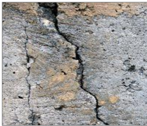
Figura 5. Grieta en concreto Fuente: García A. (23)
