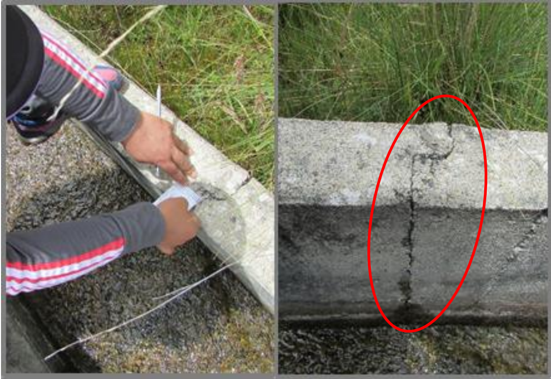
Fotografía 11. Medida de la abertura de la grieta ubicada en el margen izquierdo de la UM 8
