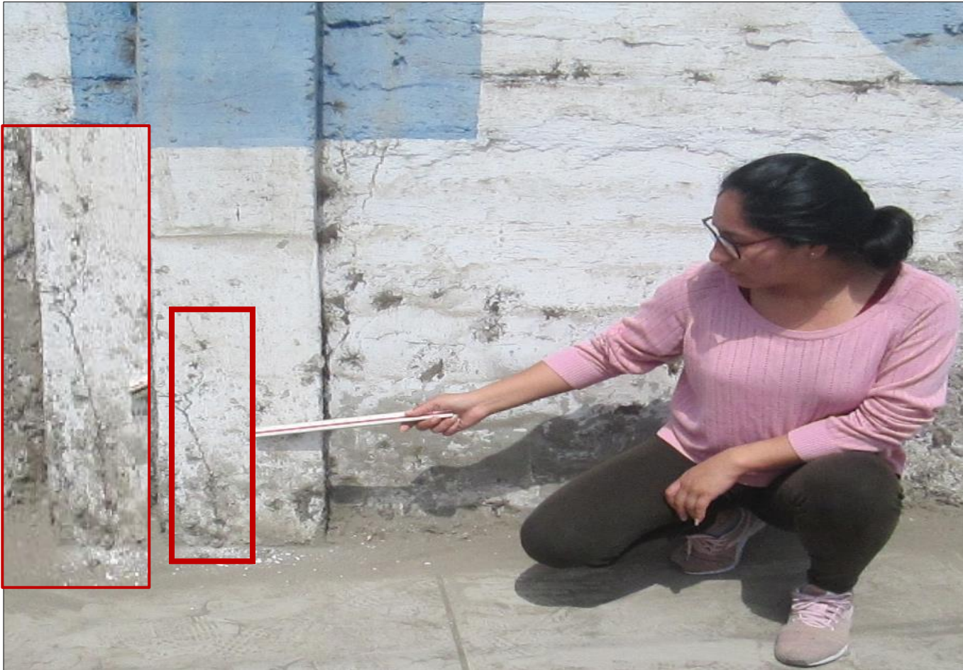
Fotografía 07. Columna afectada por grieta en la unidad muestral 09.
