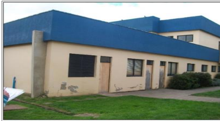
Gráfico 15. Imagen de eflorescencia en muro Fuente: Caroca (2012).
