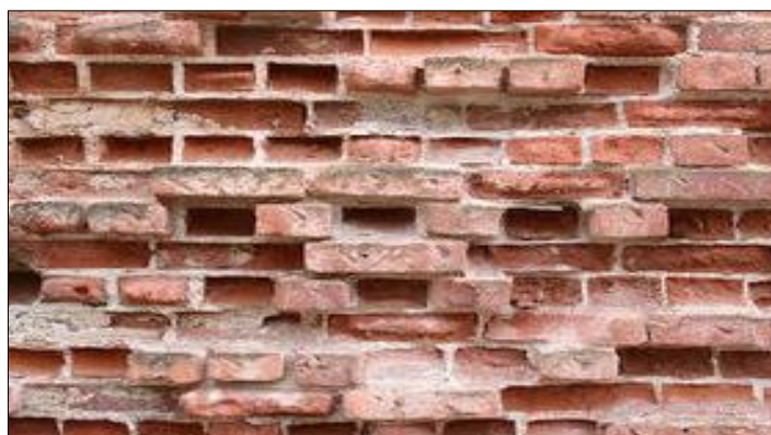
Gráfico 10. Imagen de erosión en muro de ladrillo.
