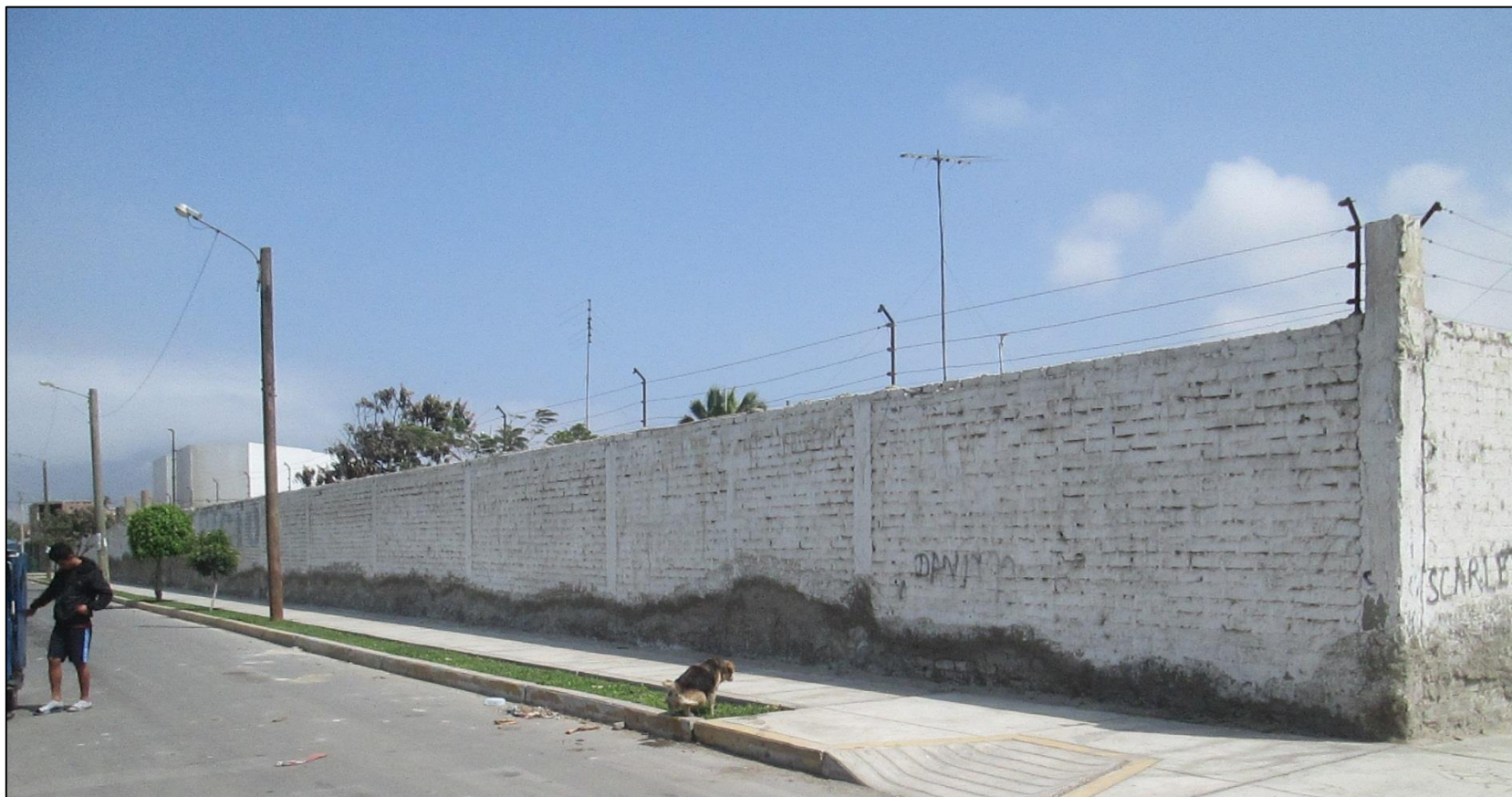
Fotografía 05. Vista lateral derecha del exterior del cerco perimétrico ex centro médico especializado Santa Clara, Asentamiento Humano Antenor Orrego, distrito de Chimbote, provincia del Santa, región Áncash.
