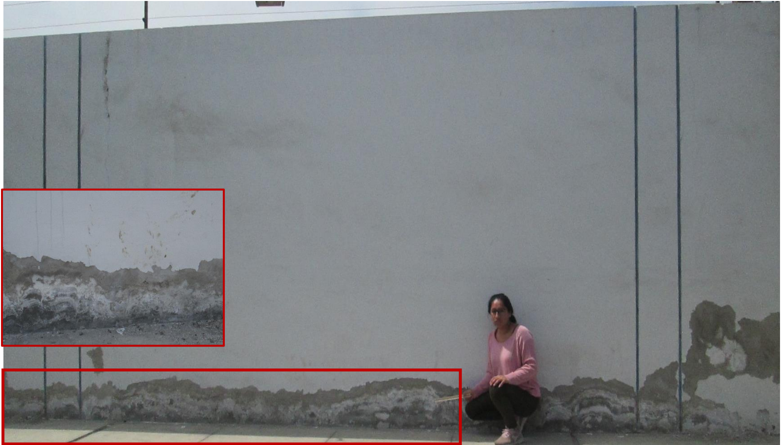
Fotografía 09. Muro afectado por eflorescencia en la unidad muestral 01.
