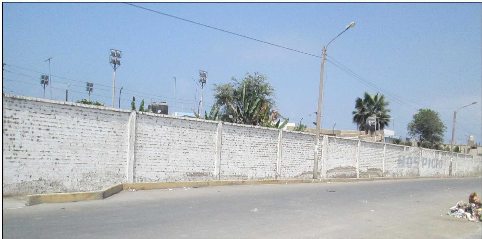
Fotografía 03. Vista lateral izquierda del exterior del cerco perimétrico ex centro médico especializado Santa Clara, Asentamiento Humano Antenor Orrego, distrito de Chimbote, provincia del Santa, región Áncash.
