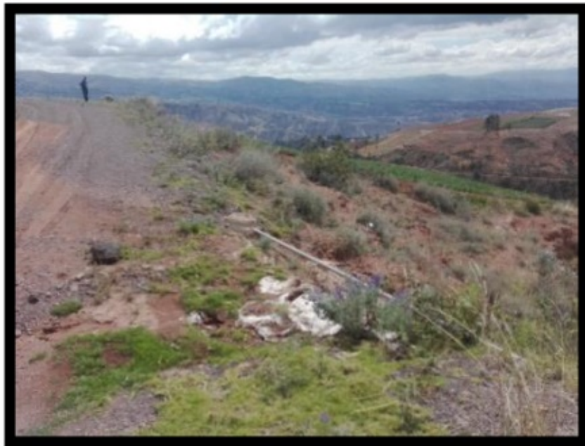
Figura 4.16: Tubería galvanizada a la intemperie en mal estado.
