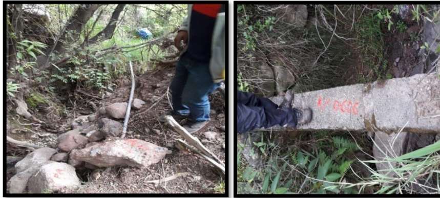
Figura 4.2: Tubería a la intemperie en quebradas y bajo concreto armado.
