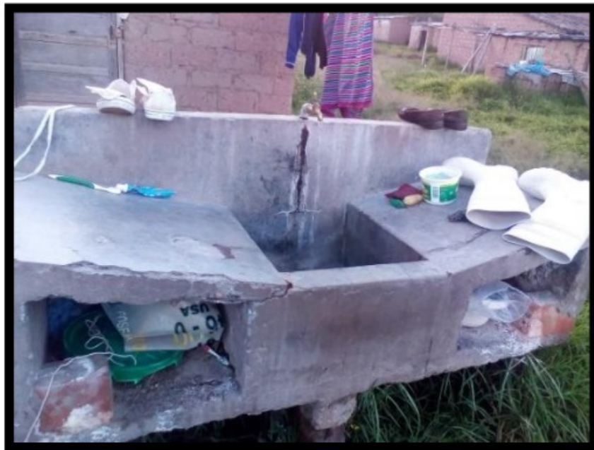
Figura 4.4: Lavadero en malas condiciones.
