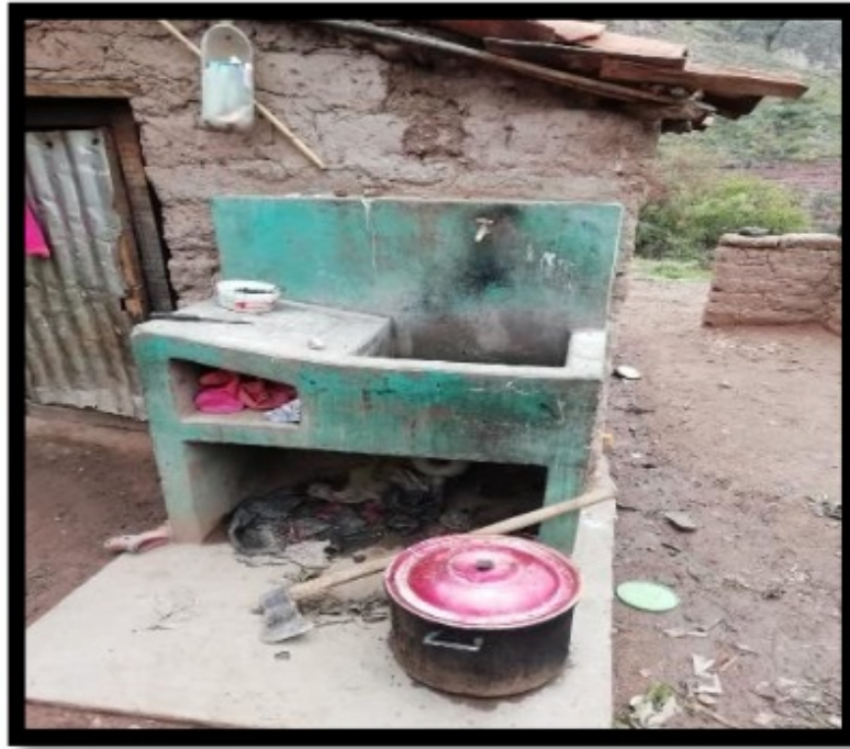
Figura 4.14: Conexiones de agua potable en malas condiciones.
