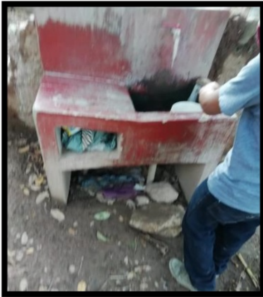
Figura 4.17: Lavaderos en completo mal estado.
