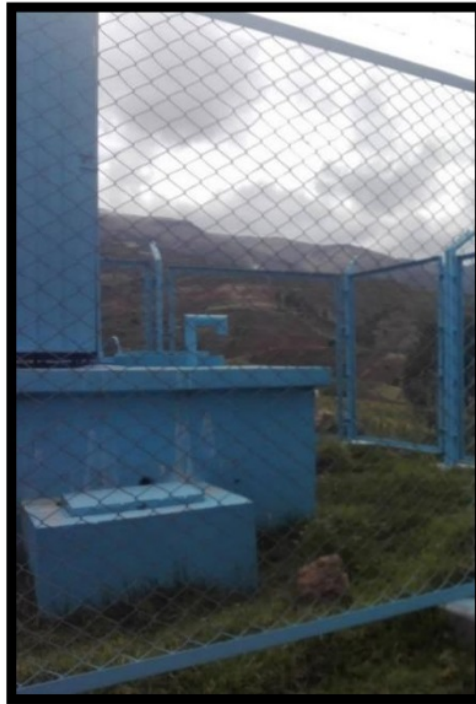
Figura 4.8: Reservorio Huancarama 5m3.
