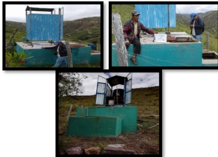
Figura 4.13: Reservorio en mal estado.
