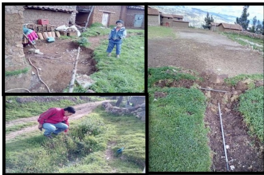
Figura 4.9: Tuberia expuesta y obstruida.
