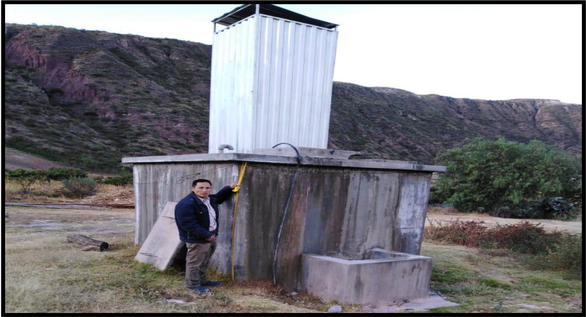
Foto 03: Cámara de cloración.
