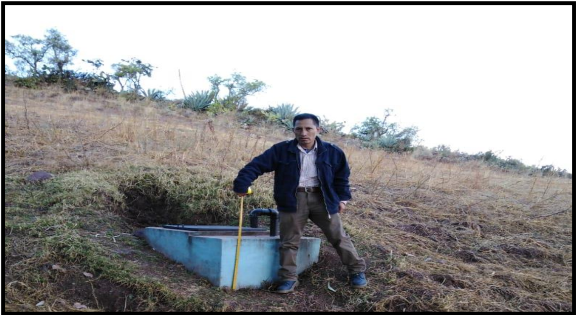
Foto 02: Sistema de captación.
