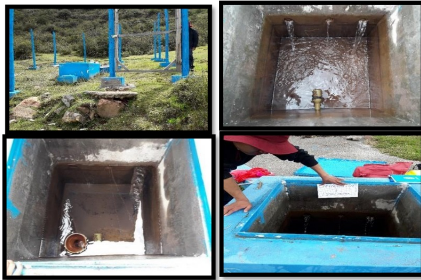
Figura 4.6: Captación en la comunidad de Huancarama.
