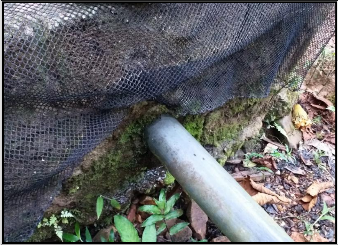
Figura 31. Estado deficiente de los elementos hidráulicos.
