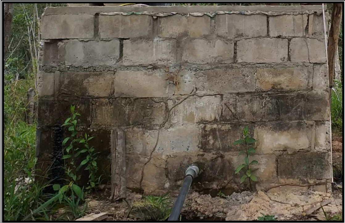
Figura 37. Se muestra el reservorio en malas condiciones generando pérdidas.
