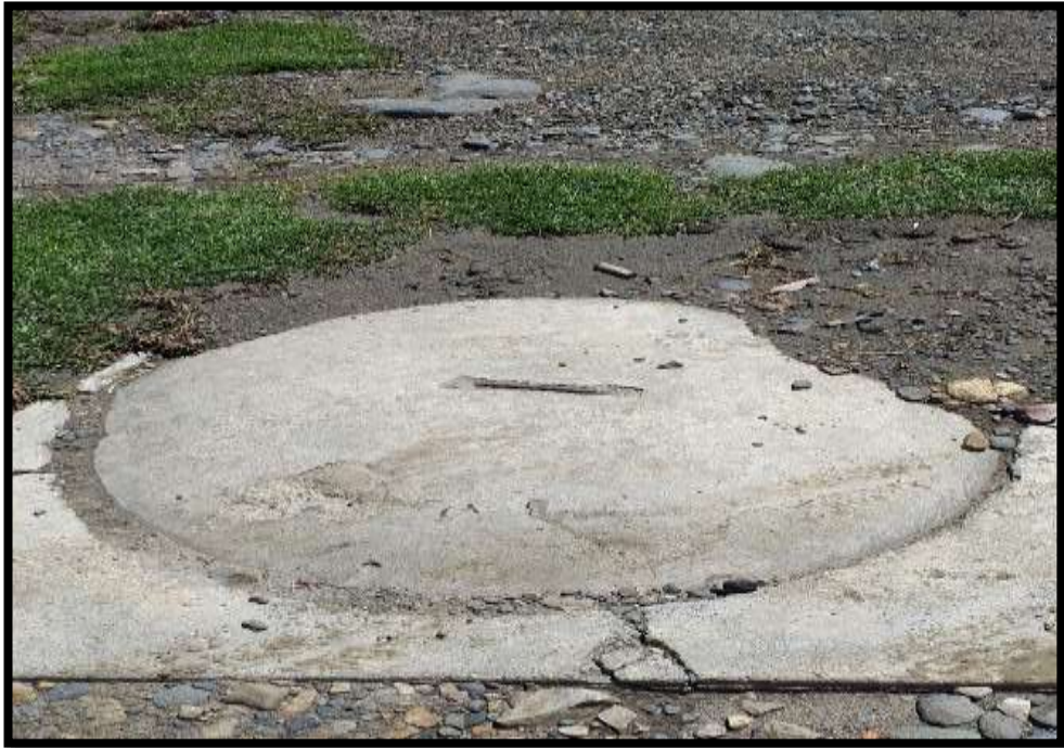
Fotografía N° 12: Se observa el deterioro estructural de las tapas de desagües.
