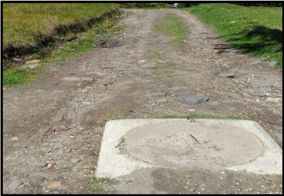
Fotografía N° 13: Se observa el deterioro estructural de las tapas de desagües.
