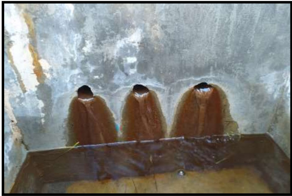
Fotografía N° 03: Captación N° 1 y 3, Se observa cómo se capta el agua del manantial y la falta de mantenimiento.
