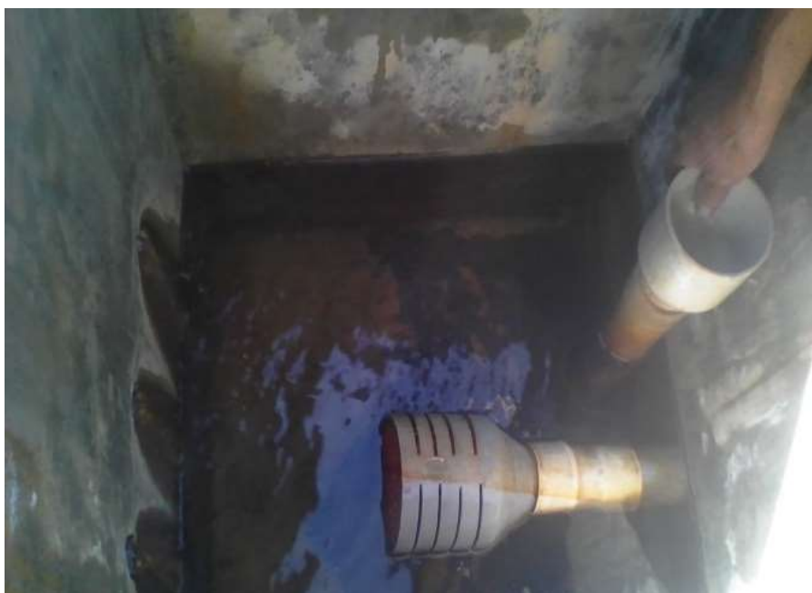
Fotografía N° 02: Vista de las ventanas de la Captación, tubo de rebose y la canastilla de conducción de agua.
