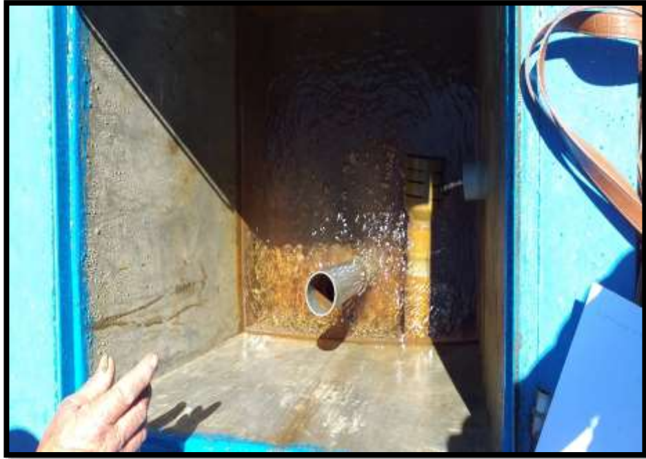
Fotografía N° 02: Captación N° 1 y 3, Se observa cómo se capta el agua del manantial y la falta de mantenimiento.
