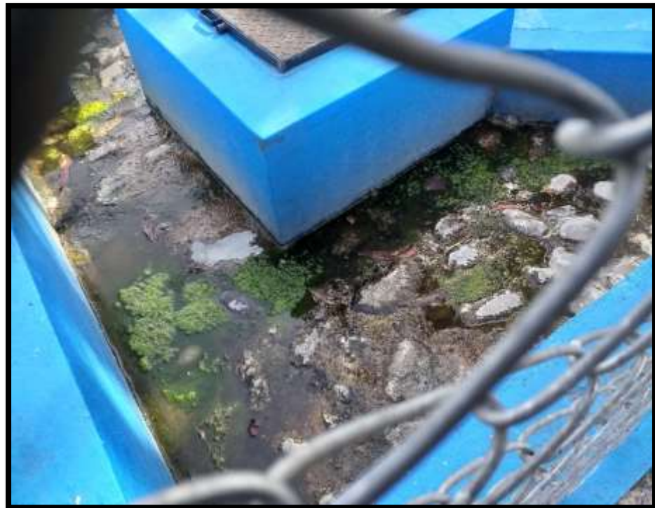
Fotografía N° 05: Captación N° 2, Observamos que cuenta con cerco perimétrico, no cuenta con la limpieza adecuada.
