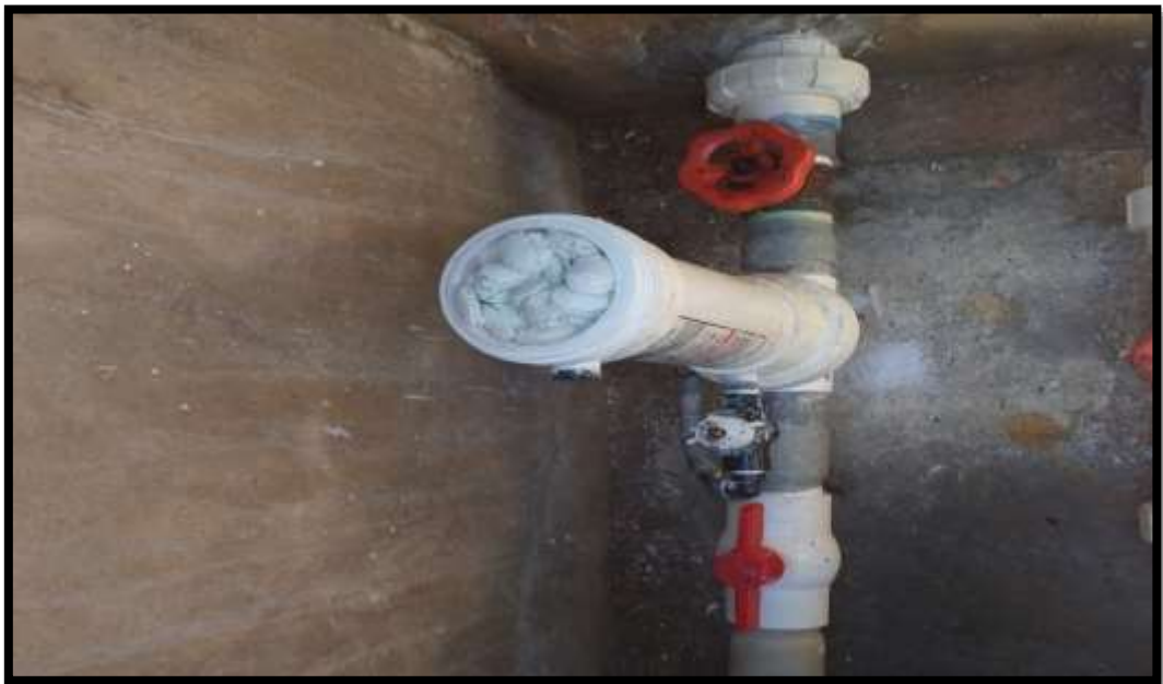
Fotografía N° 11: Cloración en la tubería para la distribución del agua a las viviendas.
