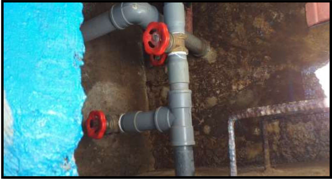
Fotografía N° 10: Reservorio, Se observa la caja de válvulas.
