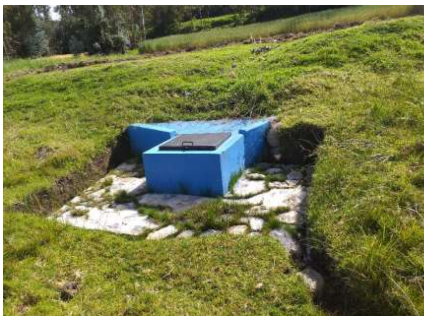
Fotografía N° 07: Captación N° 06 tipo Ladera, en el caserío de Curhuaz, estado de conservación regular, no posee cerco perimétrico.
