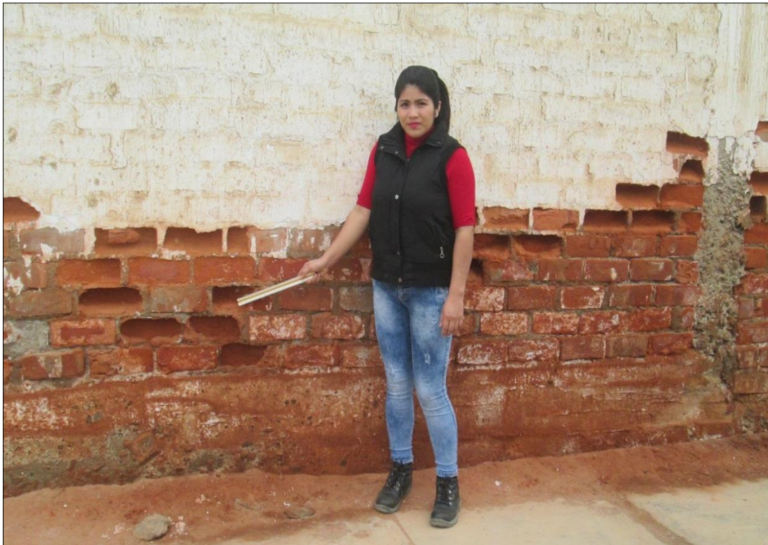
Fotografía 10. Presencia de desintegración en algunas unidades de albañilería en el muro de la unidad muestral - 12.
