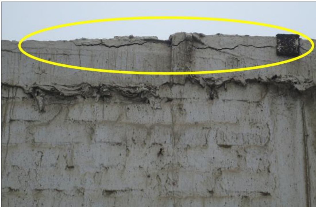
Fotografía 09. Presencia de grieta en viga de la unidad muestral -14. Producidos por que pusieron plaquetas de acero.
