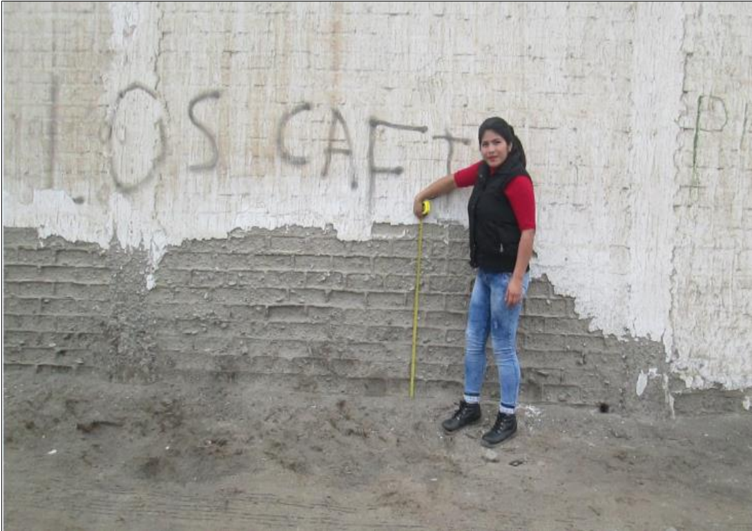
Fotografía 04. Tomando la medida del área afectada del muro afectado por erosión en la unidad muestral - 01.
