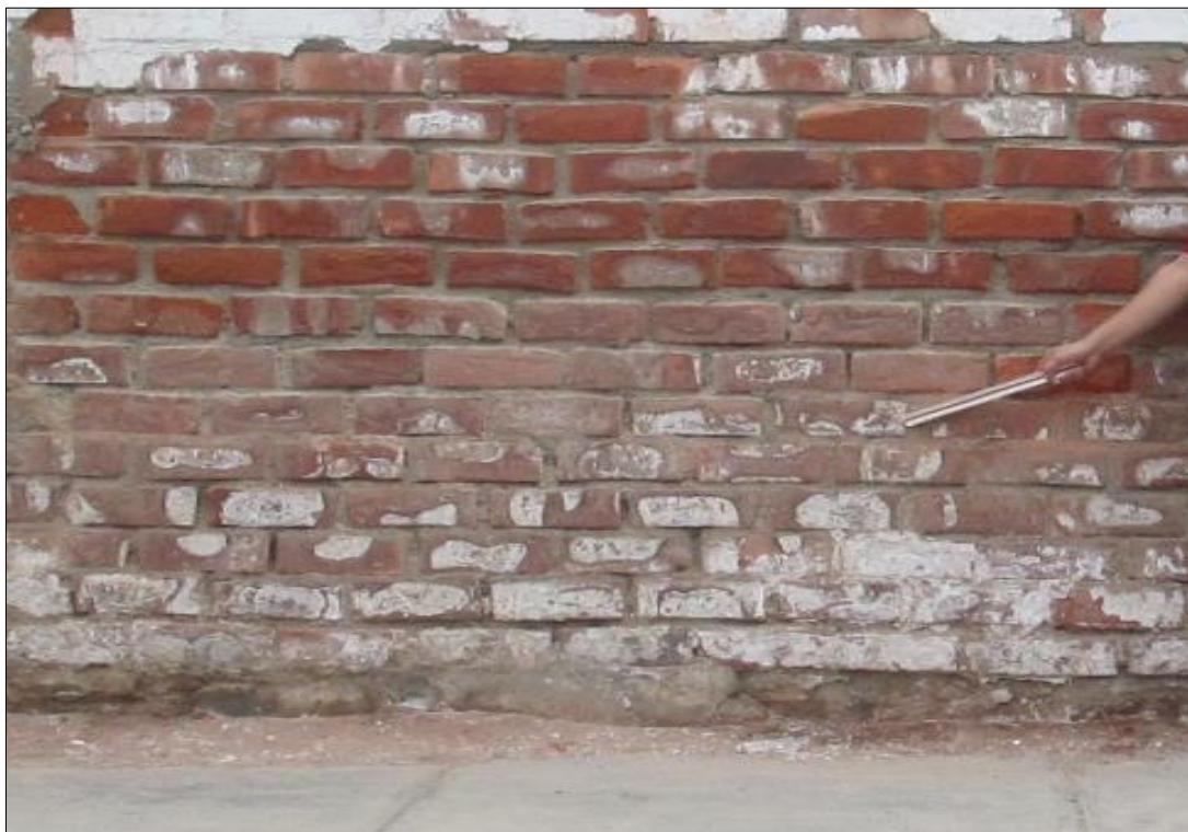
Fotografía 12. Presencia de eflorescencia en el muro de la unidad muestral -14.
