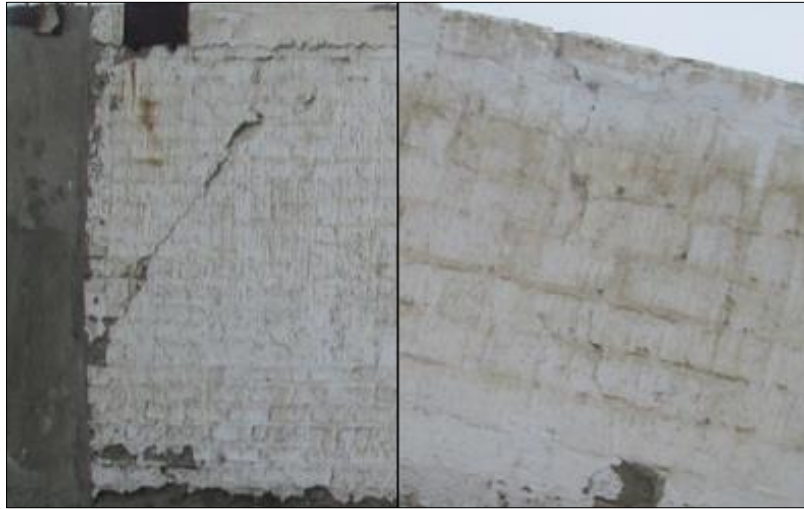
Gráfico 14. Imagen de presencia de grieta en el muro de Albañilería.
