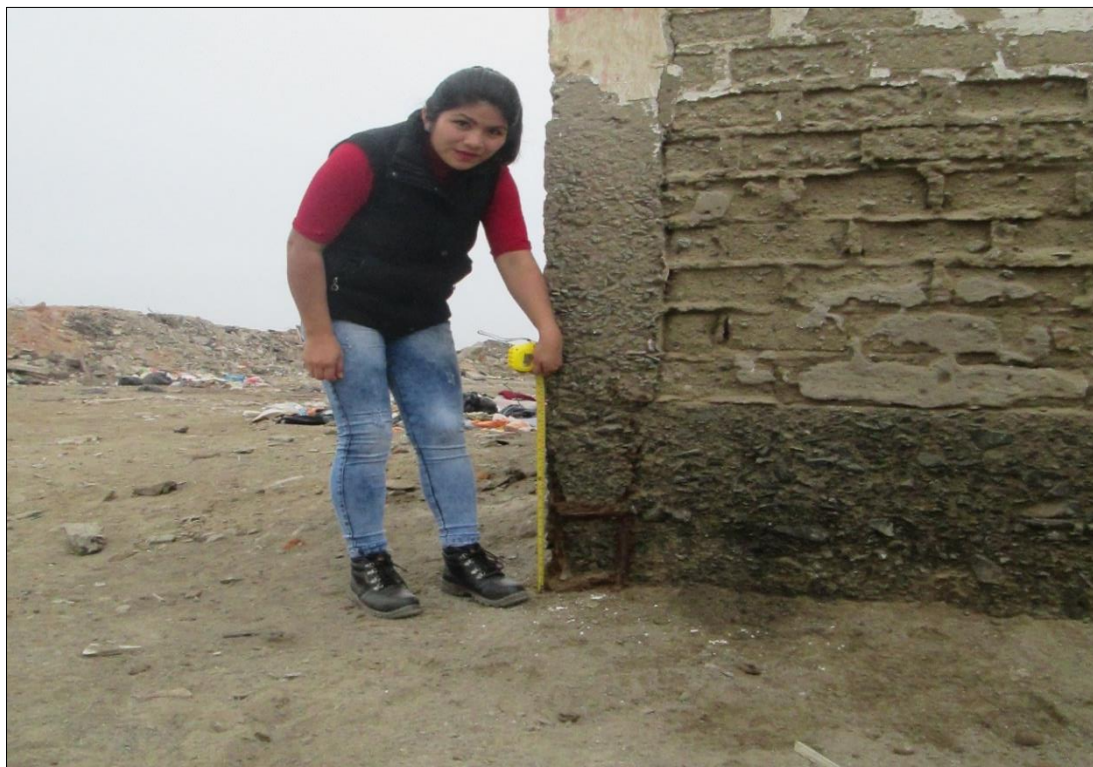
Fotografía 15. Presencia de corrosión en el muro de la unidad muestral - 08.
