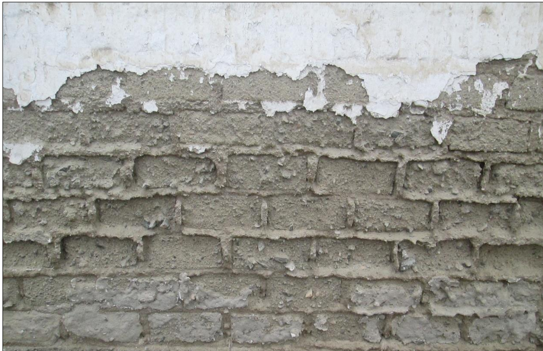
Fotografía 05. Muro afectado por erosión en la unidad muestral - 01.
