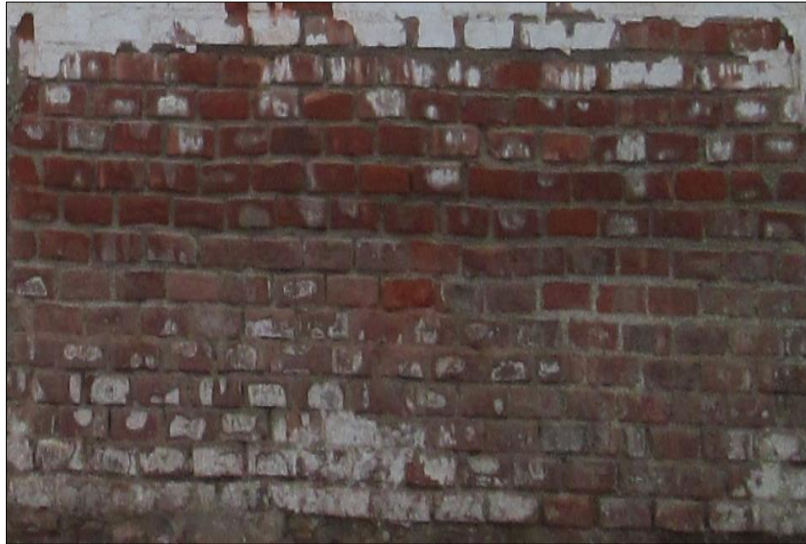
Gráfico 17. Imagen de presencia de eflorescencia en el muro. Nota. Fuente: Investigación Propia (2019).
