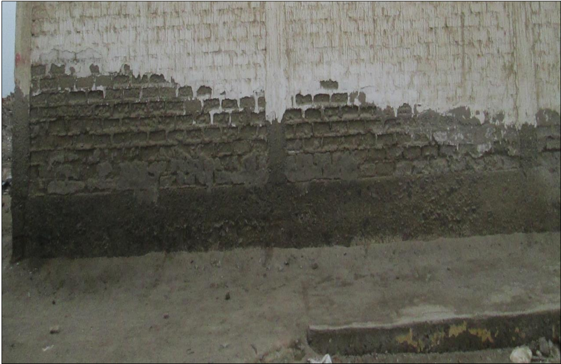
Fotografía 06. Presencia de erosión en muro, columna y sobrecimiento en la unidad muestral - 08.
