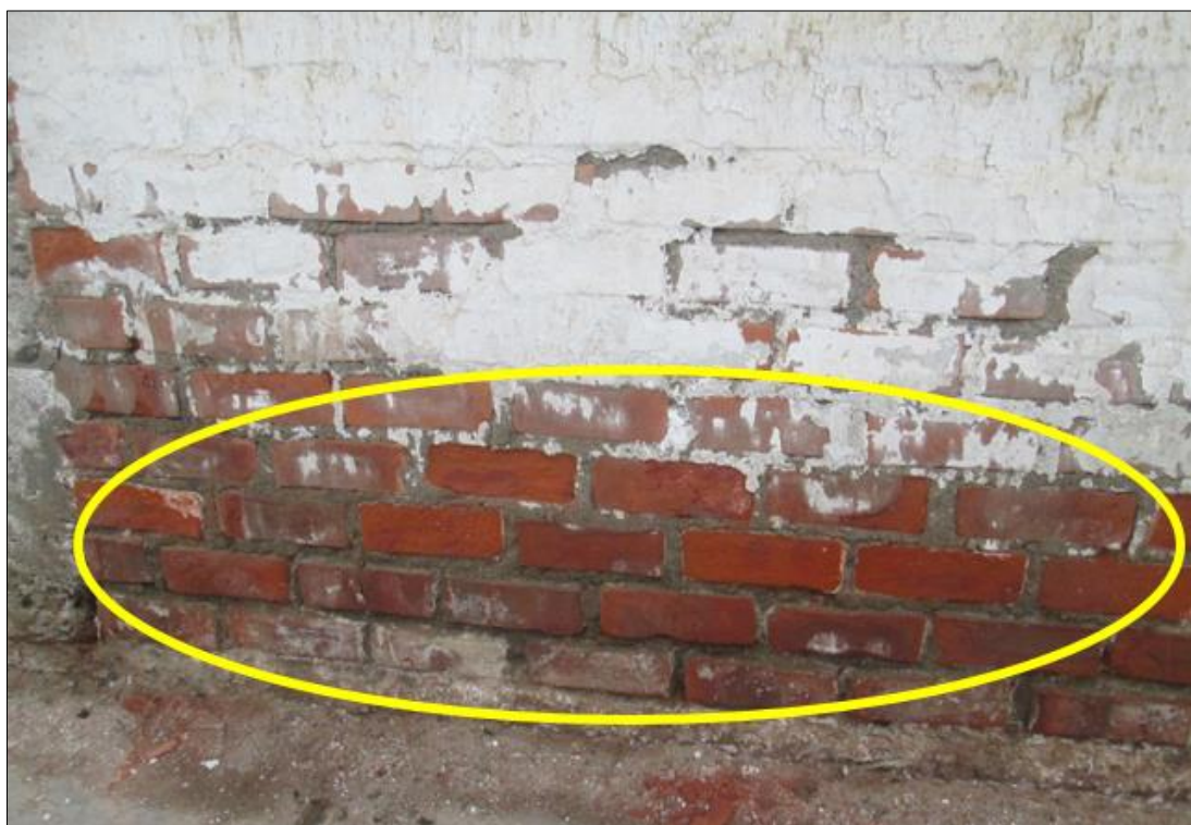
Fotografía 13. Presencia de eflorescencia en el muro de la unidad muestral -15.
