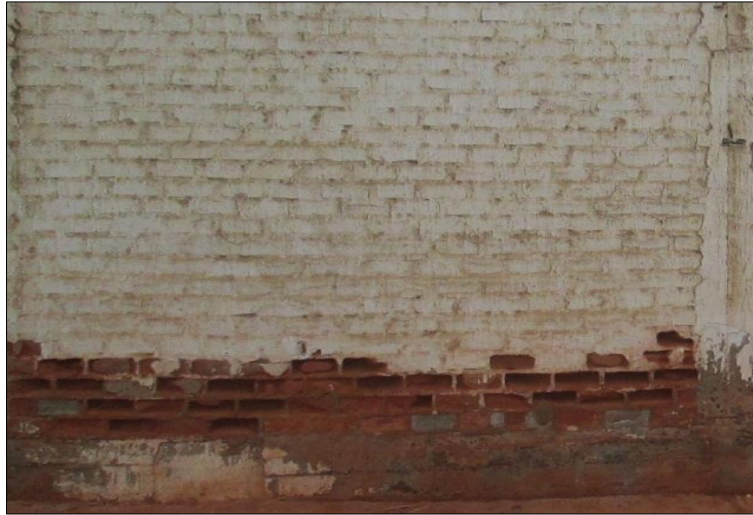
Gráfico 16. Imagen de presencia de desintegración en el muro. Nota. Fuente: Investigación Propia (2019).
