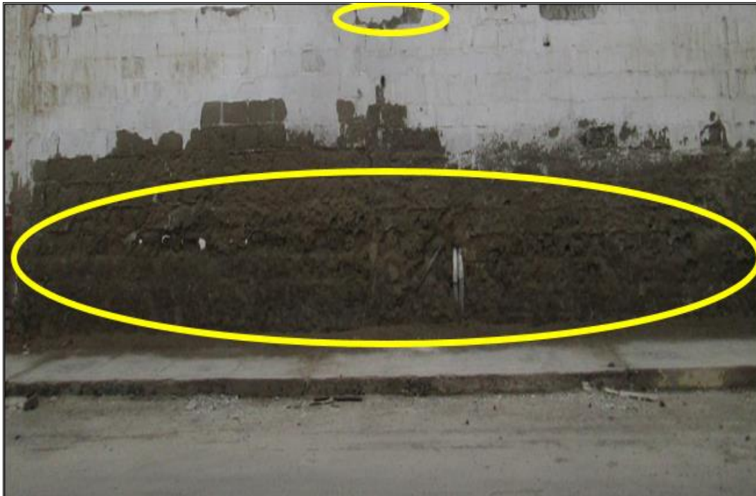
Fotografía 11. Presencia de desintegración en el muro de la unidad muestral -16.
