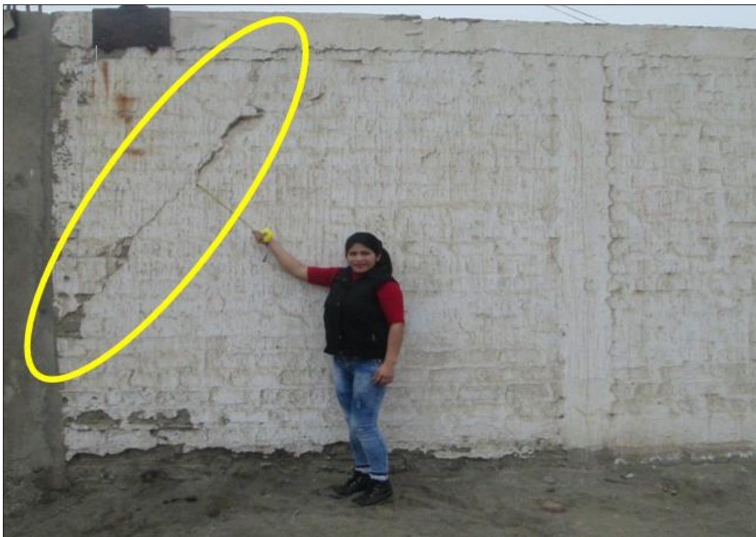
Fotografía 07. Presencia de grieta transversal en el muro de la unidad muestral - 05.
