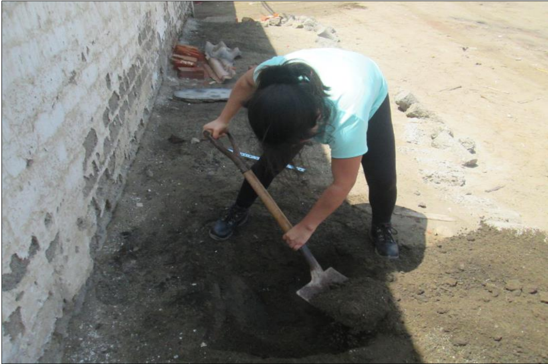
Fotografía 01. Relazando la calicata para determinar en qué nivel profundidad se encuentra la capa freática.
