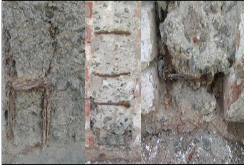
Gráfico 18. Imagen de presencia de corrosión en el acero de las columnas.
