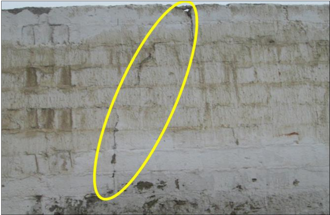
Fotografía 08. Presencia de grieta en el muro de la unidad muestral -18.
