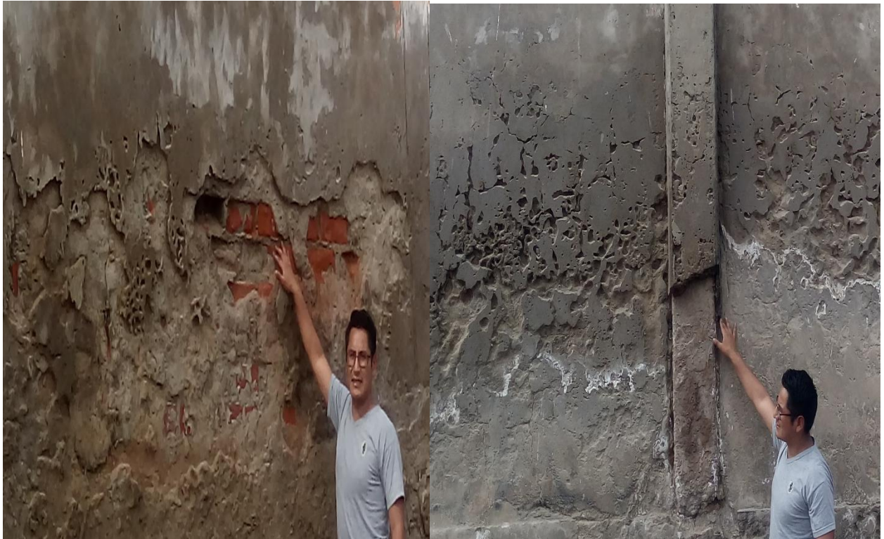
La imagen de las patologías de desprendimiento
