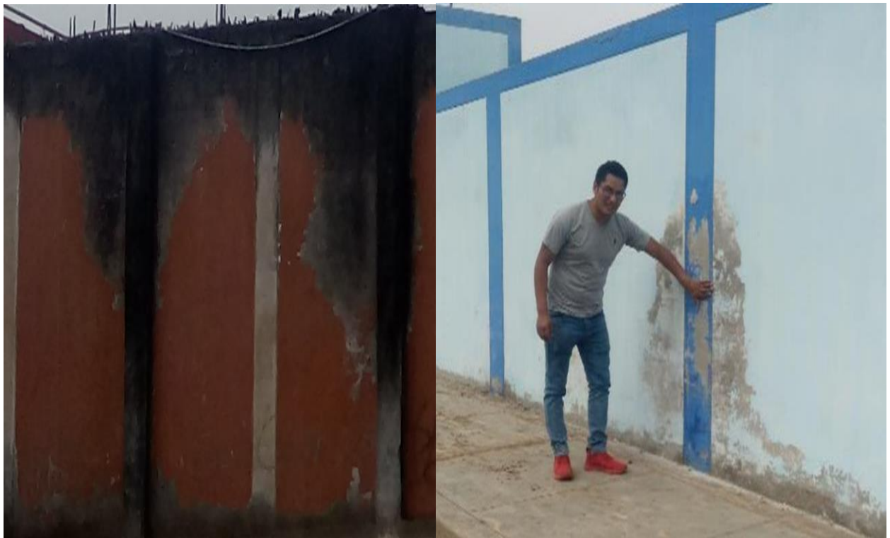
La imagen de las patologías de eflorescencia
