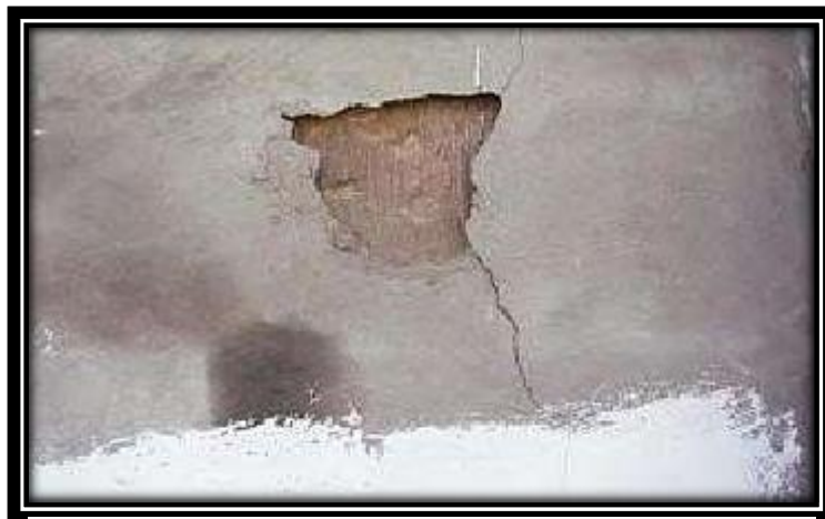
Gráfico 15. Desprendimiento de tarrajeo en el muro de albañilería
