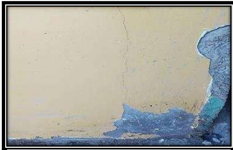
Gráfico 14. Fisura en muro de albañilería, hospicio Santiago Fuente: Cornelio (2016)
