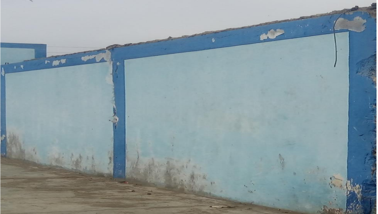
Imagen de la patología de fisura
