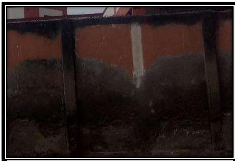
Gráfico 16. Eflorescencia en muros de cerco perimétrico Fuente: investigación propia (2019)
