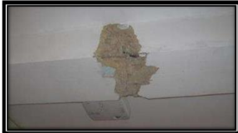
Gráfico 1. Grieta en viga encontrada en el colegio Evangelino Interamericano Fuente: Velasco (2014)
