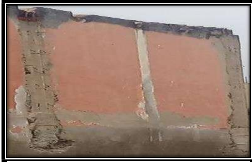
Gráfico 17. Corrosión en la columnas del cerco perimétrico Fuente: investigación propia (2019)
