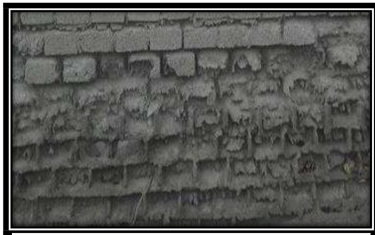
Gráfico 13. Erosión en muro de albañilería producida por agentes físicos
