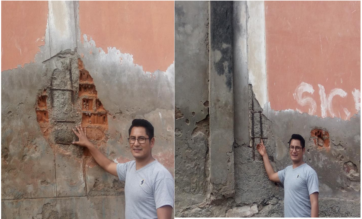
La imagen de las patologías de corrosión
