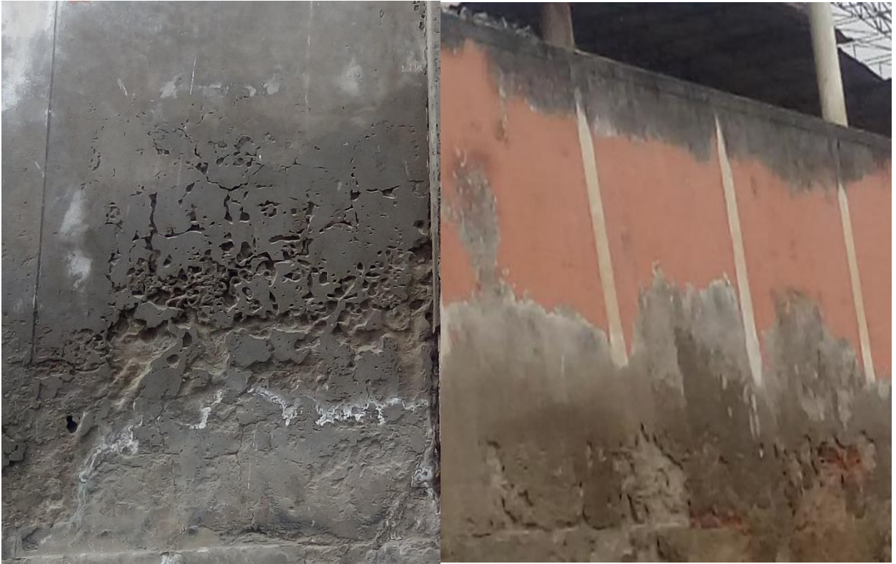
La imagen de patologías de erosión
