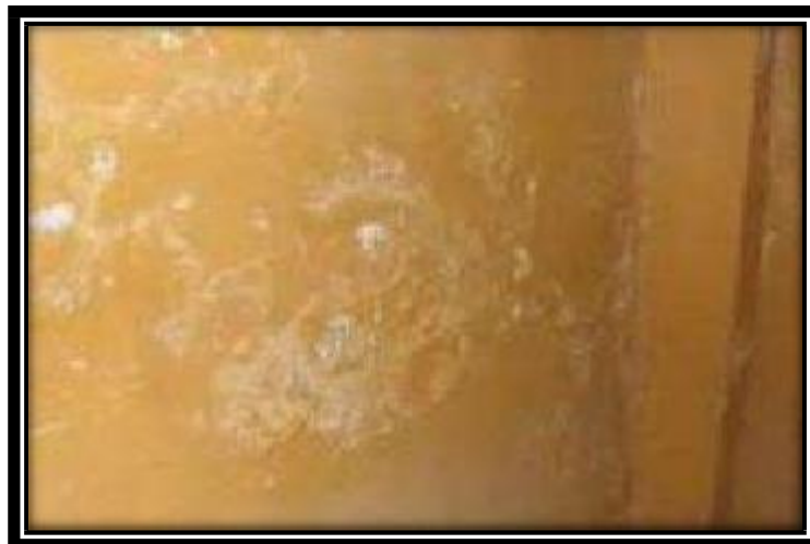
Gráfico 2. Eflorescencia en el muro de la iglesia santo Toribio de Mogrovejo. Fuente: Varela y Zetien (2013).
