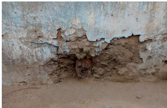
Figura 13: Distorsión en un muro de albañilería.
