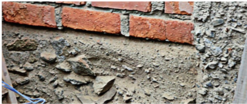
Figura 10: Patología desintegración física.
