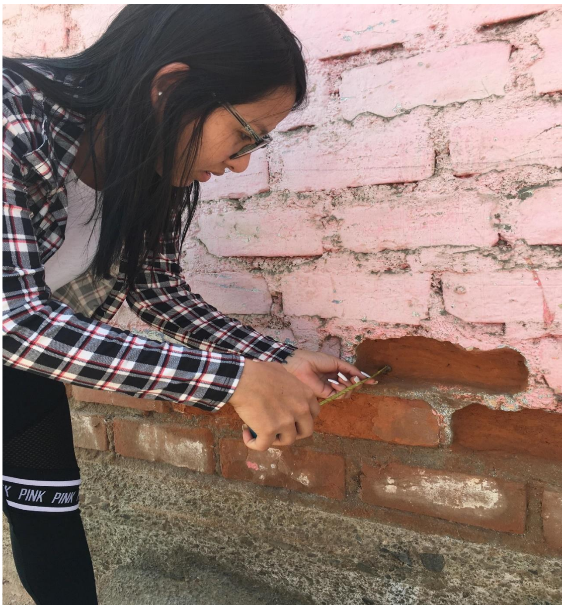
Figura 19: Muro de albañilería afectada por la patología erosión, medimos la profundidad para poder evaluar el grado de afectación de la unidad de muestra N° 6.
