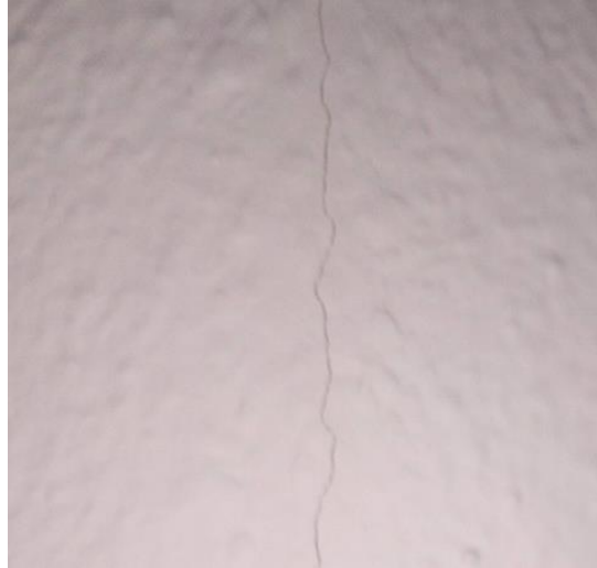
Figura 11: Patología fisura en un muro de albañilería.
