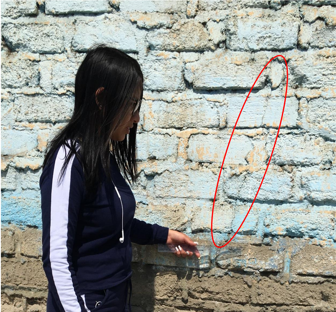
Figura 23: Fisura encontrada en la unidad de muestra N° 20.
