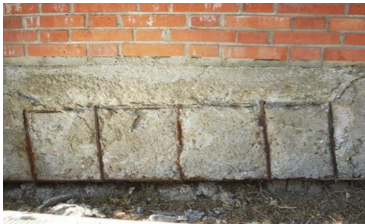
Figura 16: Corrosión en un muro de albañilería.
