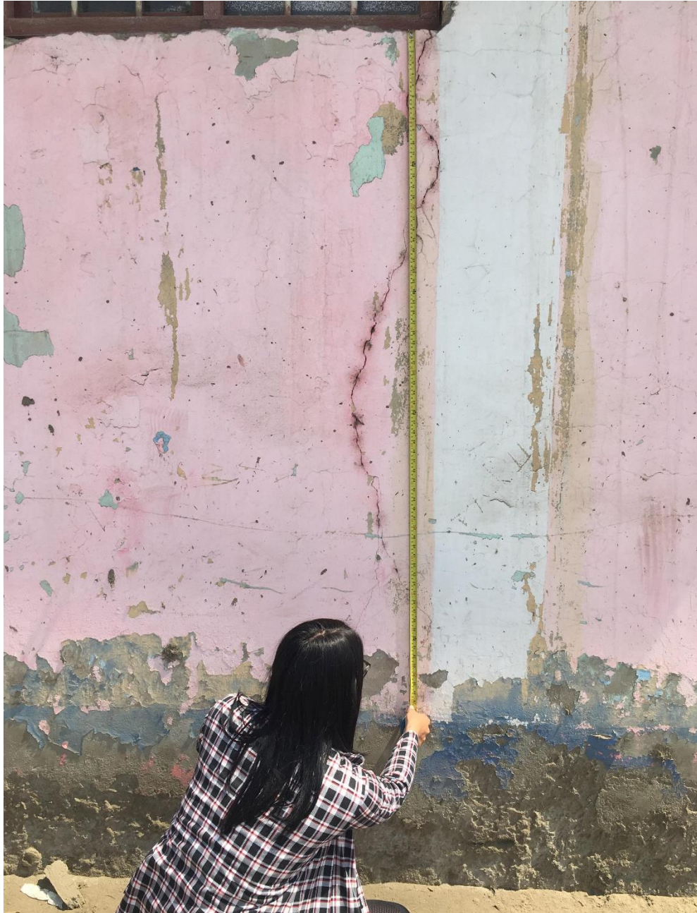
Figura 22: Medición de largo de la grieta encontrada en la unidad de muestra N°18.
