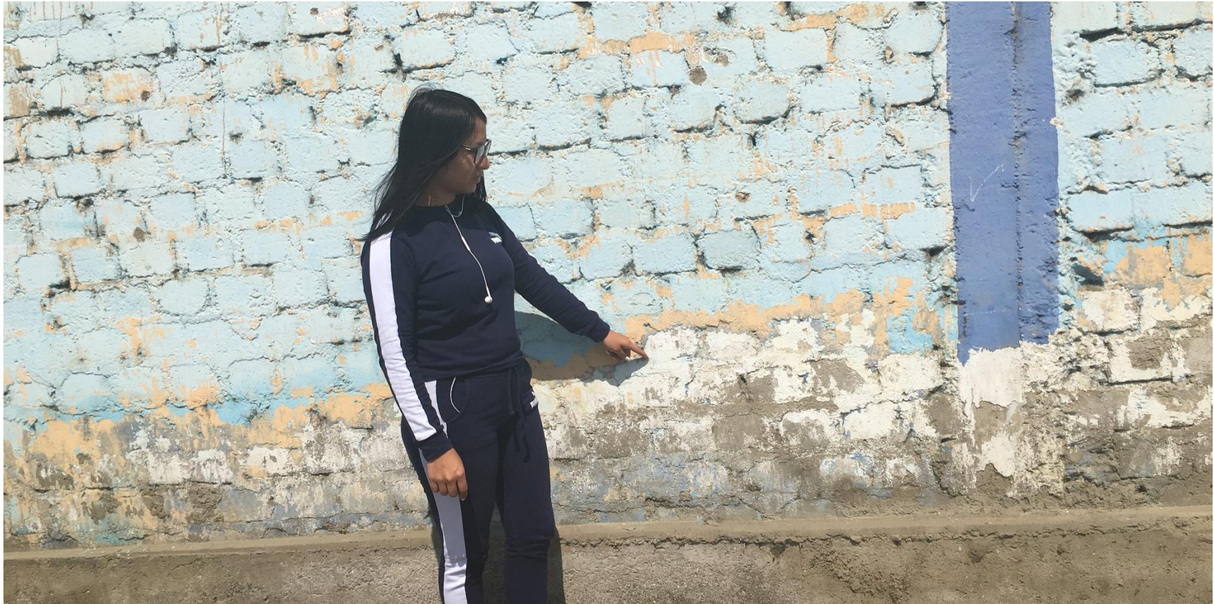
Figura 25: Patología eflorescencia ubicada en la unidad de muestra N° 19.
