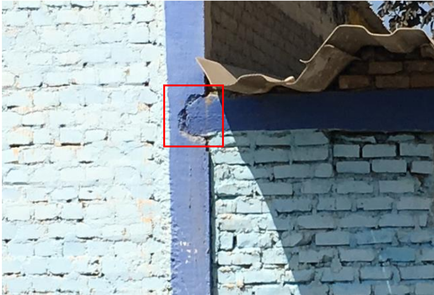
Figura 26: Desprendimiento en la unidad de muestra N° 19, causada por el paso del tiempo y la adherencia de los materiales.
