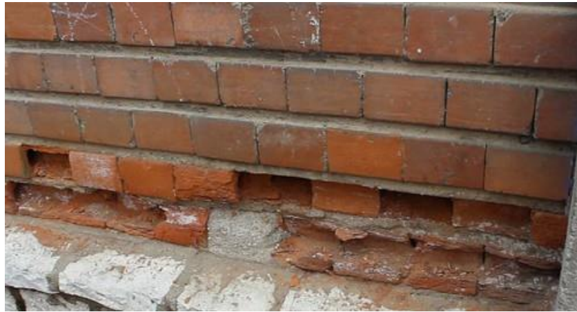
Figura 09: Erosión física en muro de albañilería.
