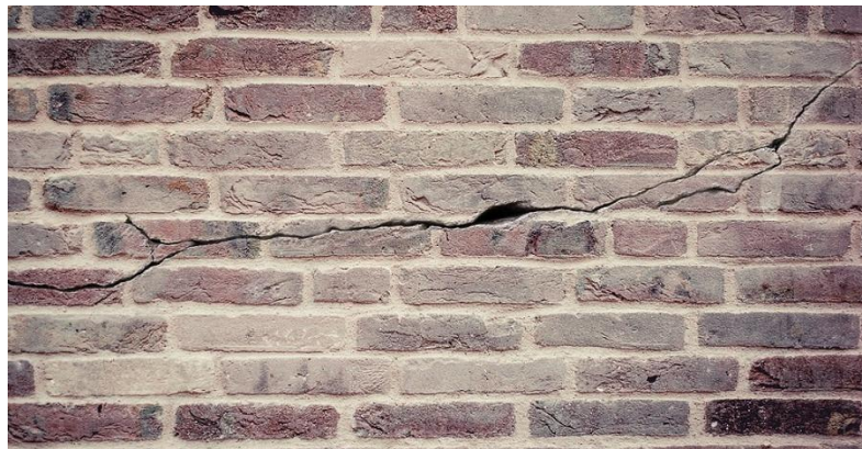
Figura 12: Grieta en un muro de albañilería.
