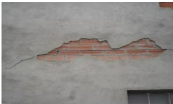
Figura 14: Muro de albañilería, con la patología desprendimiento.
