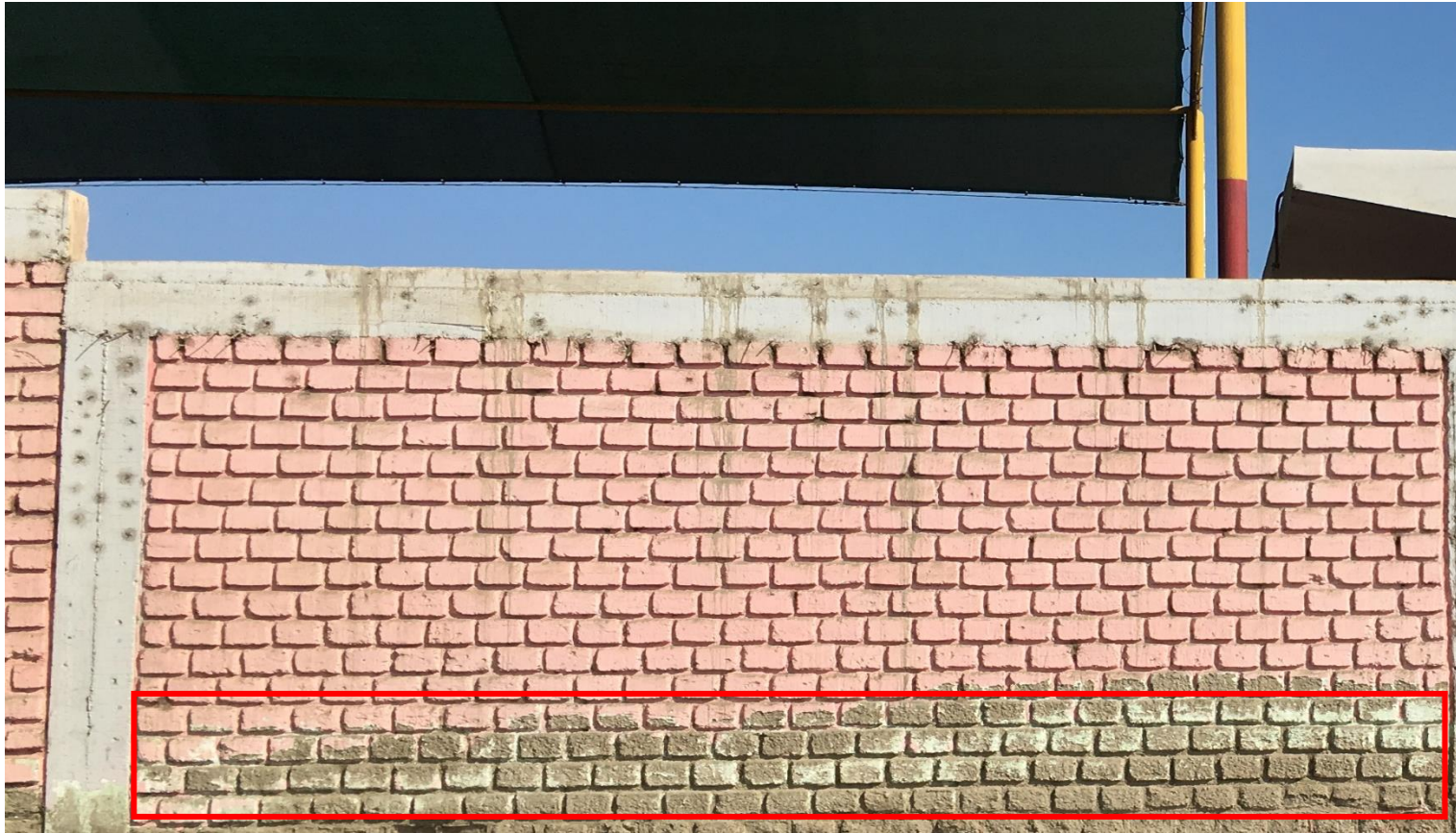
Figura 24: Hallazgo de la patología eflorescencia en la unidad de muestra N° 12 a causa de la humedad existente en la zona.
