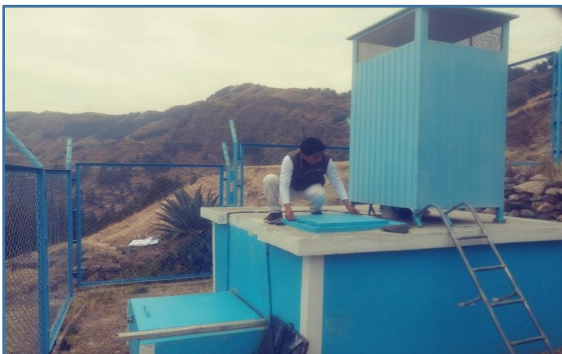
Imagen 11: Tapa sanitaria del reservorio de agua potable de la comunidad de San Martin de Ccoriacc
