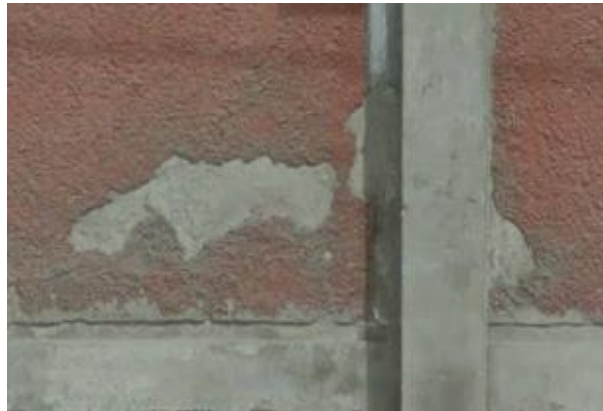
Figura 15. Desprendimiento del Tarrajeo en Muro.
