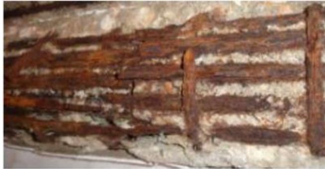
Figura 18. Presencia de Corrosion en Concreto Armado.
