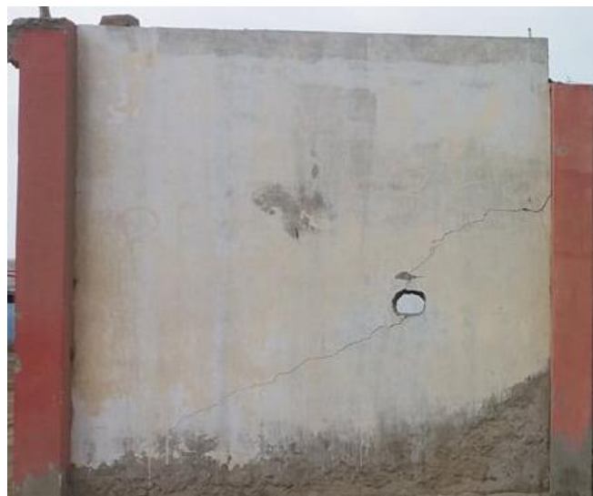
Figura 12. Muro Afectado por Erosión Mecánica.
