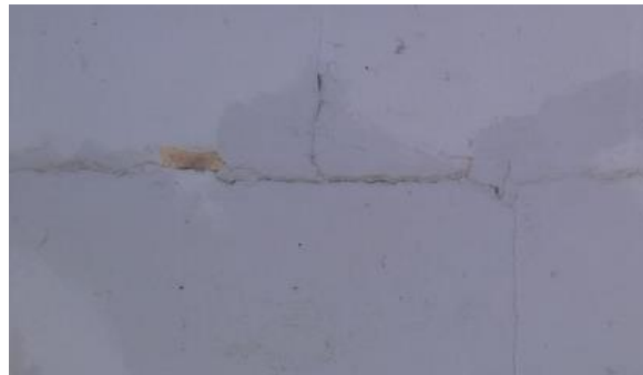
Figura 13. Fisuras en Muro.
