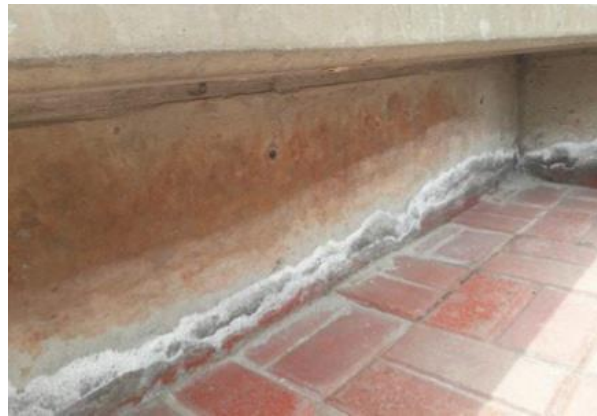
Figura 17. Muro con presencia de Eflorescencia.
