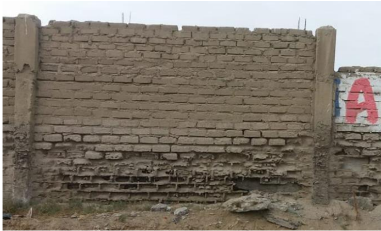
Figura 16. Presencia de Erosion Química en Muros.
