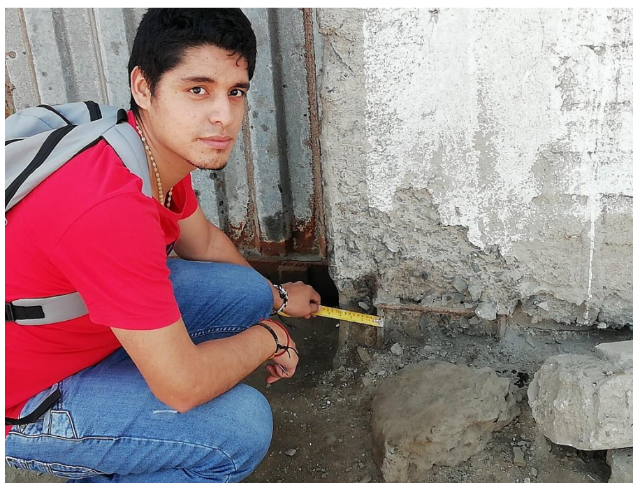
Fotografía 3. Columna afectada por Corrosión en la muestra 4.
