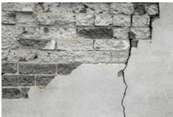
Figura 14. Grieta en Muro.
