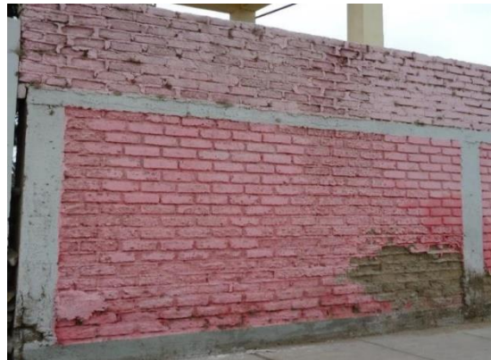
Figura 11: Muro Afectado por Erosión Física.
