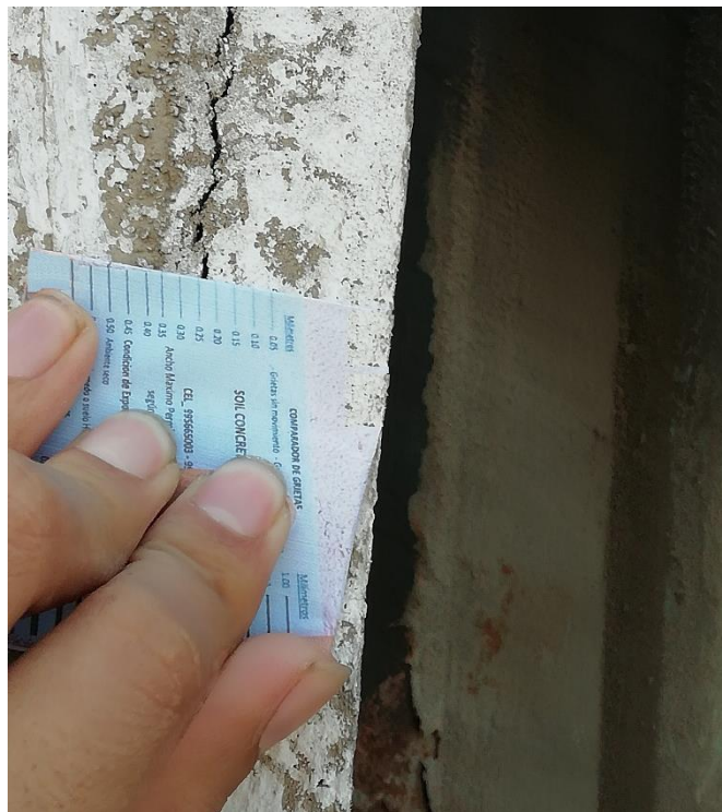
Fotografía 5. Medición de fisuras con un comparador de fisuras en la muestra 3.
