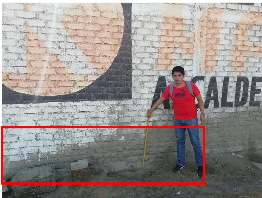
Fotografía 2. Muro afectado por erosión en la unidad muestral 4.
