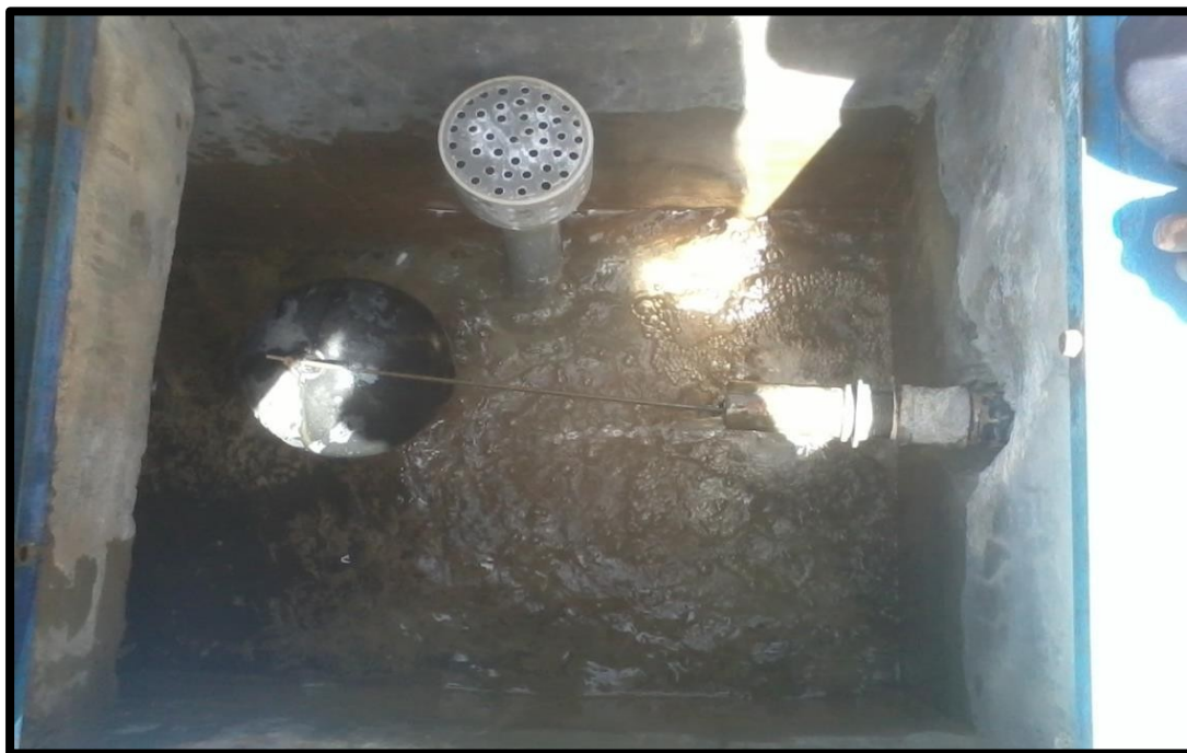
Fuente: Registro propio (Insitu)
