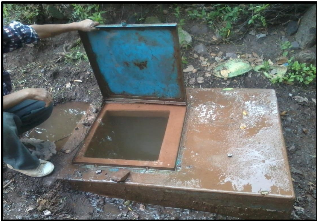
Fuente: Registro propio (Insitu)
