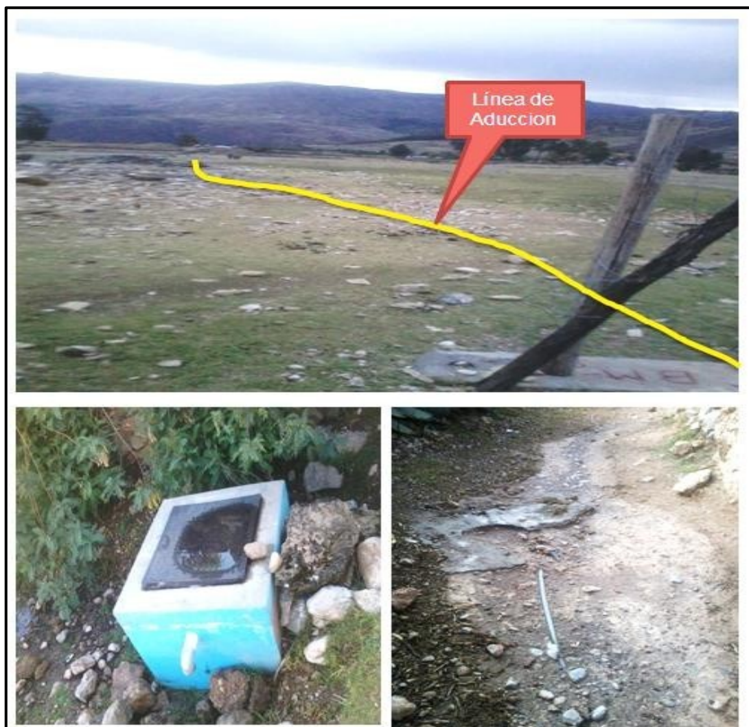
Fotografía 6: Vista de la red de aducción y distribución.
