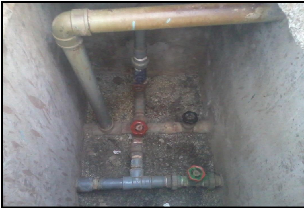
Fuente: Registro propio (Insitu)
