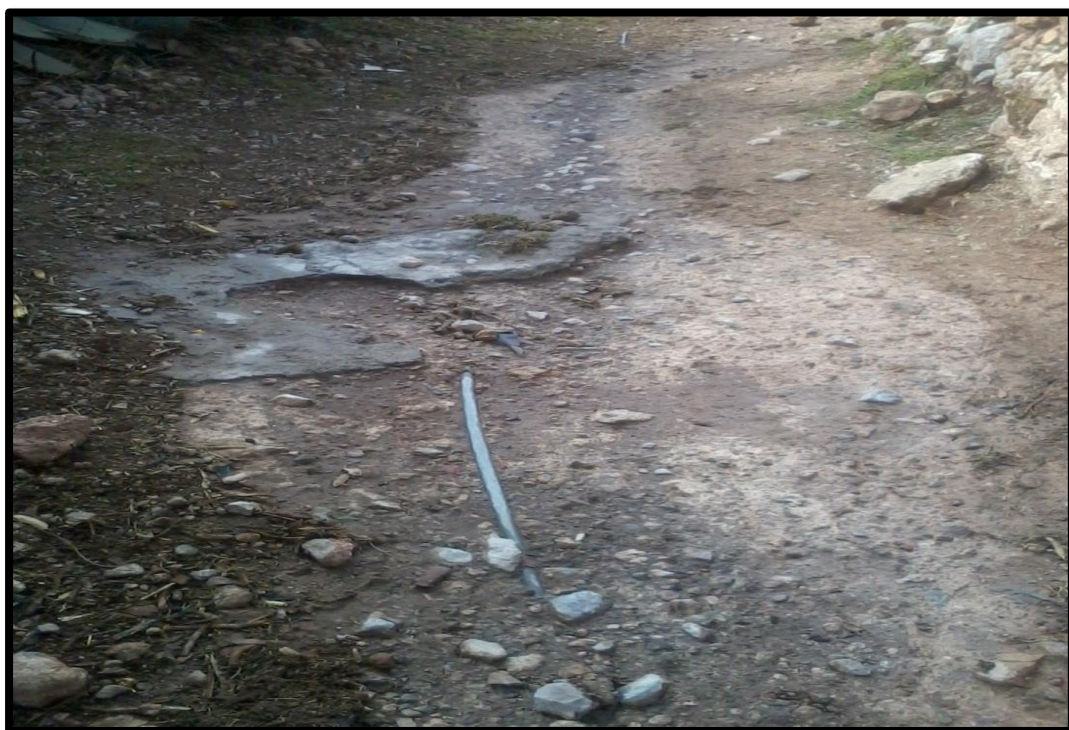
Fotografía 20: Vista de tubería en red de distribución expuesta al deterioro.
