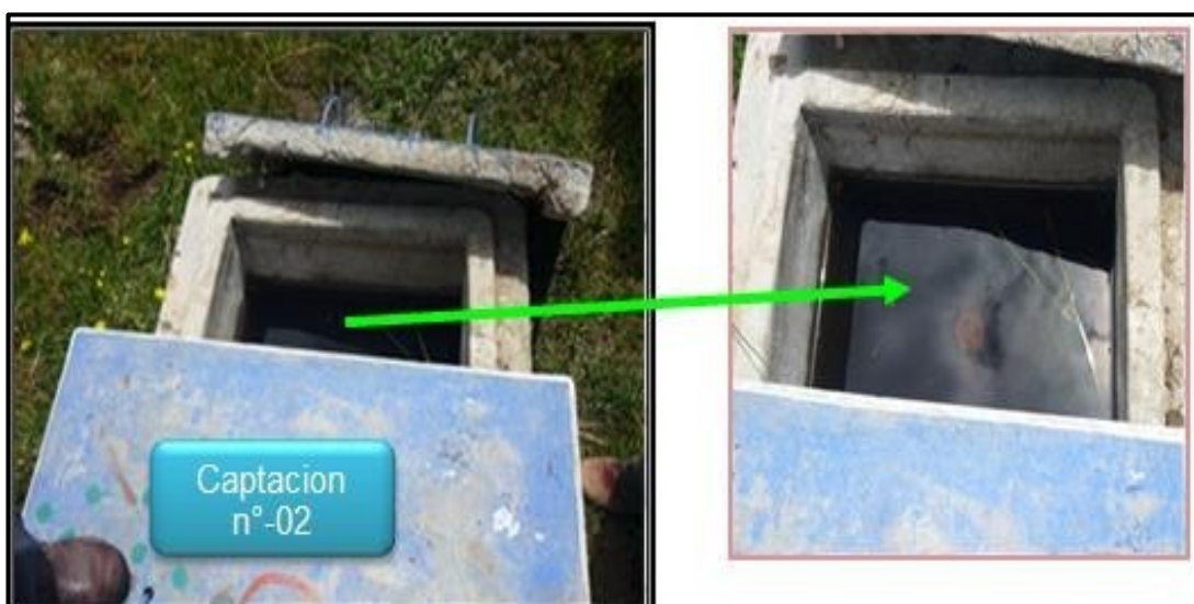
Fuente: Registro propio (Insitu)
