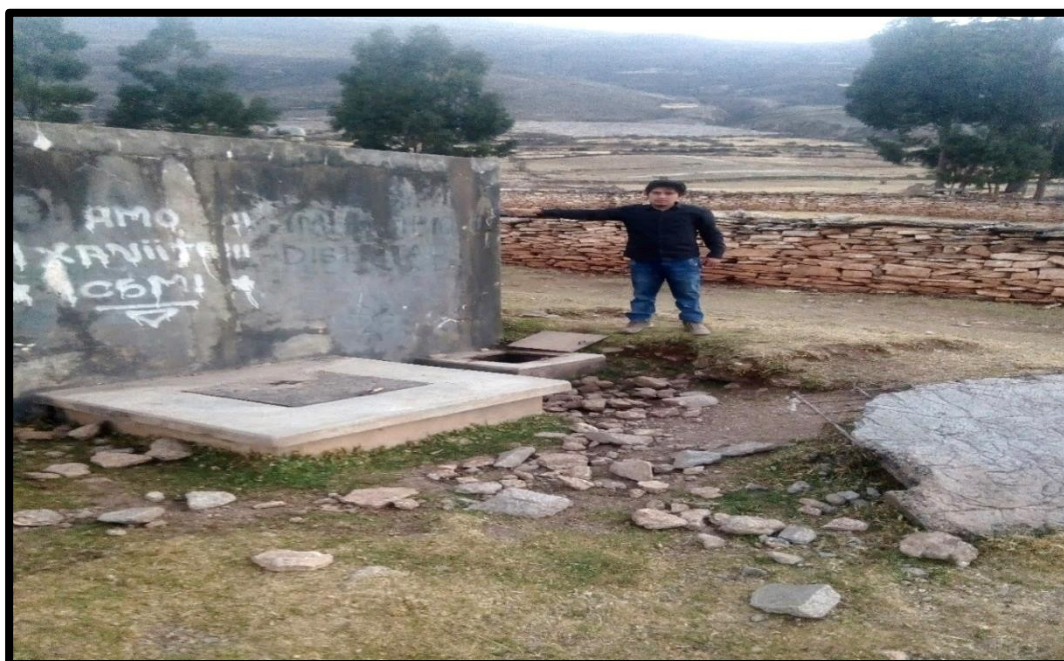
Fuente: Registro propio (Insitu)
