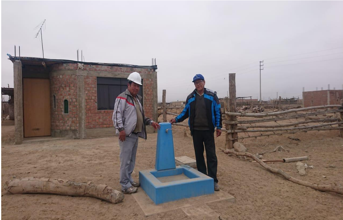
Fotografía 09: Comprobación del funcionamiento del agua, en cada pilón en la comunidad de Villa Sol.
