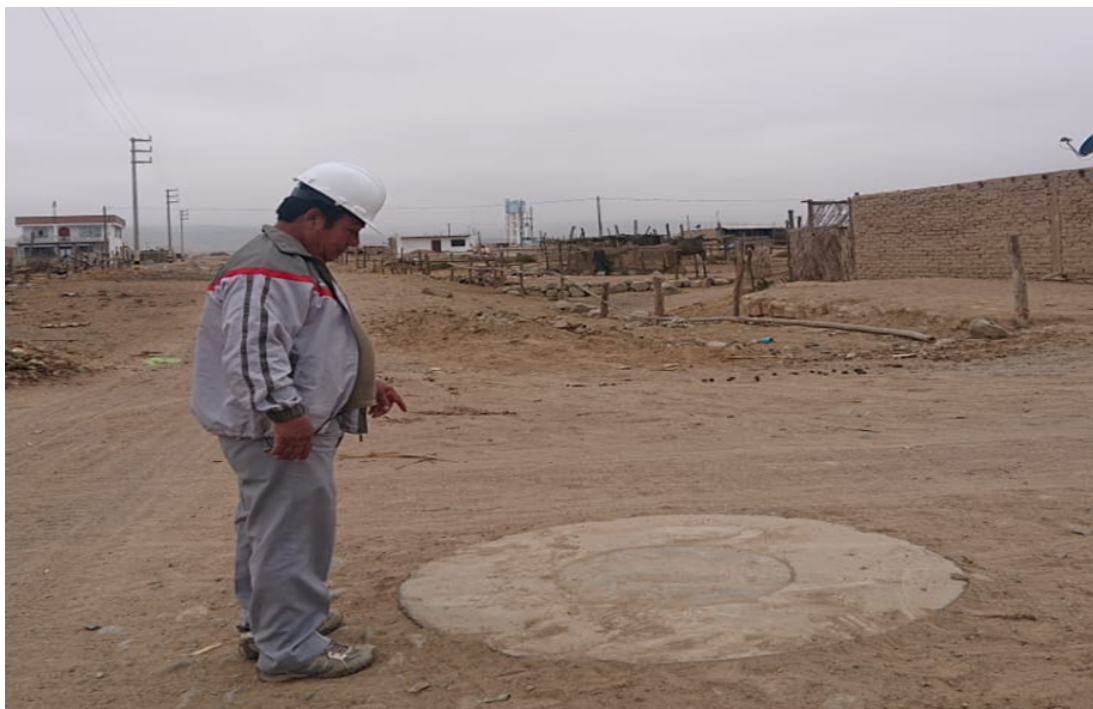
Figura 2.12: Buzón en estado de abandono. Fuente:(Municipalidad Distrital de Grocio Prado, 2019).
