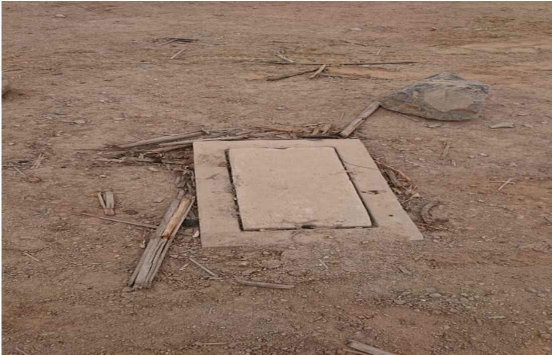
Figura 2.6: Válvula de paso en estado de abandono.
