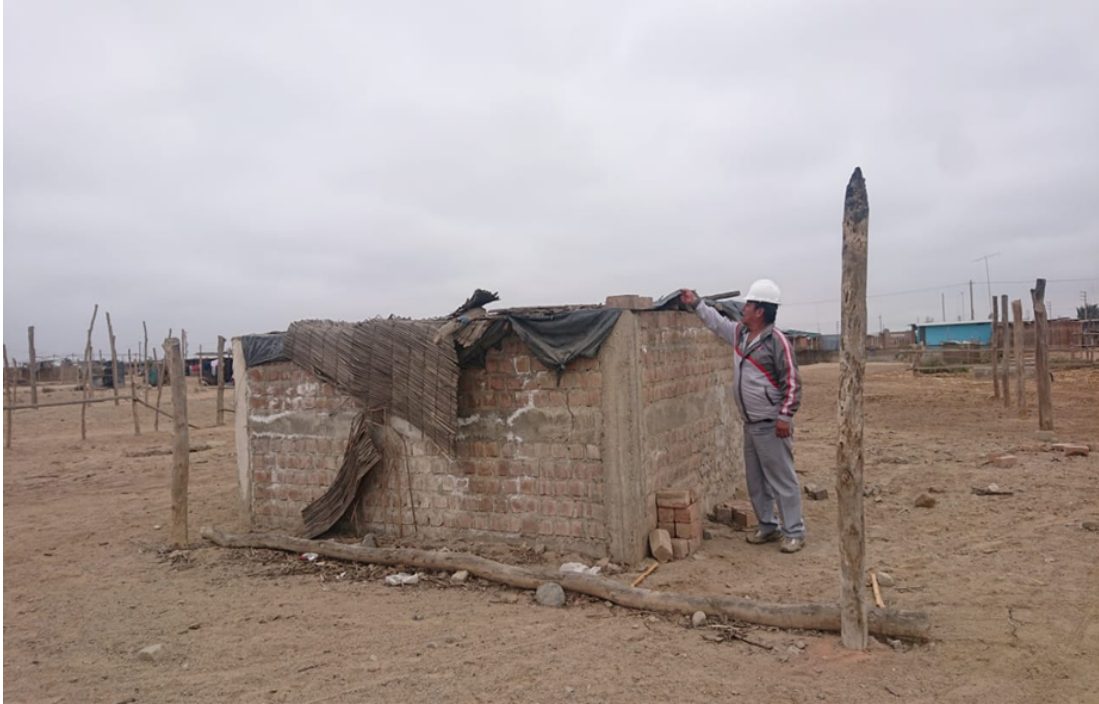
Figura 2.5: El reservorio de almacenamiento. Fuente:(Municipalidad Distrital de Grocio Prado, 2019).
