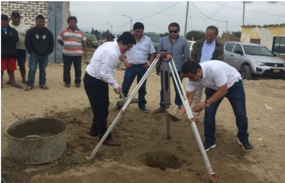
Fotografía 14: Colocación de la primera piedra para la ejecución de agua potable y alcantarillado en la comunidad de Villa Sol.
