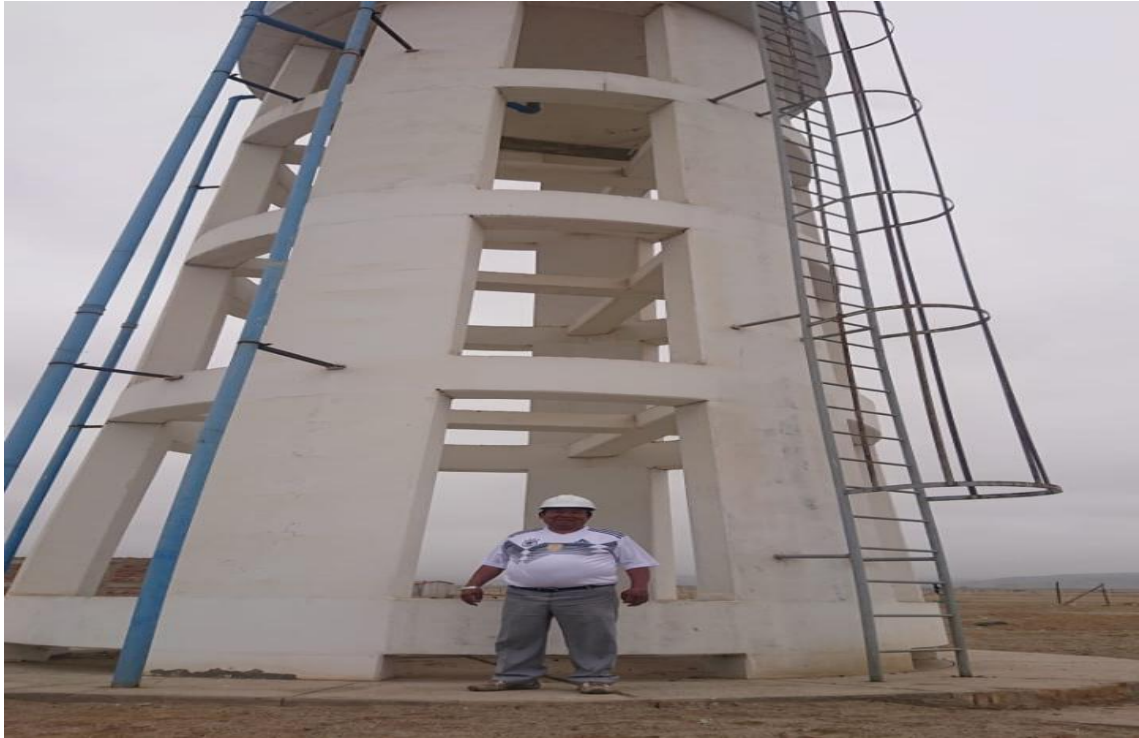
Fotografía 01: Vista frontal del reservorio elevado de la comunidad de Villa Sol.
