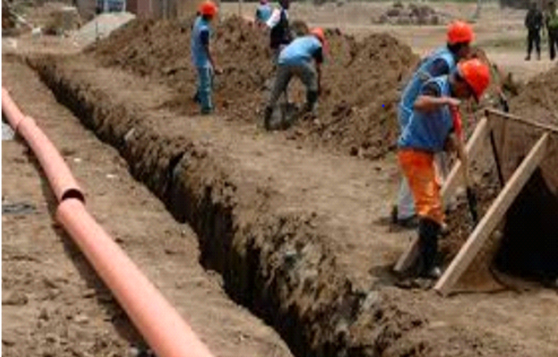
Figura 2.10: Conexión domiciliaria Fuente:(Municipalidad Distrital de Grocio Prado, 2019).
