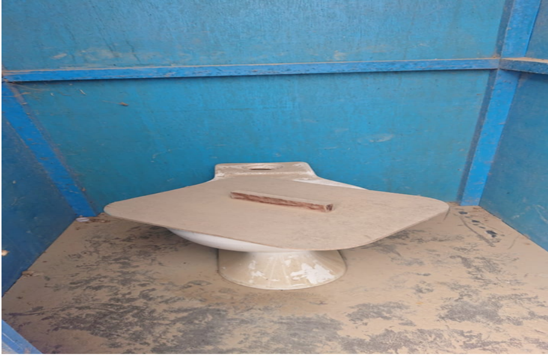
Figura 2.9: Baño con arrastre hidráulico en estado de abandono.
