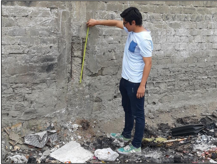
Fotografía 11. Columna afectada por corrosión, presentada en la unidad muestral 03 con un porcentaje de afectación de 21.26% y un nivel de severidad alto.
