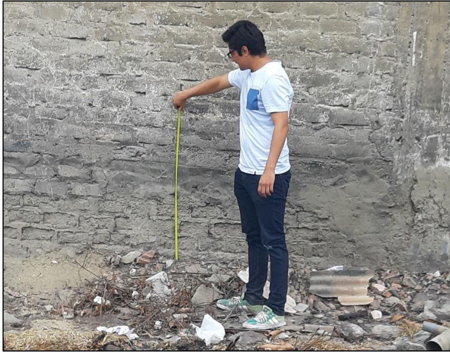
Fotografía 05. Muro afectado por erosión físico- químico presentado en la unidad muestral 04 con un porcentaje de afectación de 18.45% y con un nivel de severidad moderado.
