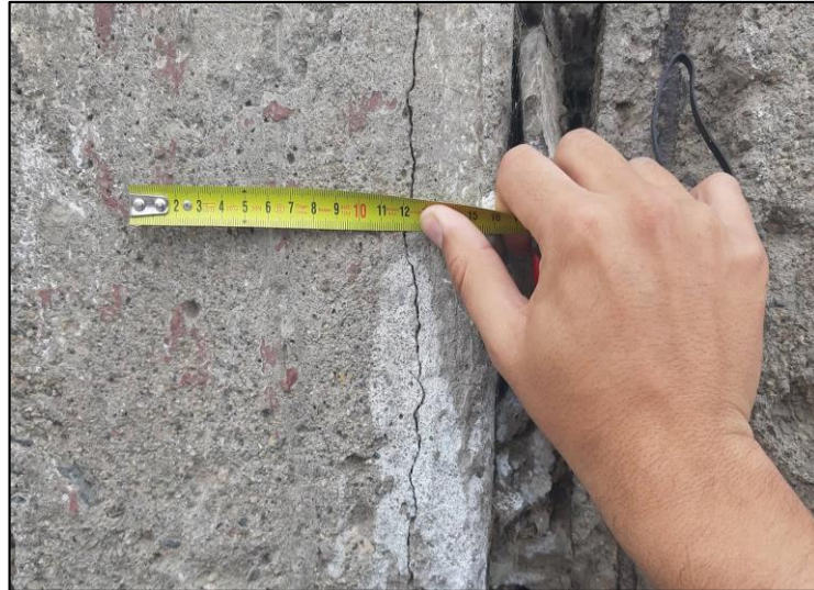
Figura 21. Aparición de fisura en muro de albañilería. Nota. Fuente: Elaboración propia (2019).
