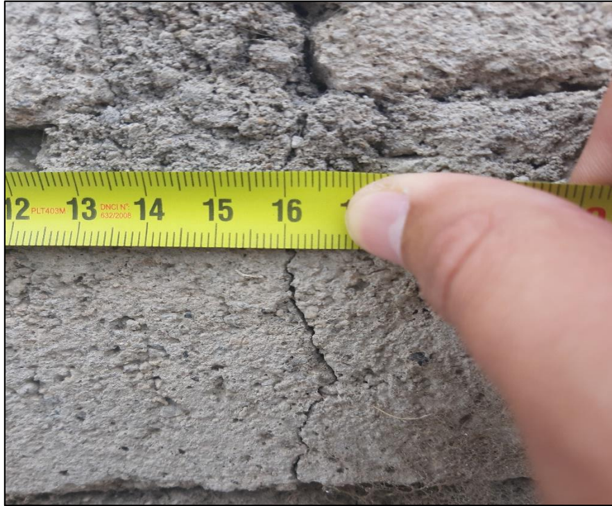
Fotografía 09. Columna afectada por fisura presentada en la unidad muestral 27 con un ancho de abertura de 0.30 mm y un nivel de severidad moderado, se tomó la medida con Wincha.
