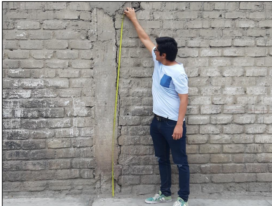
Fotografía 10. Toma de medida longitudinalmente de grieta presentado en la unidad muestral 33, con una longitud de 1.90m de forma vertical.
