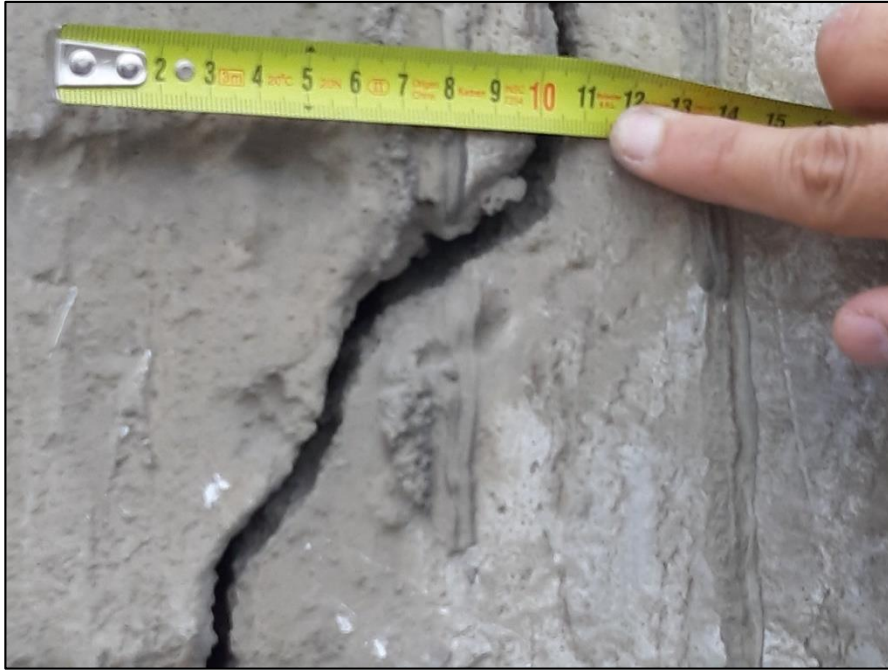
Fotografía 07. Muro afectado por grieta presentado en la unidad muestral 35 con un ancho de abertura de 7.50 mm y un nivel de severidad alto, se tomó la medida con Wincha.
