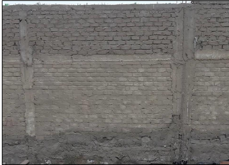
Figura 23. Desprendimiento en muro de albañilería. Nota. Fuente: Elaboración propia (2019).
