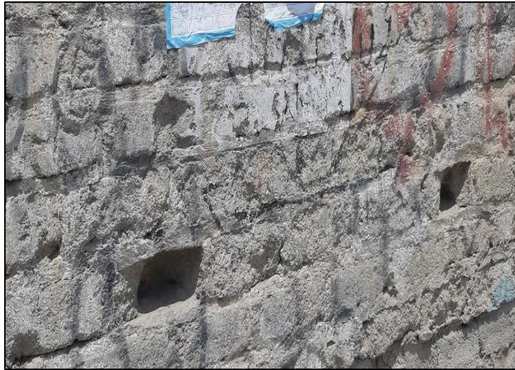
Figura 24. Aparición de erosión mecánica en muro de albañilería.
