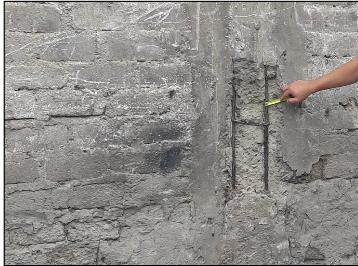
Figura 26. Corrosión en columna de concreto. Nota. Fuente: Elaboración propia (2019).
