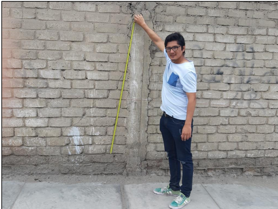
Fotografía 08. Toma de medida longitudinalmente de grieta presentado en la unidad muestral 35, con una longitud de 2.10m de forma diagonal.
