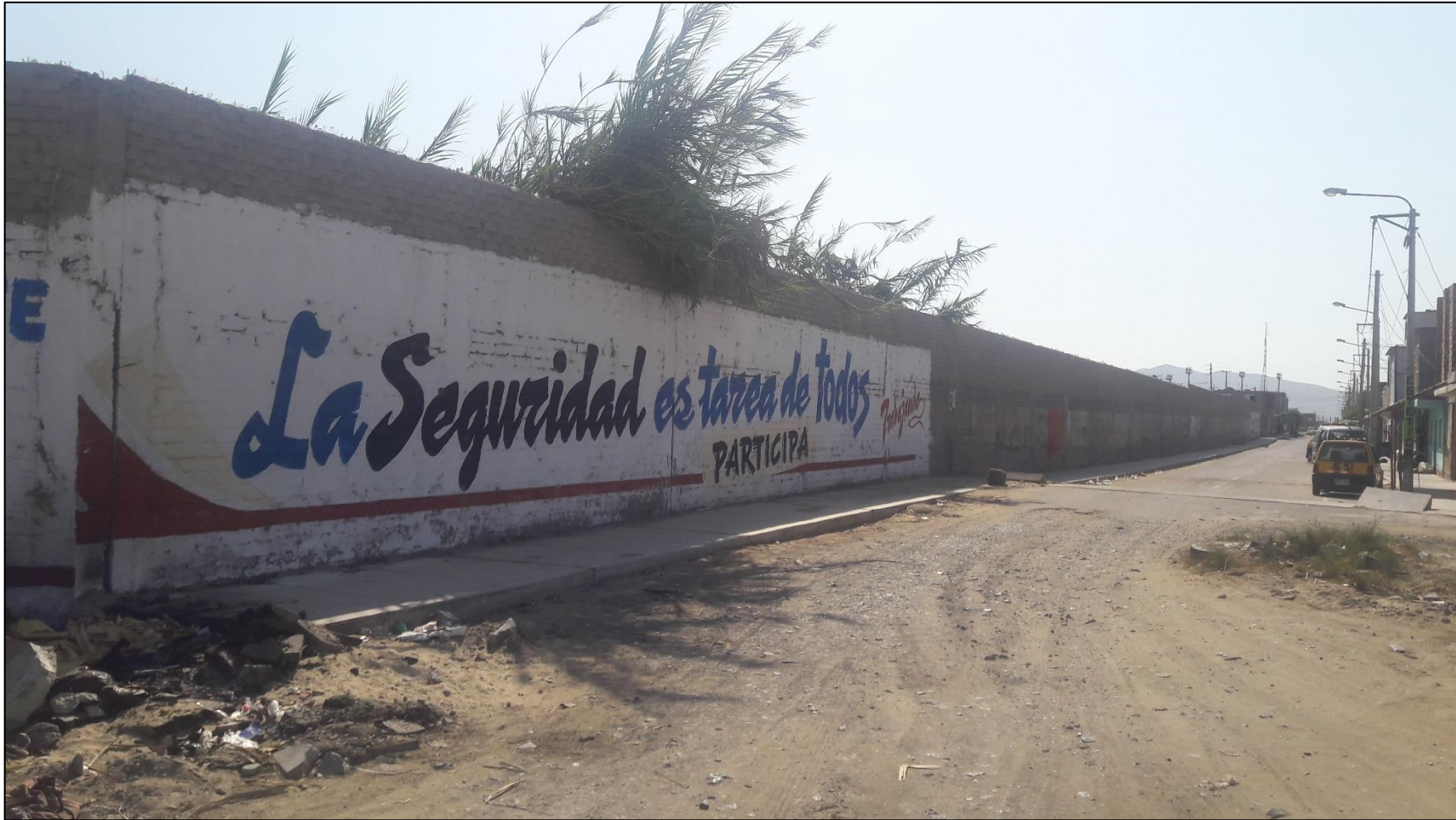
Fotografía 04. Vista del cerco de albañilería del tramo 3-4 del C.E.B.E Fé y alegría 42 del distrito de Chimbote, provincia del Santa, región Áncash.
