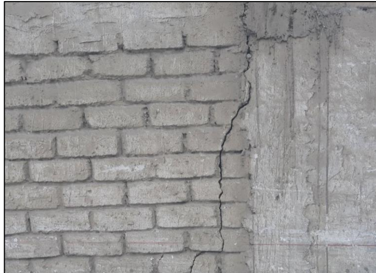
Figura 22. Aparición de grieta en forma diagonal en muro de albañilería.
