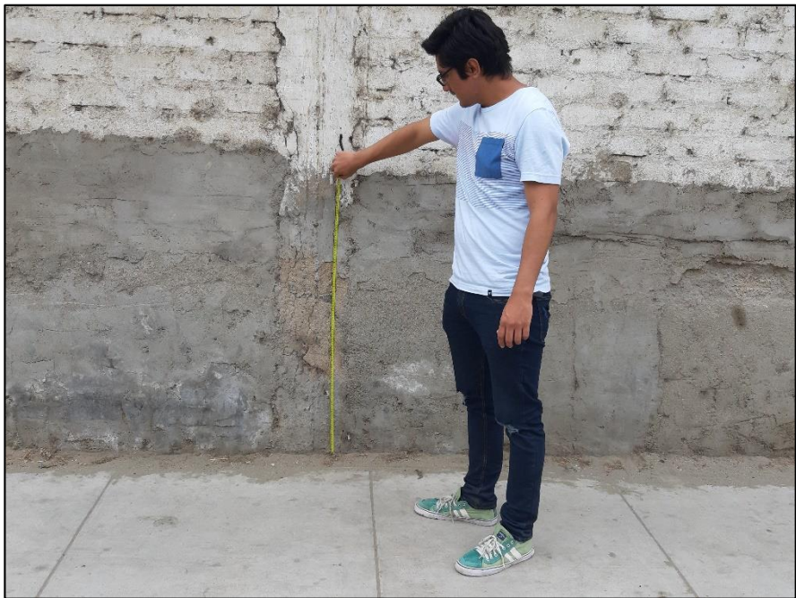
Fotografía 12. Columna afectada por desprendimiento en la unidad muestral 22, con un área afectada de 37.10% y un nivel de severidad alto.
