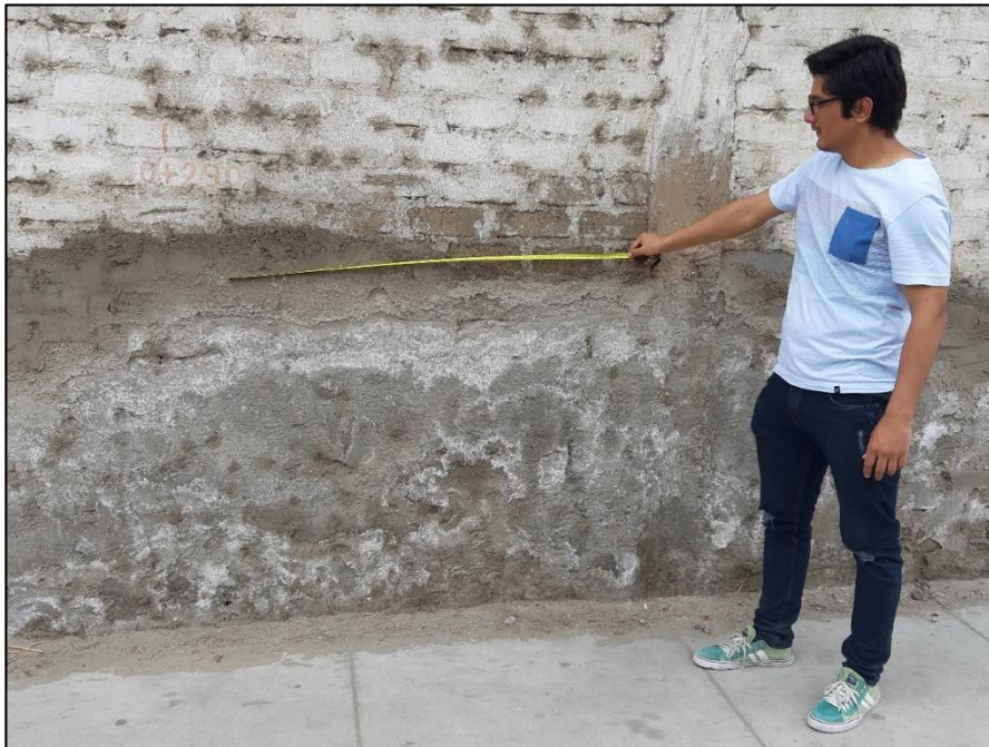
Fotografía 14. Muro afectado por eflorescencia presentado en la unidad muestral 23, con un área de capa fina y un nivel de severidad moderado.
