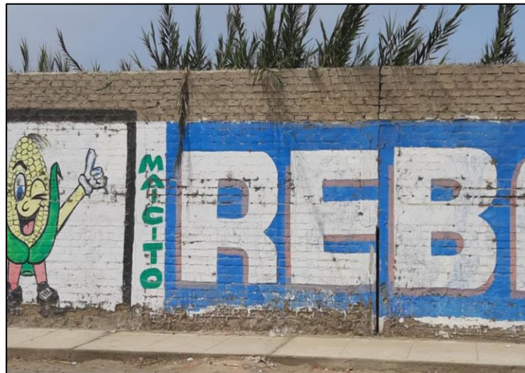
Figura 20. Aparición de erosión física en muro de albañilería.
