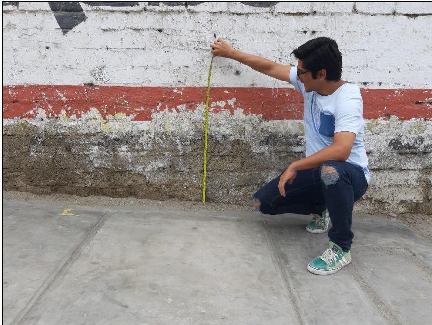
Fotografía 13. Muro afectado por eflorescencia presentado en la unidad muestral 36, con un área de capa oscura y un nivel de severidad alto.
