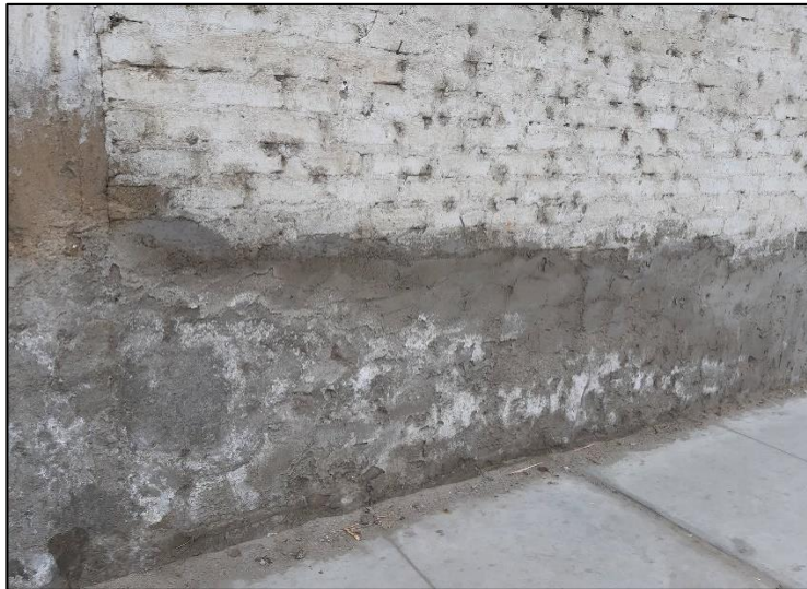
Figura 25. Aparición de eflorescencia en muro de albañilería.
