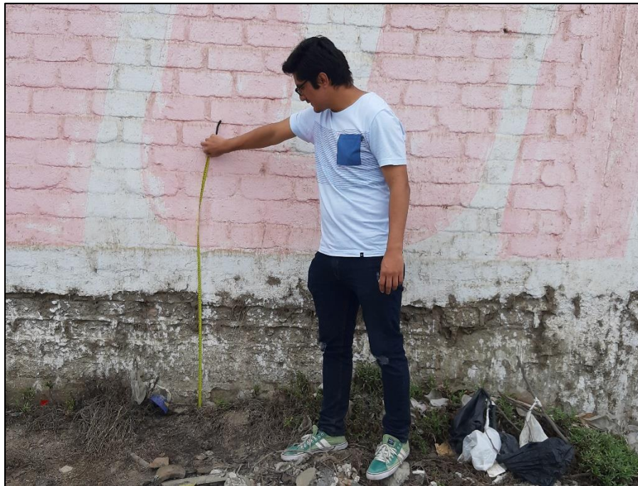
Fotografía 06. Muro afectado por erosión físico- químico presentado en la unidad muestral 11 con un porcentaje de afectación de 13.52% y con un nivel de severidad moderado.
