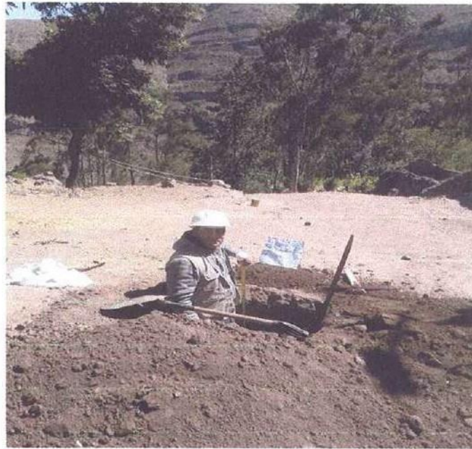
Foto N° 05.- Se aprecia en detalle la profundidad de la calicata C-05 y en la parte superficial material orgánico.
