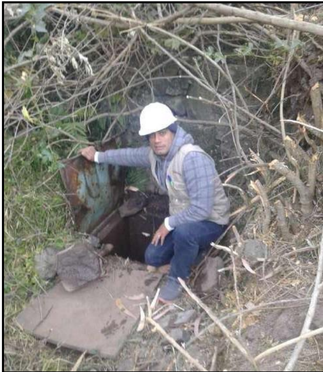
Figura 26: Foto cámara de captación deteriorada
