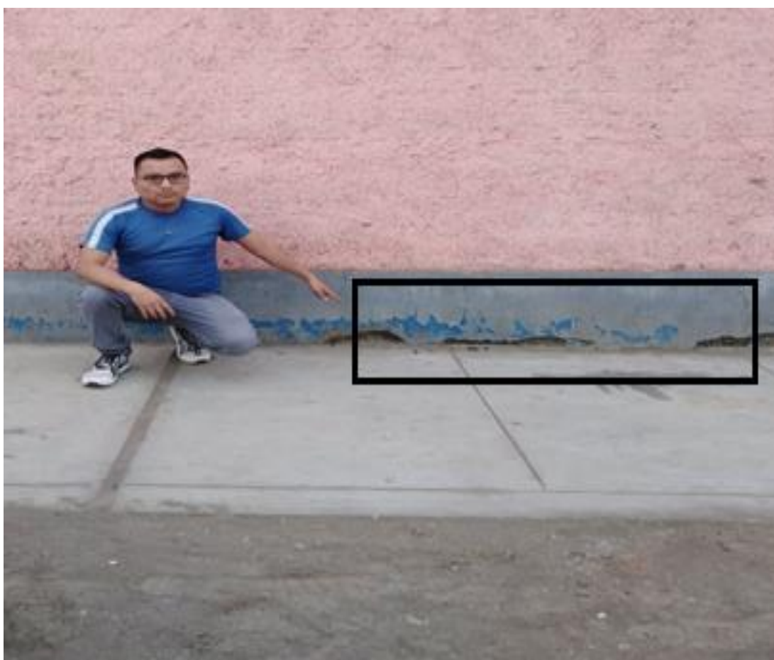
Fotografía 5: Patología Erosión en sobrecimientos en la Unidad de Muestra 5
