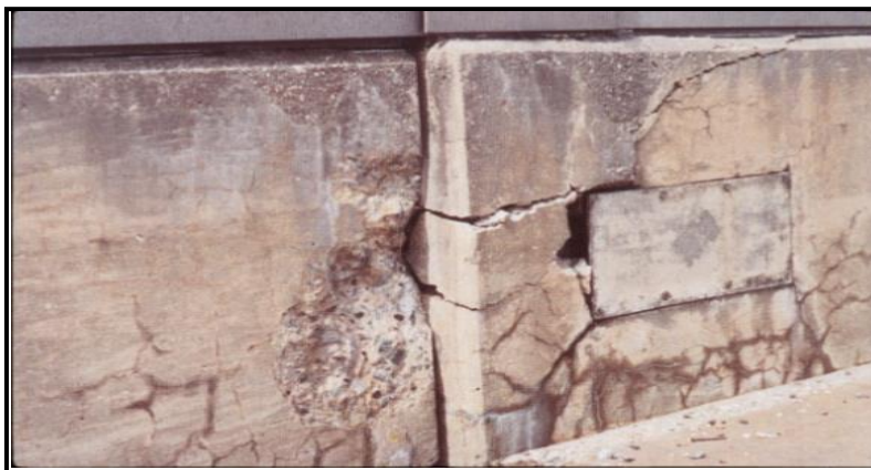
Figura 18: Distorsión en muro.
