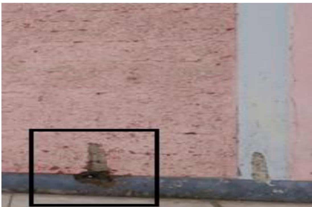
Fotografía 11: Patología Desintegración en sobrecimiento y muro en la Unidad de Muestra 2
