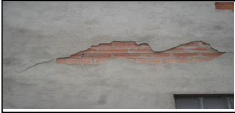
Figura 15: Desprendimiento de revestimiento en muro.
