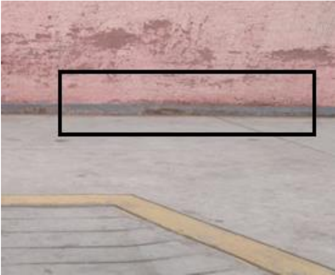
Fotografía 14: Patología Eflorescencia en columnas, muros y sobrecimientos en la Unidad de Muestra 1
