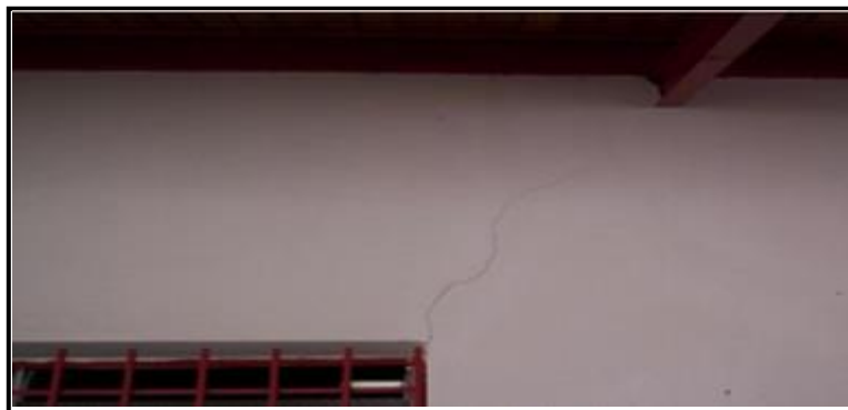
Figura 14: Fisura en muro.
