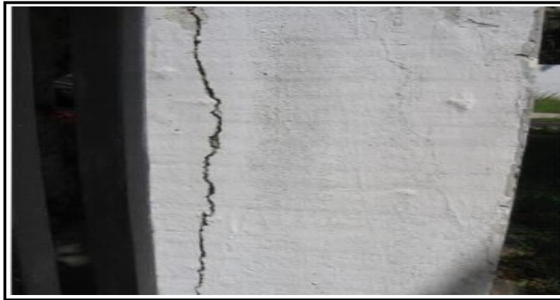
Figura 16: Grieta en columna.
