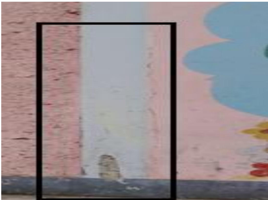
Fotografía 10: Patología Grieta en columna en la Unidad de Muestra 2
