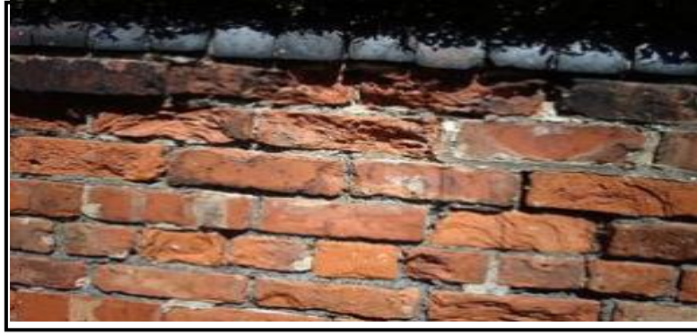
Figura 13: Erosión en muro.
