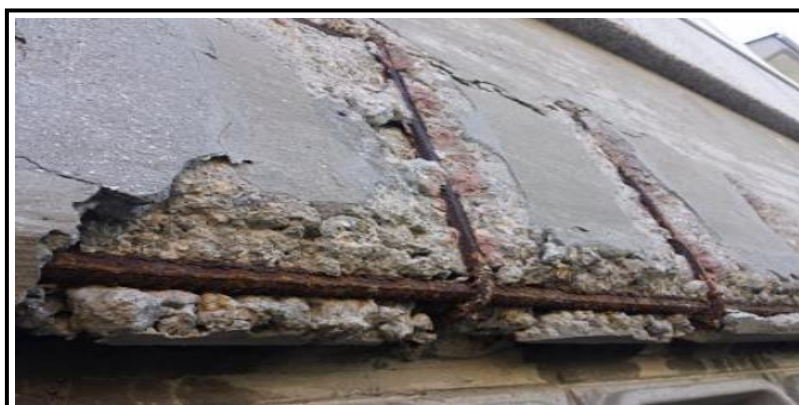
Figura 19: Corrosión del acero.
