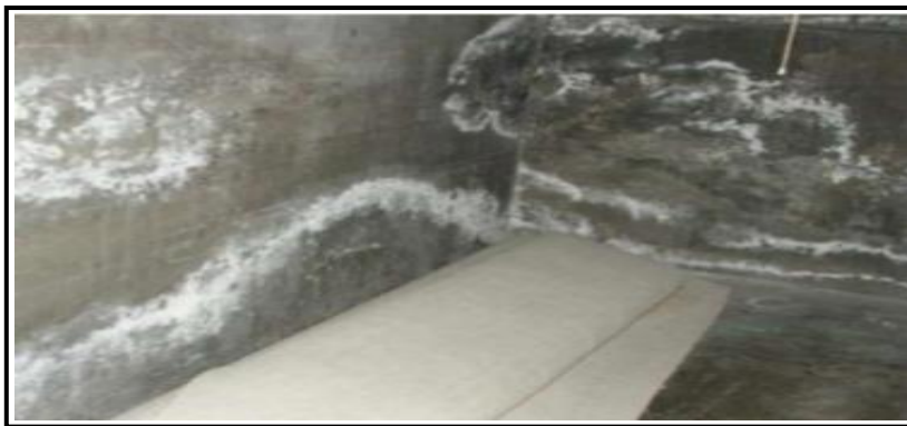
Figura 20: Eflorescencia en muro.
