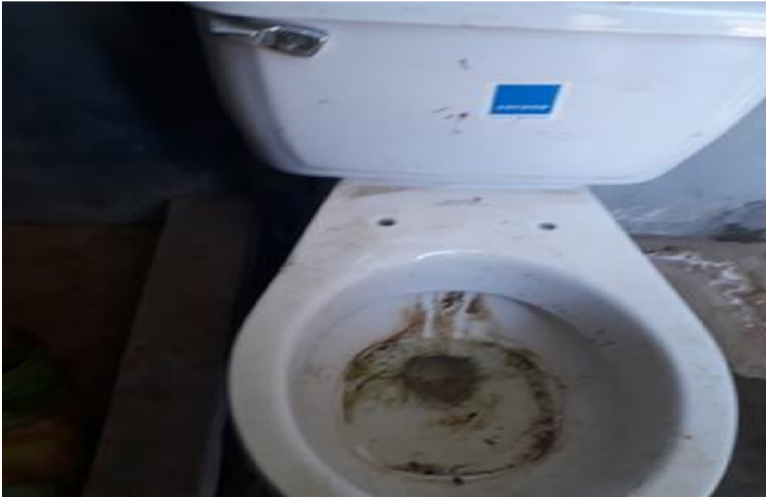
Figura 2.2: Baño con arrastre hidráulico en pésimo estado de higiene y conservación.
