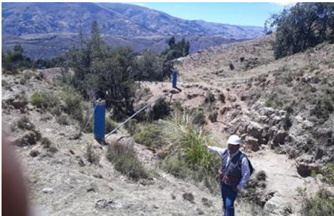
Figura 2.5: Cruce aéreo de línea de conducción.
