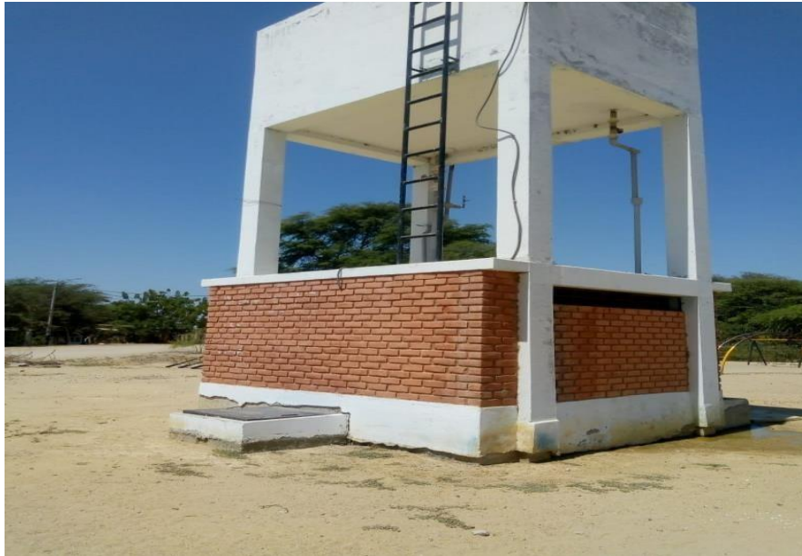
Ilustración 34. Reservorio Elevado 10m 3
