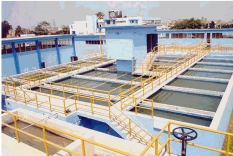
Ilustración 6. Planta de tratamiento
