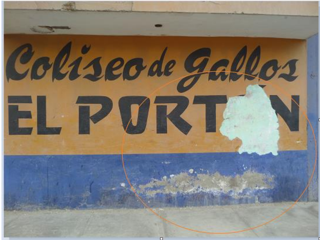
Fotografía 08: Patología eflorescencia en el muro.
