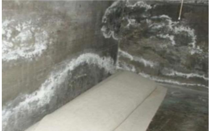
Gráfico 26: Imagen de eflorescencia en muro.
