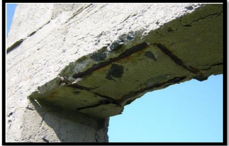
Gráfico 27: Imagen de corrosión en una viga.
