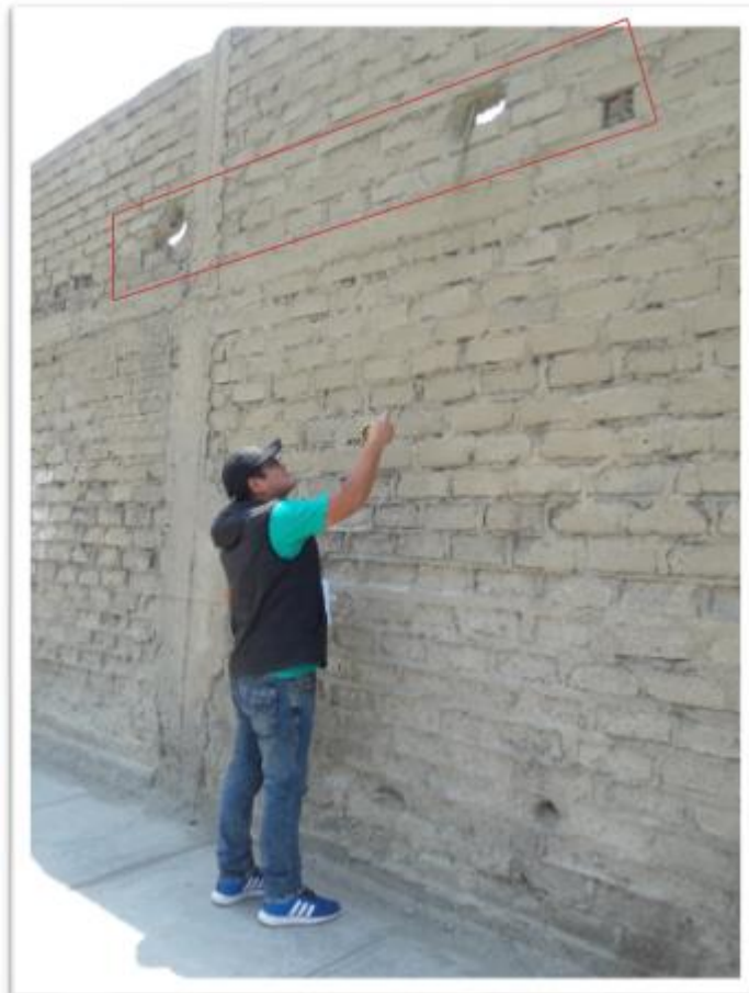
Fotografía 05: Patología Erosión Mecánica en Muros. Nota. Fuente: Elaboración propia (2019)
