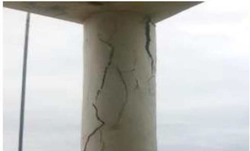
Gráfico 21: Imagen de Grieta en una columna circular.
