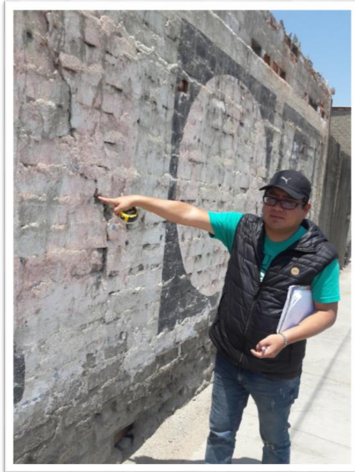
Fotografía 03: Patología Grieta en muro.
