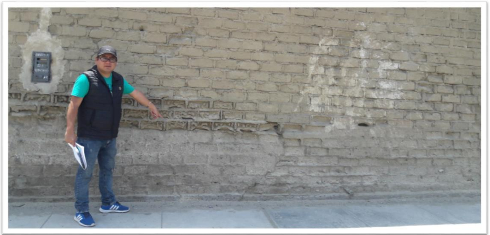
Fotografía 02: Patología Erosión Física en muro (patología más frecuente en todas las Unidades de Muestra)
