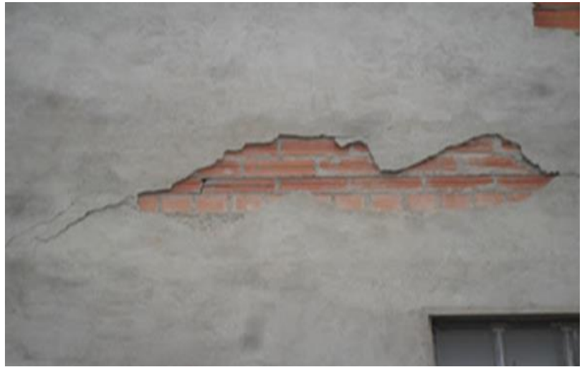
Gráfico 23: Desprendimiento de revestimiento en muro.
