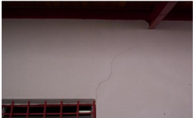
Gráfico 22: Fisura en muro.
