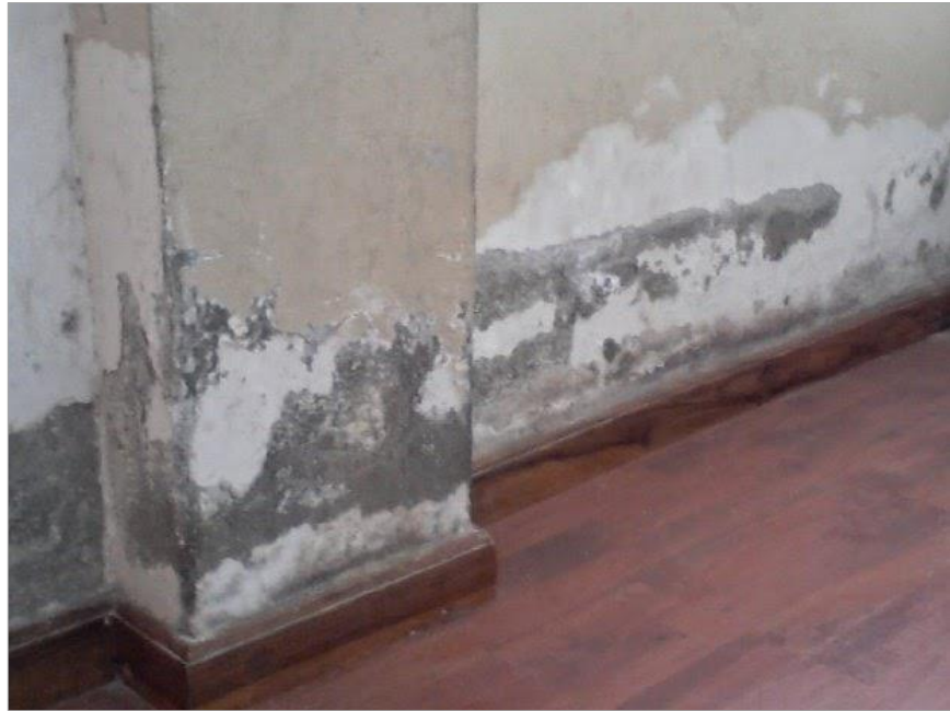
Gráfico 15. Fotografía de eflorescencia en muro Fuente: El maestro de casas (2011)
