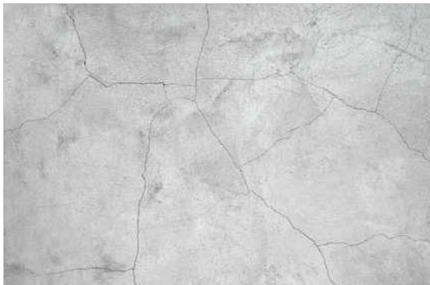
Gráfico 10. Vista de fisura en muro Fuente: Mundo Ark (2013)
