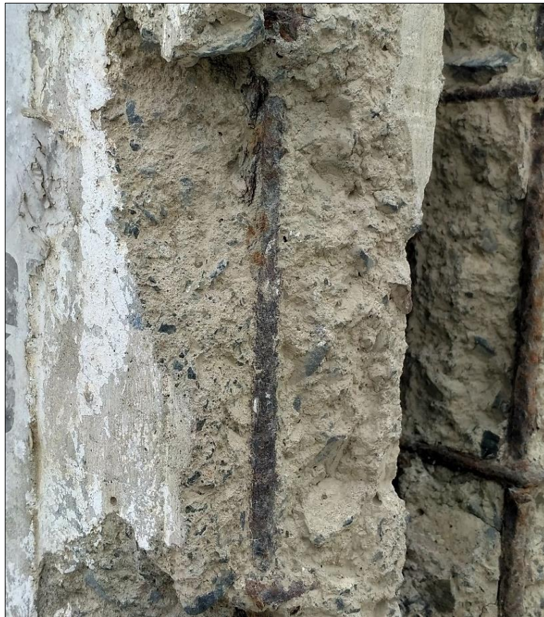
Gráfico 16. Fotografía de corrosión en columna Fuente: Elaboración propia (2019)
