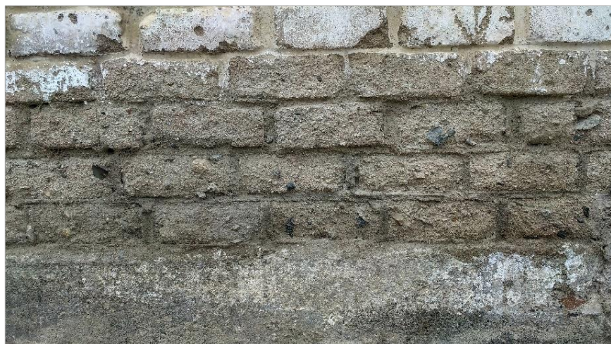
Gráfico 14. Fotografía de erosión mecánica en muro Fuente: Elaboración propia (2019)
