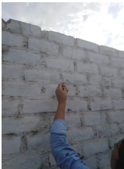
Gráfico 15: Grieta en muro. Fuente: Elaboración propia.
