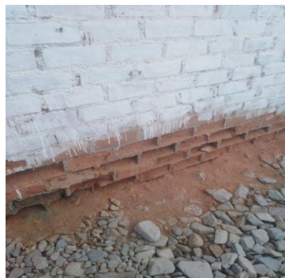
Gráfico 18: Erosión en muro. Fuente: Elaboración propia.
