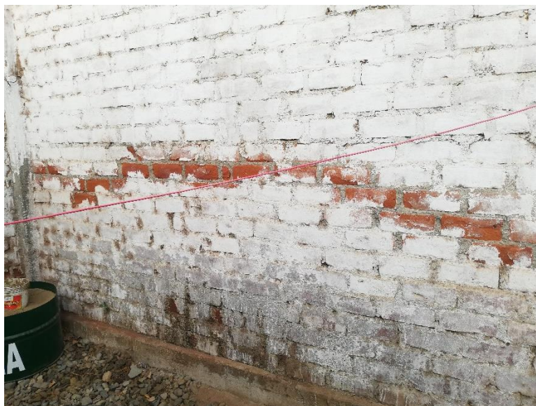
Gráfico 17: Eflorescencia en muro.
