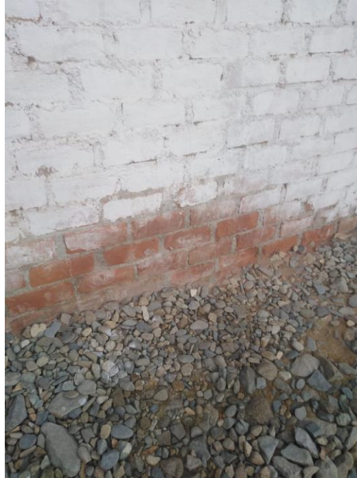
Gráfico 16: Desprendimiento en muro. Fuente: Elaboración propia.
