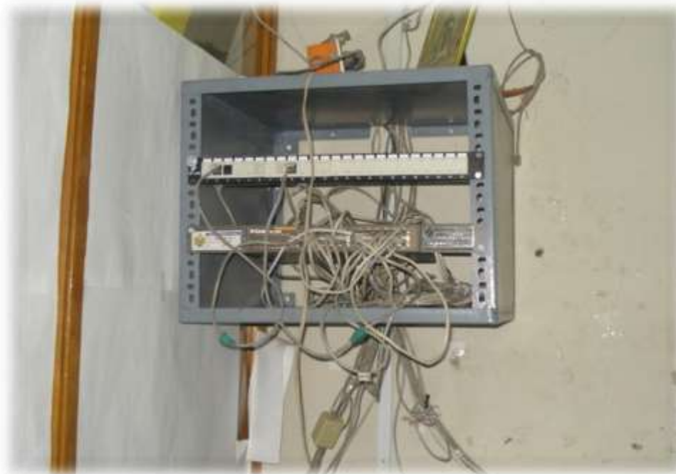
Fotografía N° 1: Switch Repartidor del Segundo Piso
