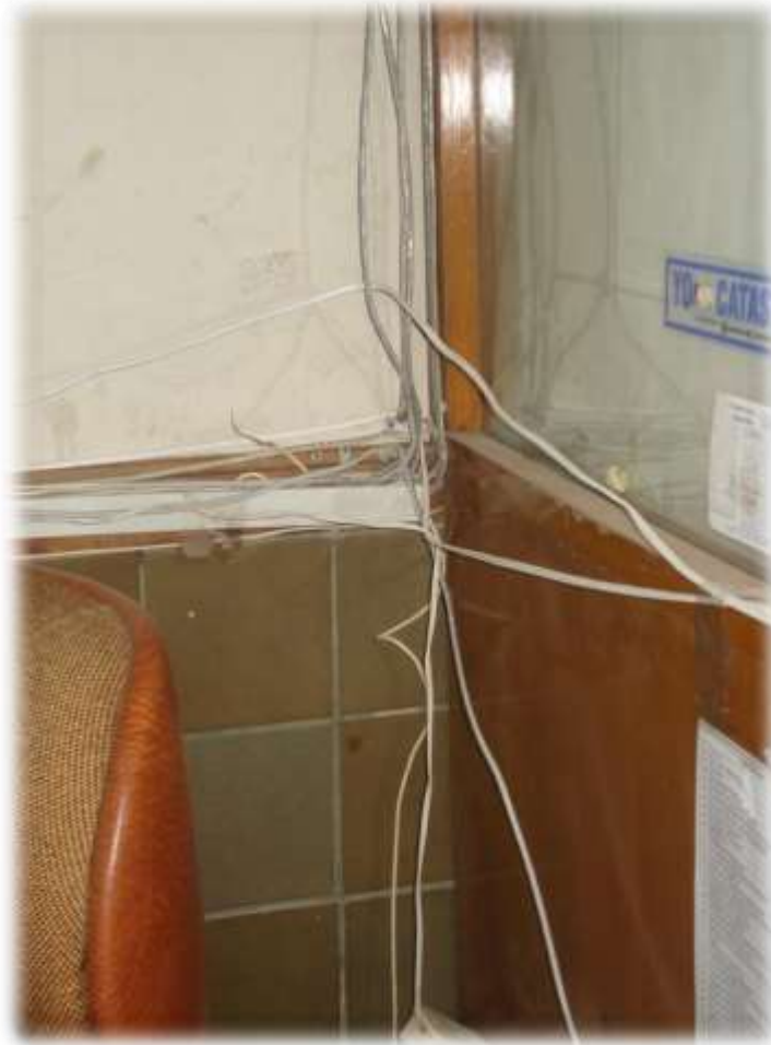
: Cableado en mal estado Fotografía N° 3
