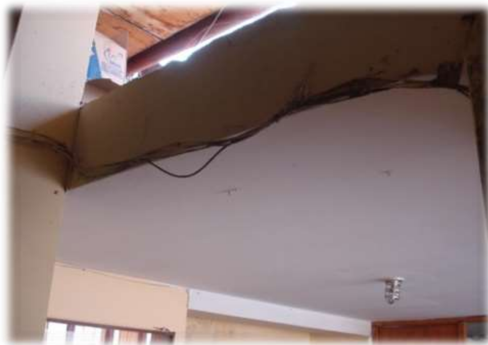
Fotografía N° 5: Cableado en mal estado
