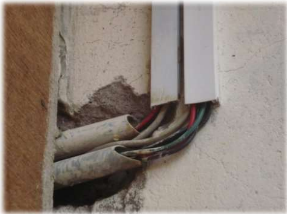
Fotografía N° 13: Cables Suelos y Mezclados con cables de Energía Eléctrica
