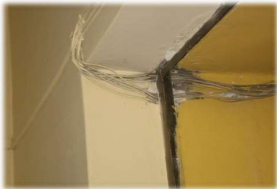
Fotografía N° 9: Cableado en mal estado
