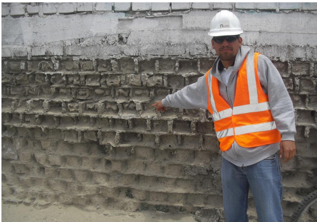
Figura 22: Imagen donde se aprecia la patología de erosión química en el muro.
