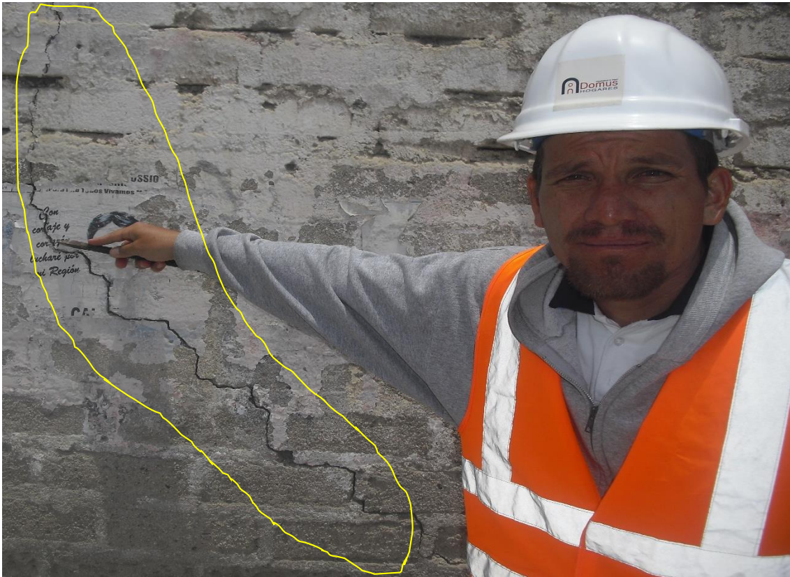
Figura 20: Imagen donde se aprecia una grieta en el muro
