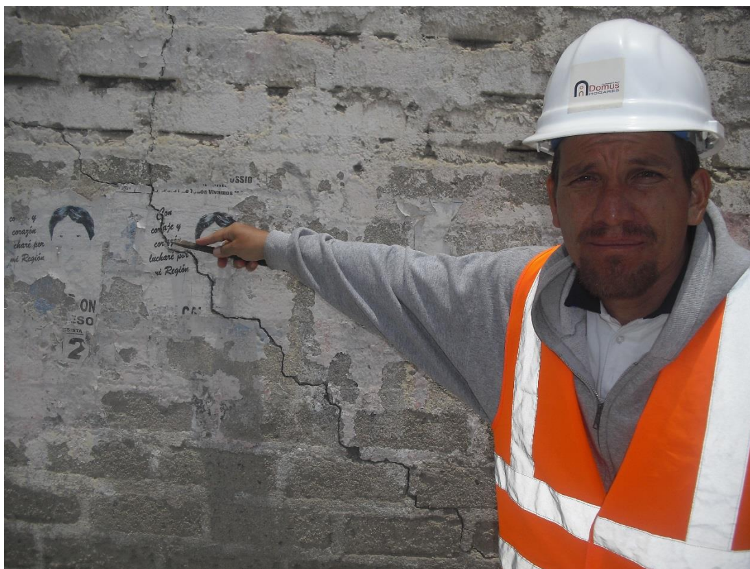
Figura 18: Se aprecia la patología de grieta en el elemento de muro de la unidad de muestra 08
