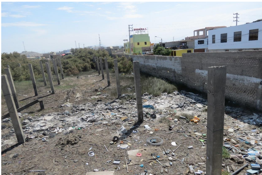
Figura 16: Una foto panorámica interior del mal estado de la estructura del cerco perimétrico, y apreciando el mal estado de la superficie donde brota la filtración de agua causada por el desborde de río Lacramarca.
