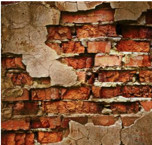
Figura 12: Imagen de erosión en muro
