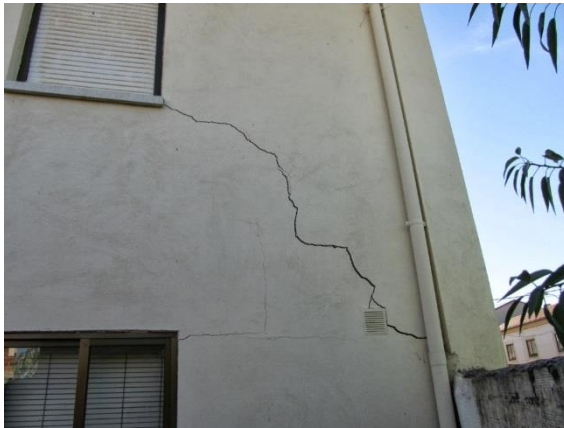
Figura 9: Imagen de grieta en muro
