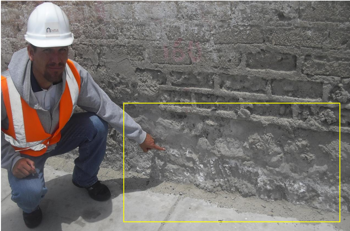
Figura 21: Imagen donde se aprecia la eflorescencia en el muro, con línea amarilla.
