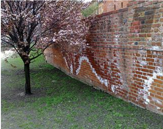
Figura 14: Imagen de eflorescencia en muros
