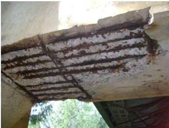
Figura 10: Imagen de corrosión en el acero
