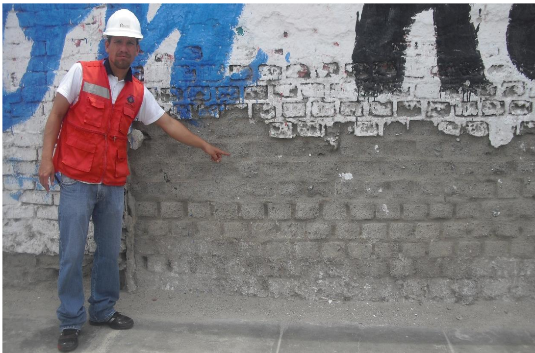
Figura 17: Se aprecian la patología de erosión en la unidad de muestra 07, en el elemento de muro.
