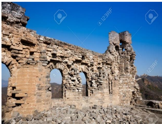
Figura 13: Imagen de desintegración en el muro
