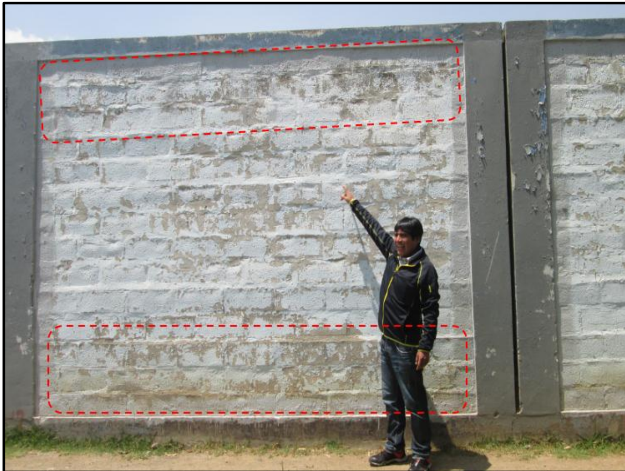
Fotografía 13: eflorescencia en paño 43.
