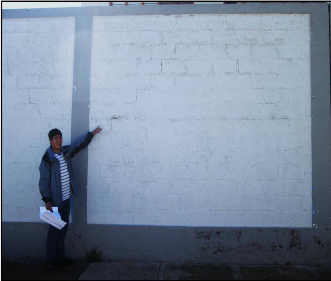
Fotografía 11: grieta en paño 26.
