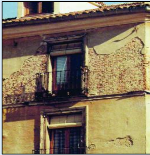
Figura 9: fotografía de desprendimiento.
