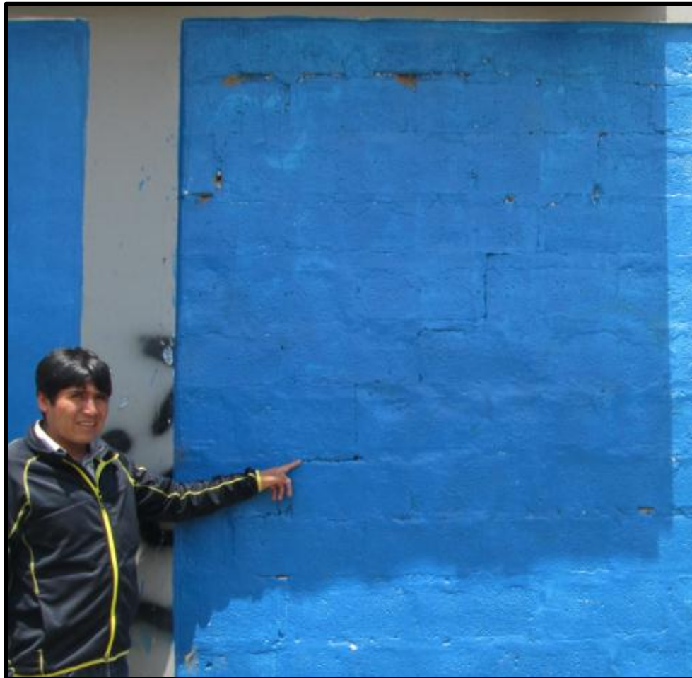
Fotografía 17: grieta en paño 66.
