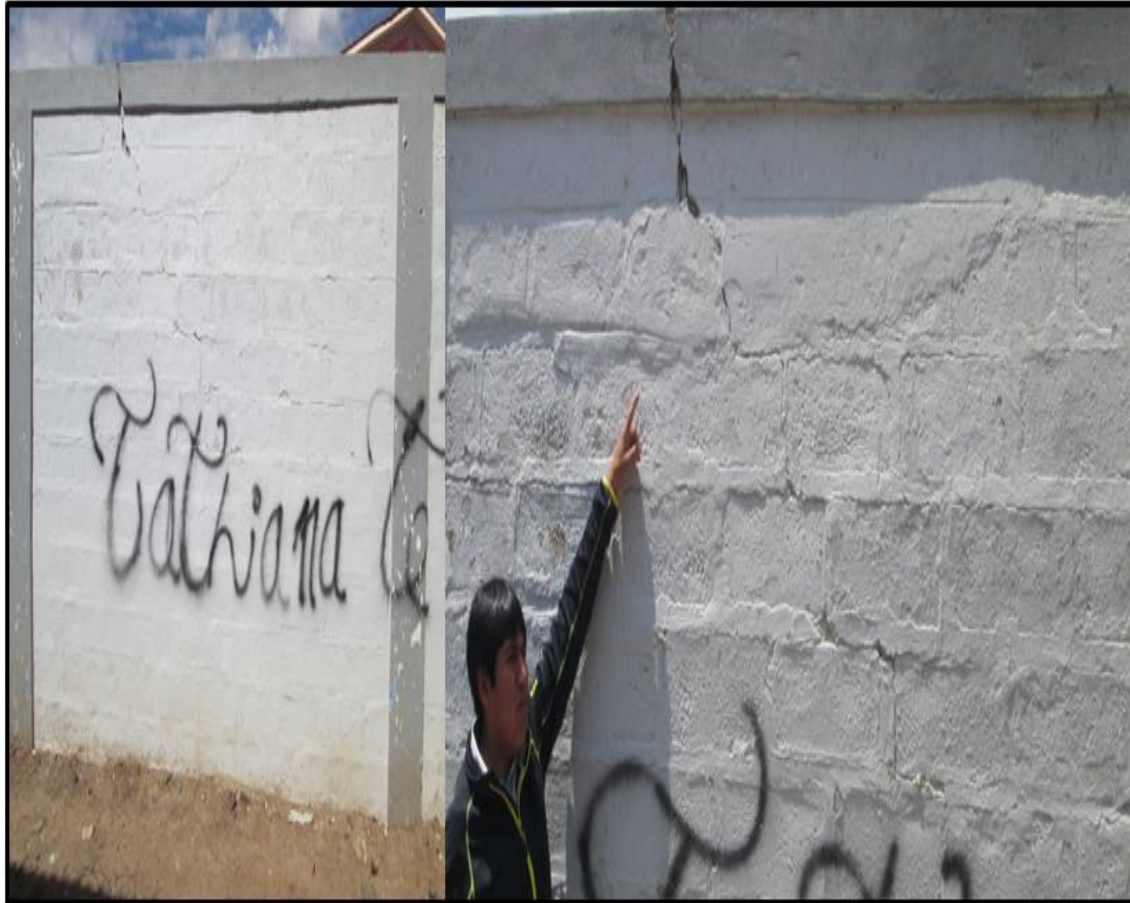
Fotografía 12: grieta en paño 35.
