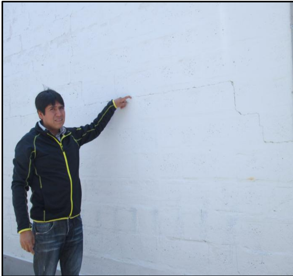
Fotografía 18: grieta en paño 25.
