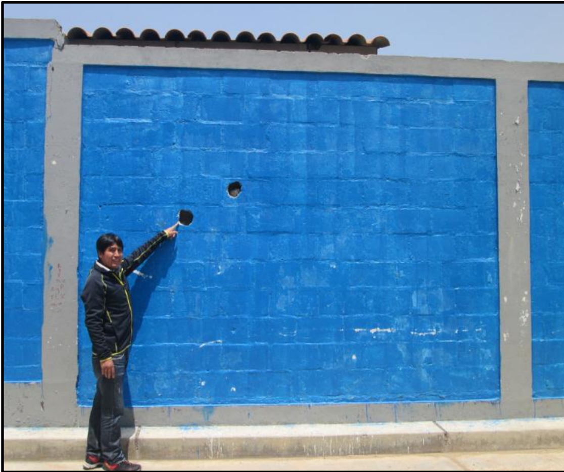
Fotografía 15: erosión mecánica en paño 49.
