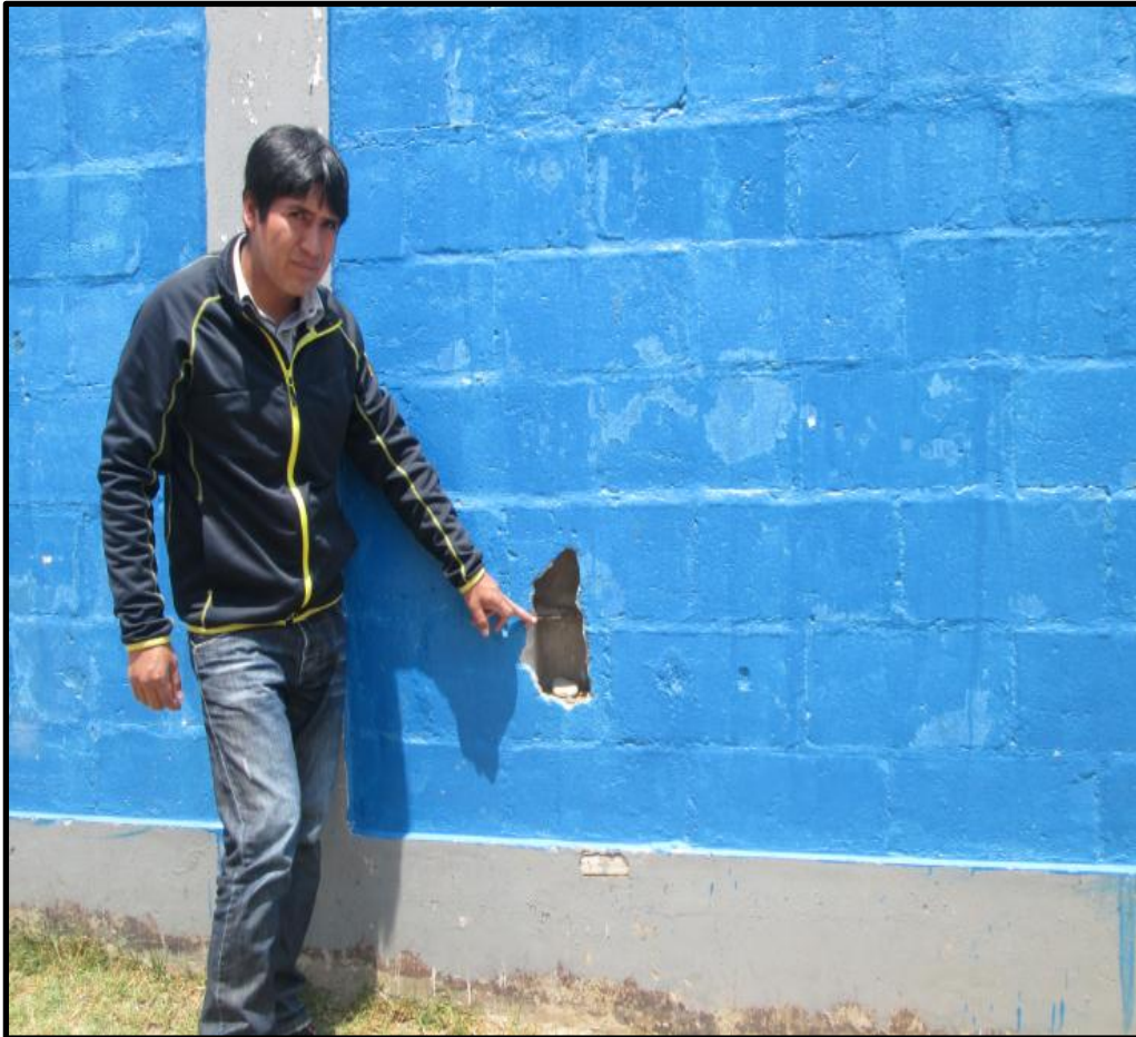
Fotografía 16: erosión mecánica en paño 52.
