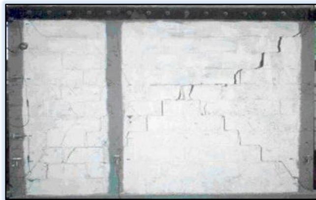
Figura 5: daño estructural moderado a severo
