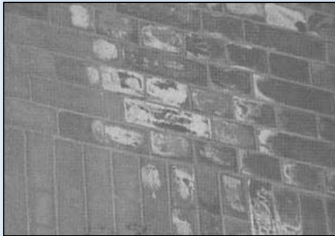
Figura 7: fotografía de eflorescencia.
