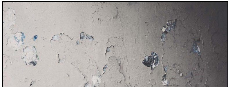
Figura 12. Imagen de desconchado de acabado.
