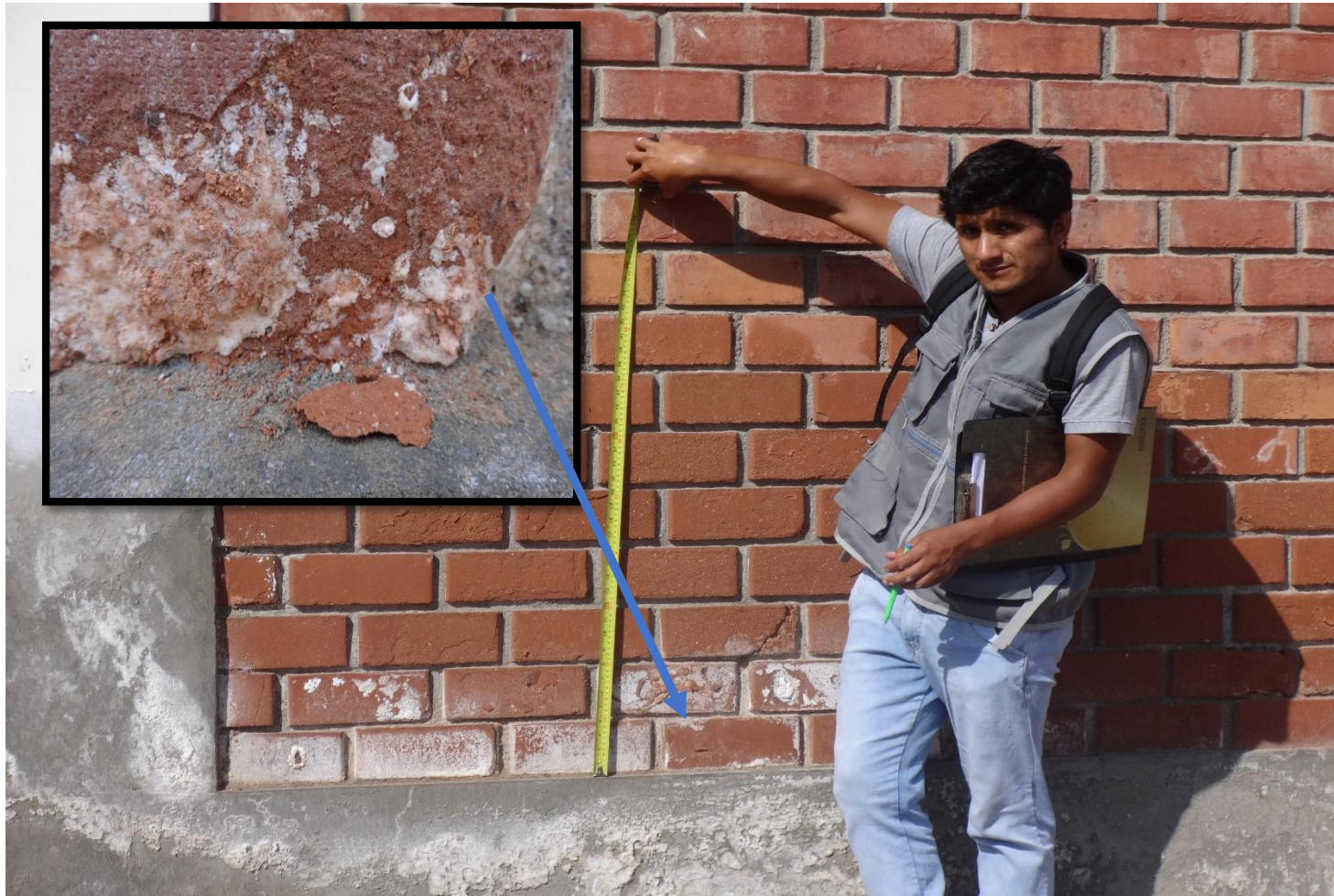
Figura 29. Fotografía de la patología criptoeflorescencia en el muro de la unidad muestral 16.
