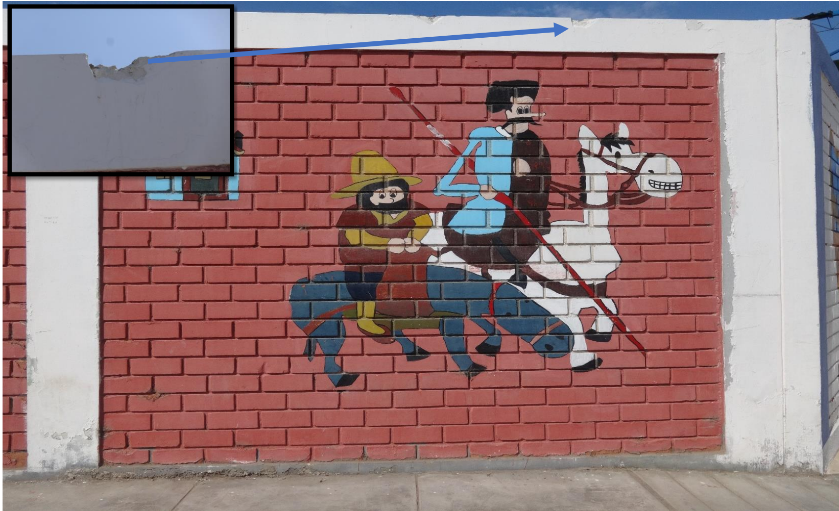
Figura 33. Fotografía de la patología desprendimiento en la unidad muestral 3.
