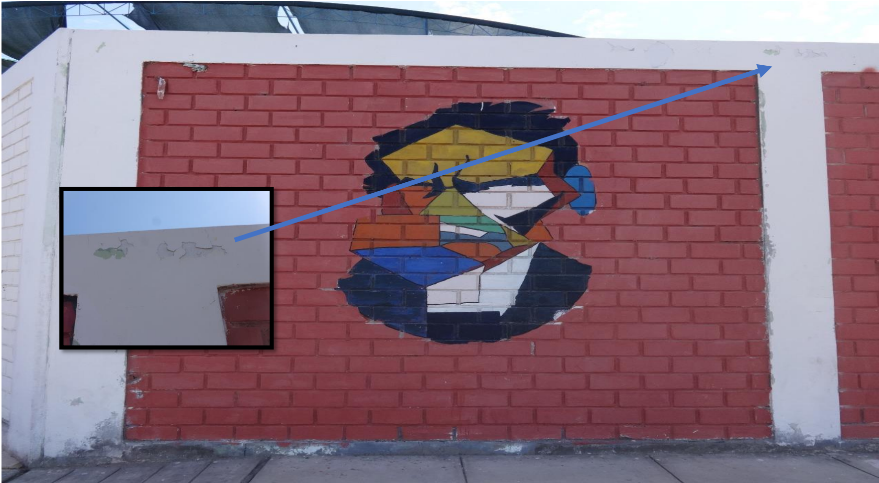
Figura 31. Fotografía de la Patología desconchado de pintura en vigas de la unidad muestral 2.
