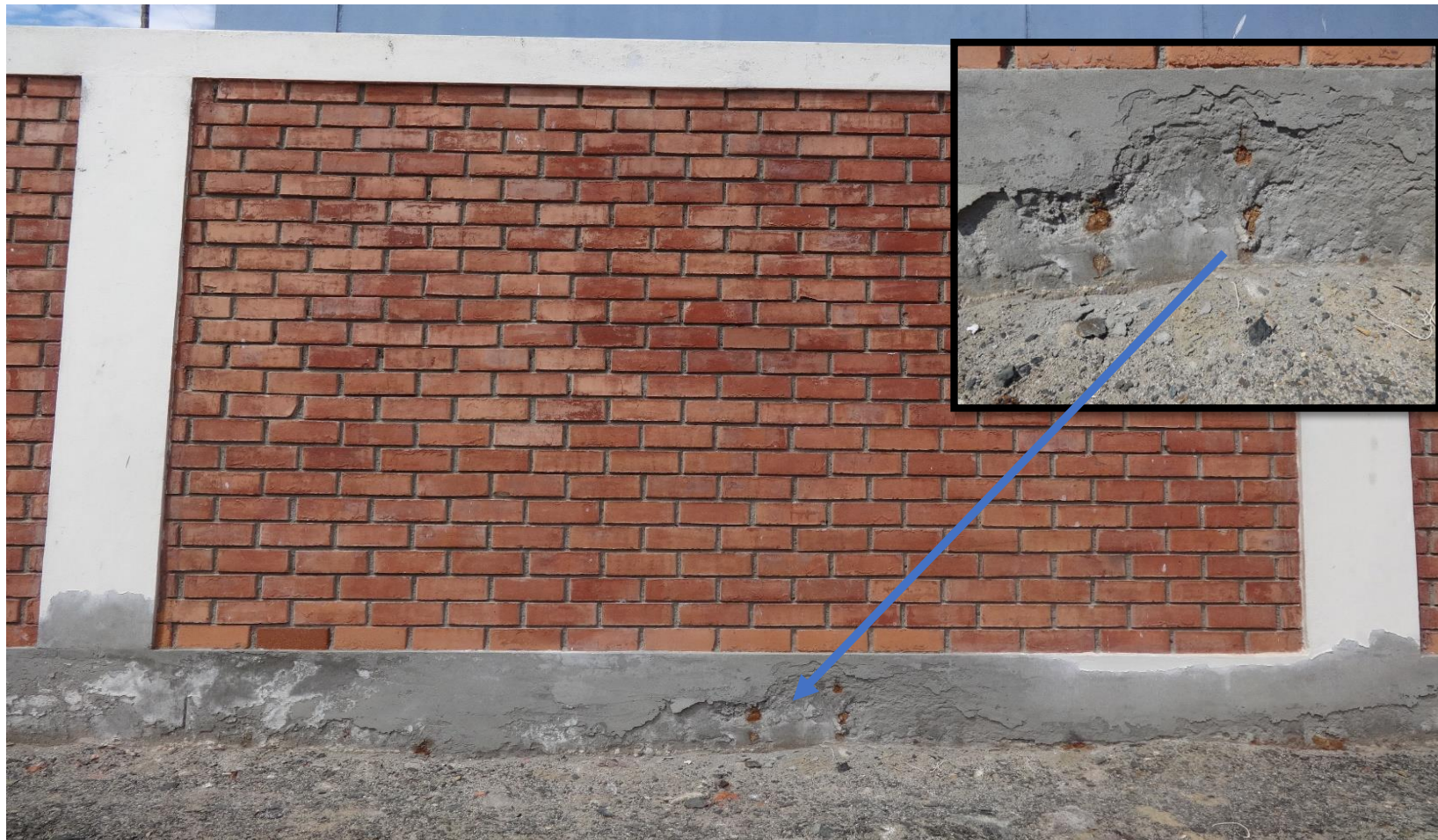
Figura 32. Fotografía de la patología corrosión en sobrecimiento de la unidad muestral 13.
