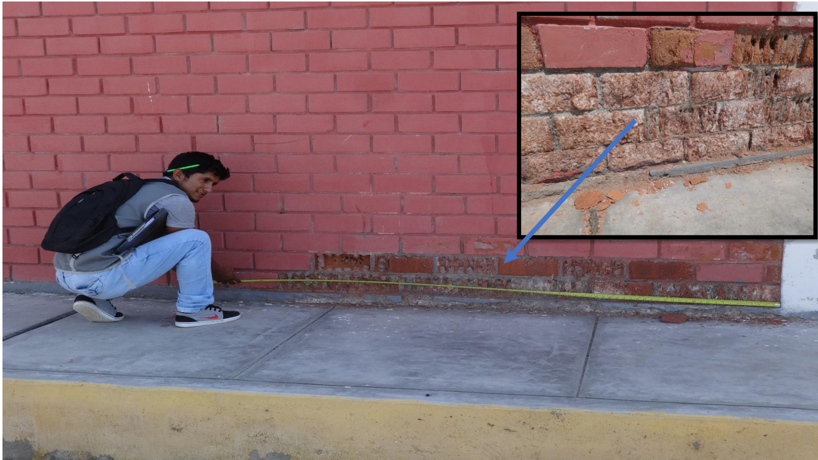
Figura 30. Fotografía de la patología erosión en muros de la unidad muestral 5.
