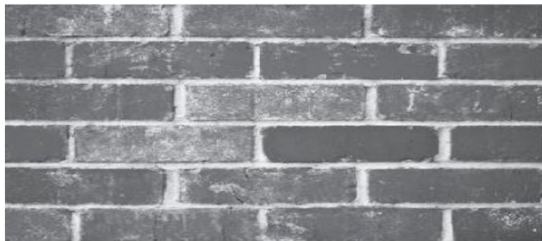
Figura 17. Imagen de eflorescencia en muros.
