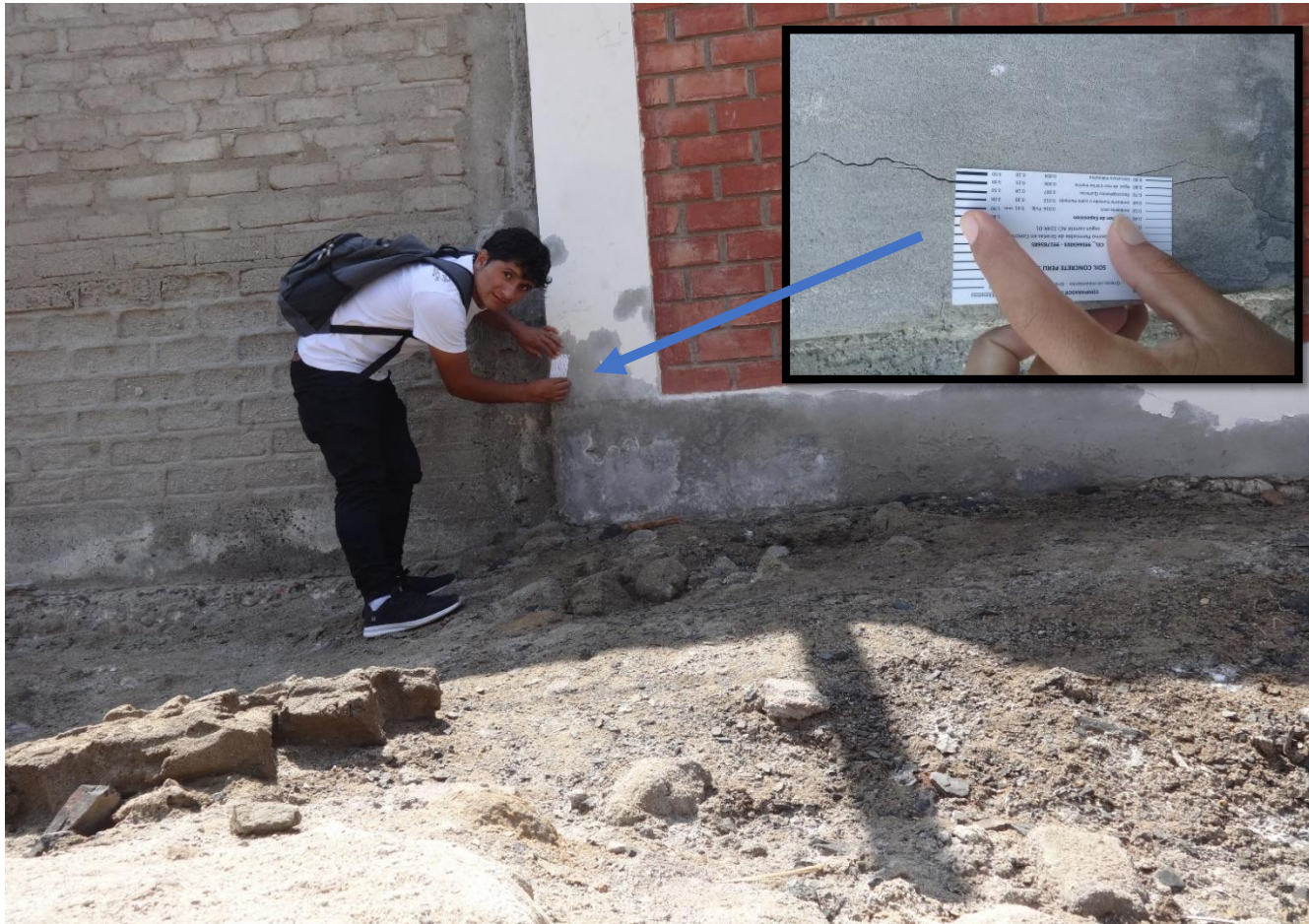
Figura 27. Fotografía de la patología grieta de columna en la unidad muestral 16.
