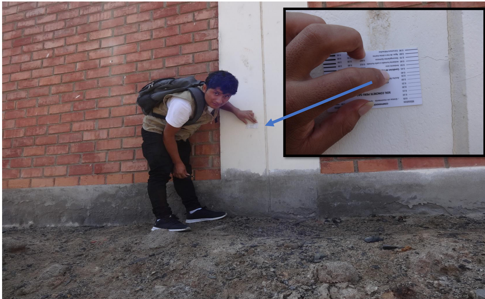
Figura 28. Fotografía de la patología fisura en tarrajeo de columna de la unidad muestral 15.
