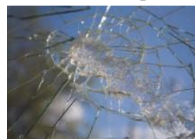
Ruptura del vidrio
