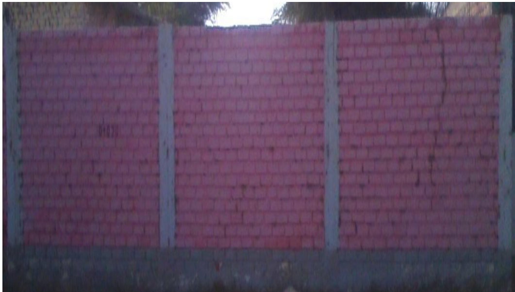
Gráfico 101: Patología de grieta en la muestra 3- Fuente: Elaboración propia 2016
