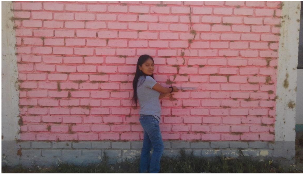
Gráfico 100: Patología de grieta en el muro - Fuente: Elaboración propia 2016
