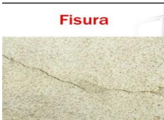
Gráfico 16: Fisura en la pared - Fuente:Mendez 28
