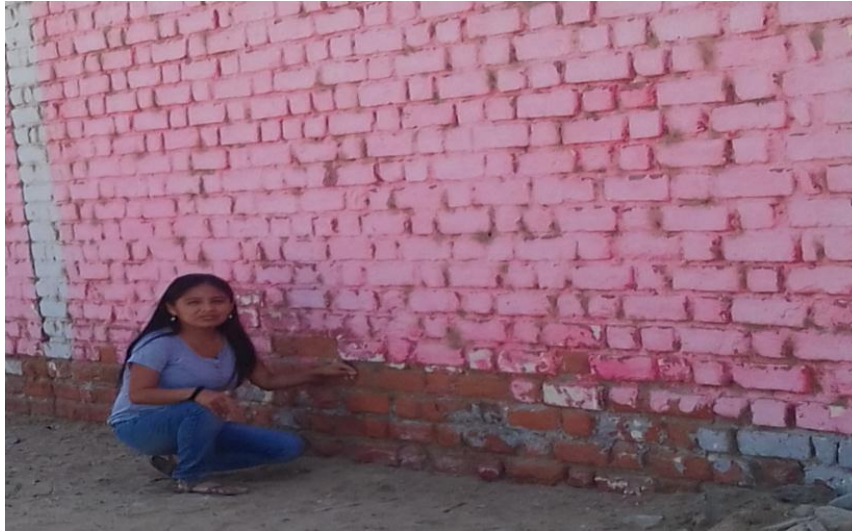
Gráfico 98: Patología de erosión física en el muro- Fuente: Elaboración propia 2016
