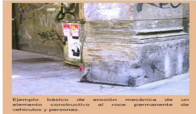
Gráfico 14: Erosión mecánica por roce de vehículos o personas- Fuente: Broto 25
