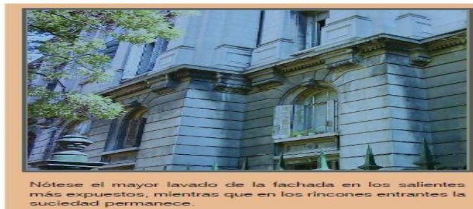
Gráfico 11: Suciedad en una fachada de edificio - Fuente: Broto 25
