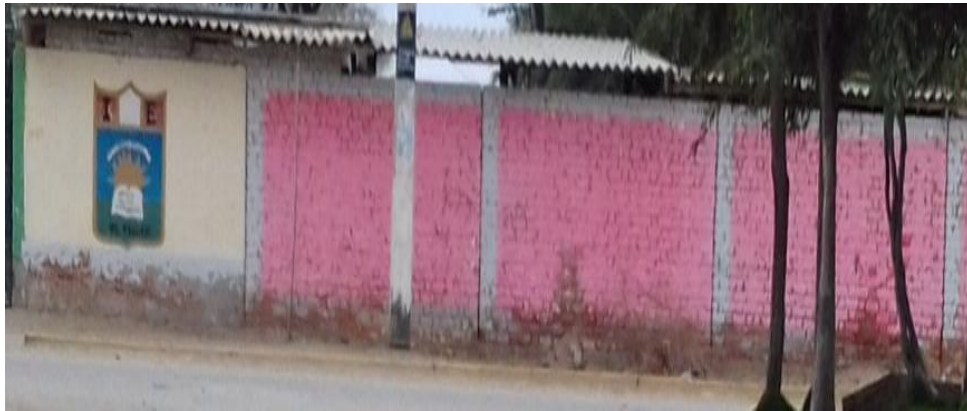
Gráfico 96: Patología de la erosión física en la unidad de muestra 1- Fuente: Elaboración propia 2016
