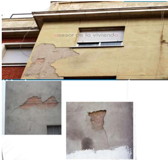
Gráfico 13: Desprendimiento en la pared - Fuente: Méndez 28
