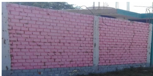
Gráfico 15: Grieta en pared – Fuente: Elaboración propia 2016
