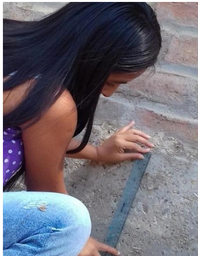
Gráfico 99: Patología de desprendimiento en el sobrecimiento - Fuente: Elaboración propia 2016
