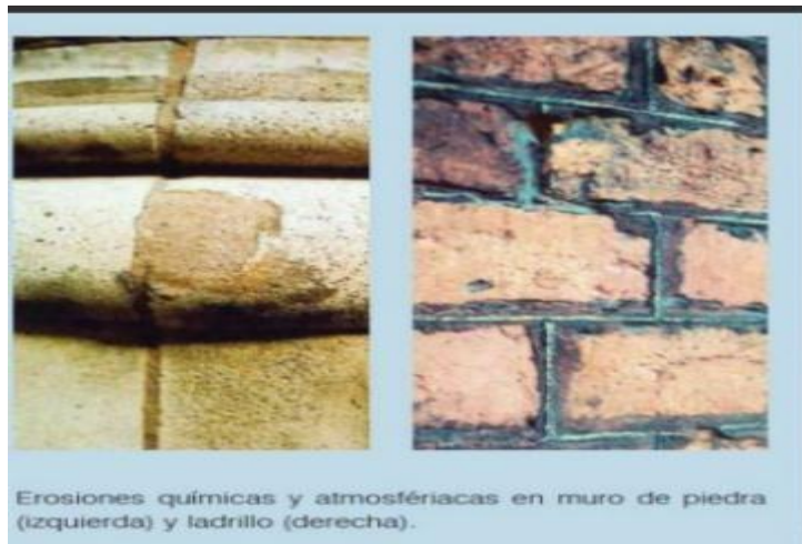
Gráfico 20: Erosiones químicas en muros - Fuente: Méndez 28
