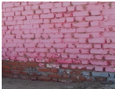
Gráfico 10: Muro con erosión física -Fuente: Elaboración propia 2016
