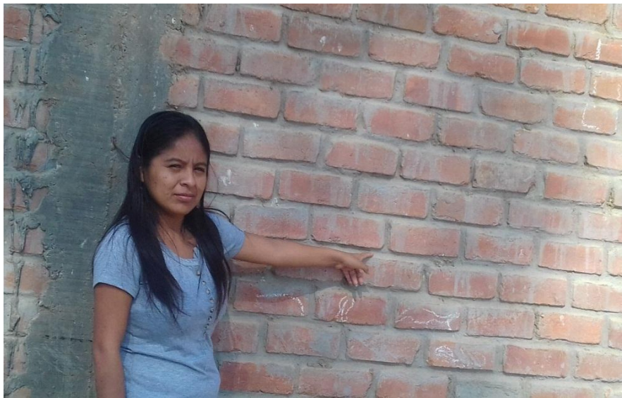
Gráfico 97: Patología de la eflorescencia - Fuente: Elaboración propia 2016
