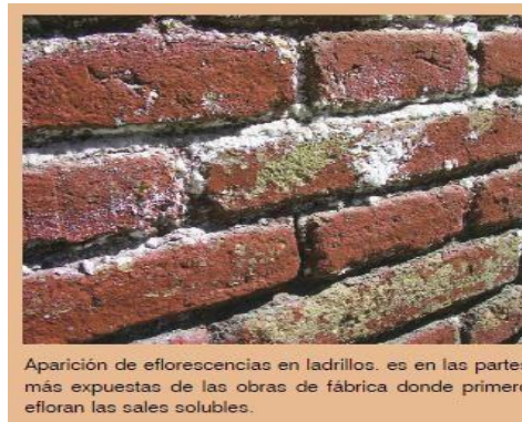
Gráfico 19: Eflorescencia en los ladrillos del muro - Fuente: Broto 25
