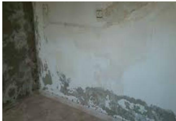
Gráfico 9: Humedad por filtración - Fuente: Díaz 7
