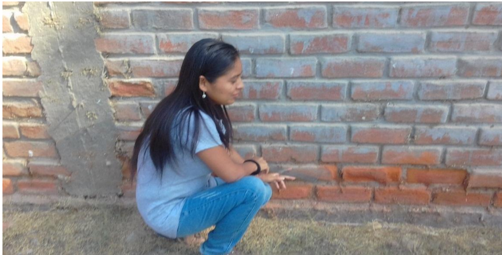
Gráfico 106: Patología de la humedad- Fuente: Elaboración propia 2016
