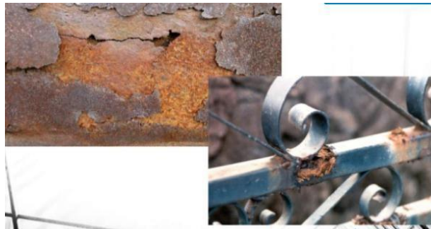
Gráfico 18: Corrosión - Fuente: Mendez 28
