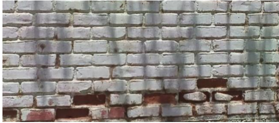
Grafico 02: Erosión en los muros
