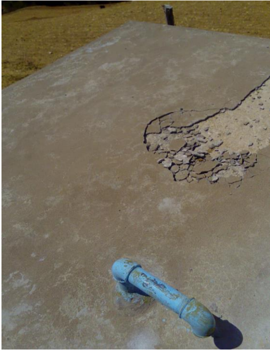
Ilustración XIX – FALLAS EN EL RESERVORIO
