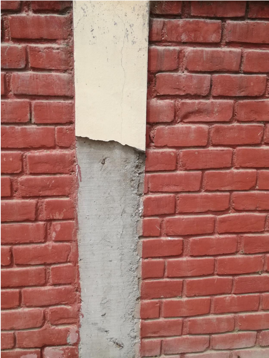
Imagen 21: Desprendimientos ubicada en la unidad de muestra 04.
