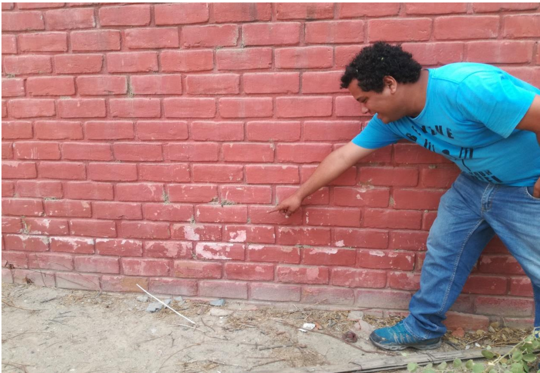
Imagen 12: Eflorescencia ubicada en la unidad de muestra 01.
