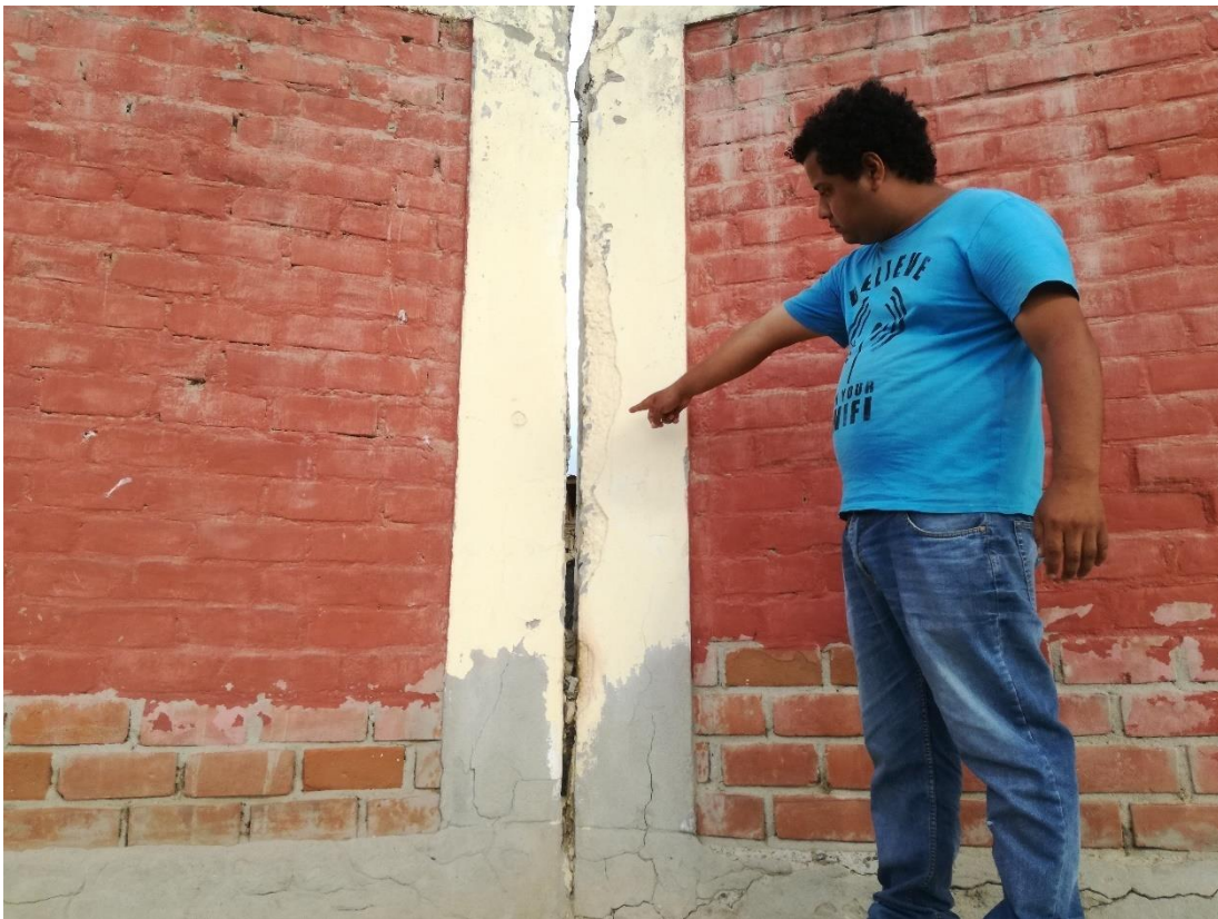
Imagen 17: Desprendimientos ubicada en la unidad de muestra 02.
