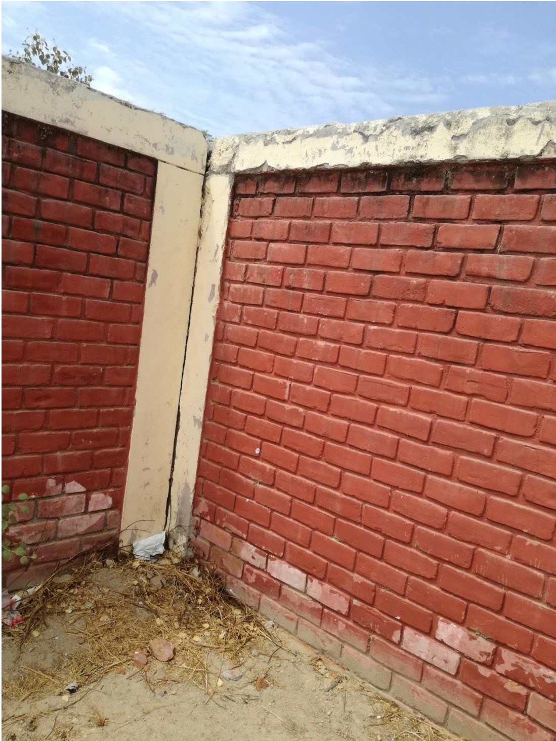
Imagen 20: Desprendimientos ubicada en la unidad de muestra 04.
