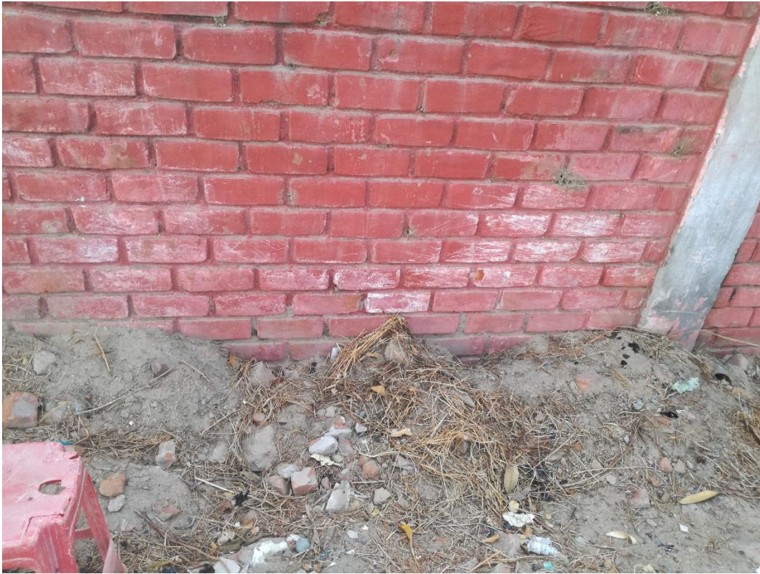
Imagen 23: Eflorescencia ubicada en la unidad de muestra 06.
