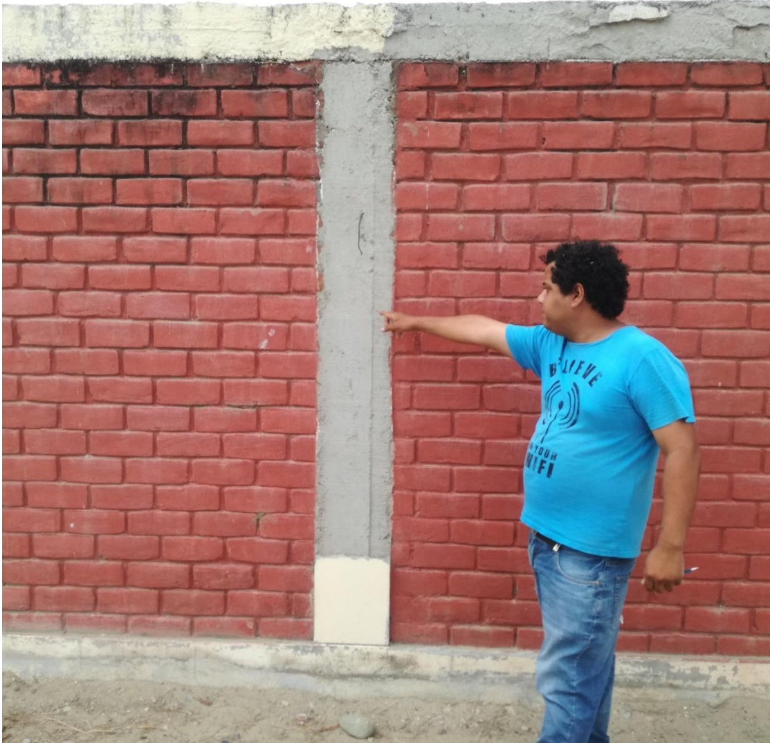
Imagen 13: Corrosión ubicada en la av. Independencia unidad de muestra 01.
