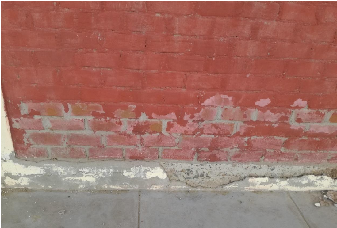
Imagen 18: Eflorescencia ubicada en la unidad de muestra 03.
