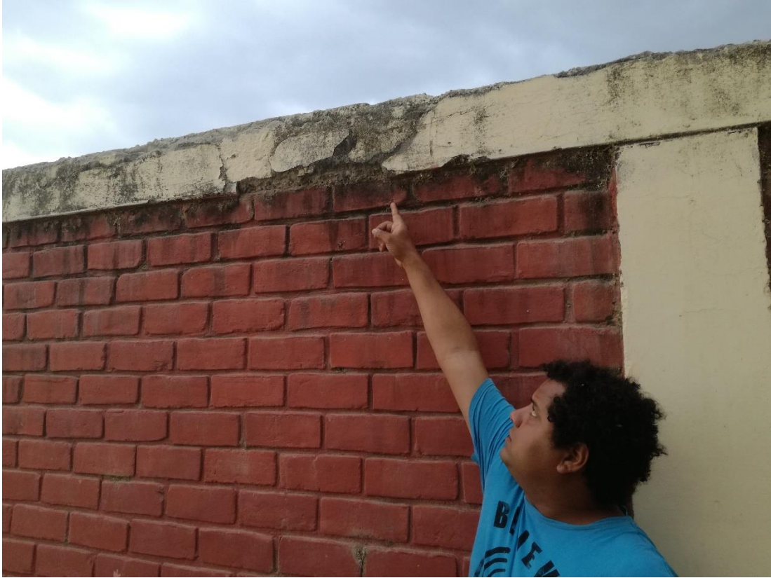
Imagen 11: Desprendimientos ubicada en la unidad de muestra 01.
