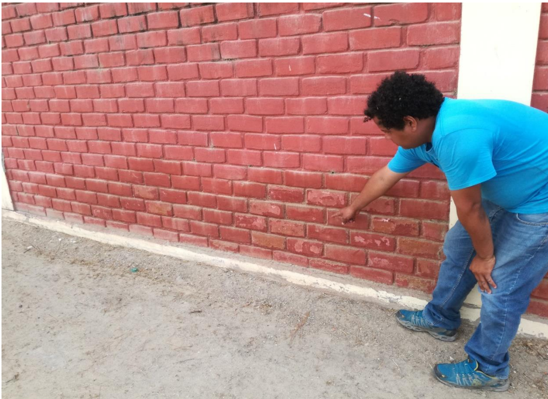
Imagen 24: Humedad ubicada en la unidad de muestra 09.
