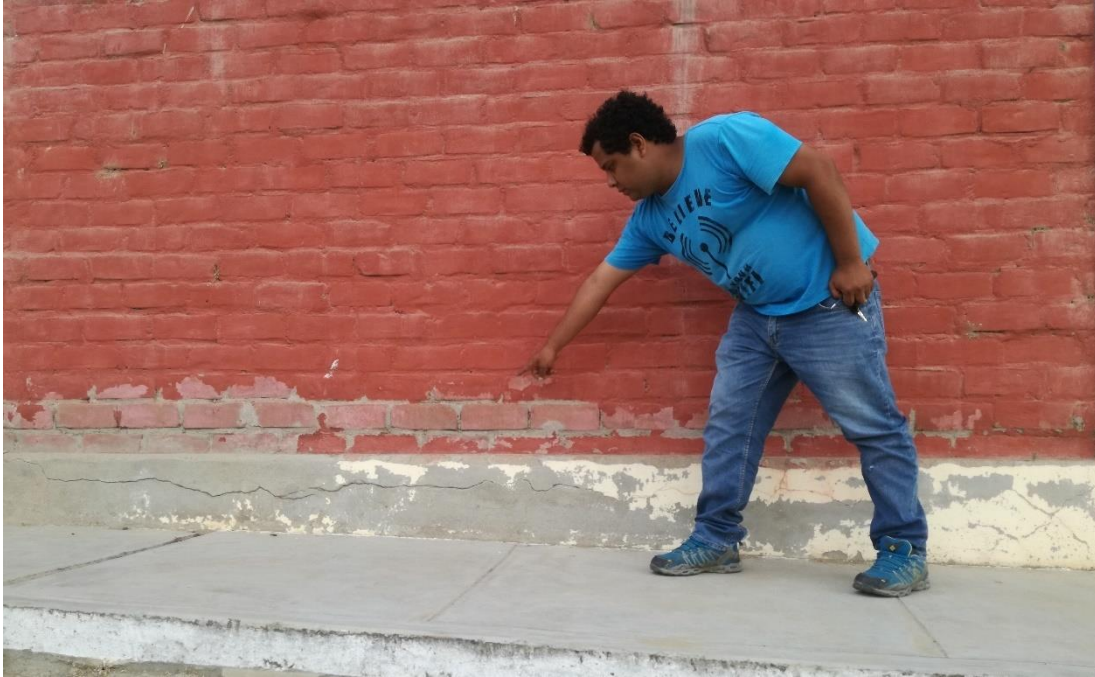
Imagen 16: Eflorescencia ubicada en la unidad de muestra 02.
