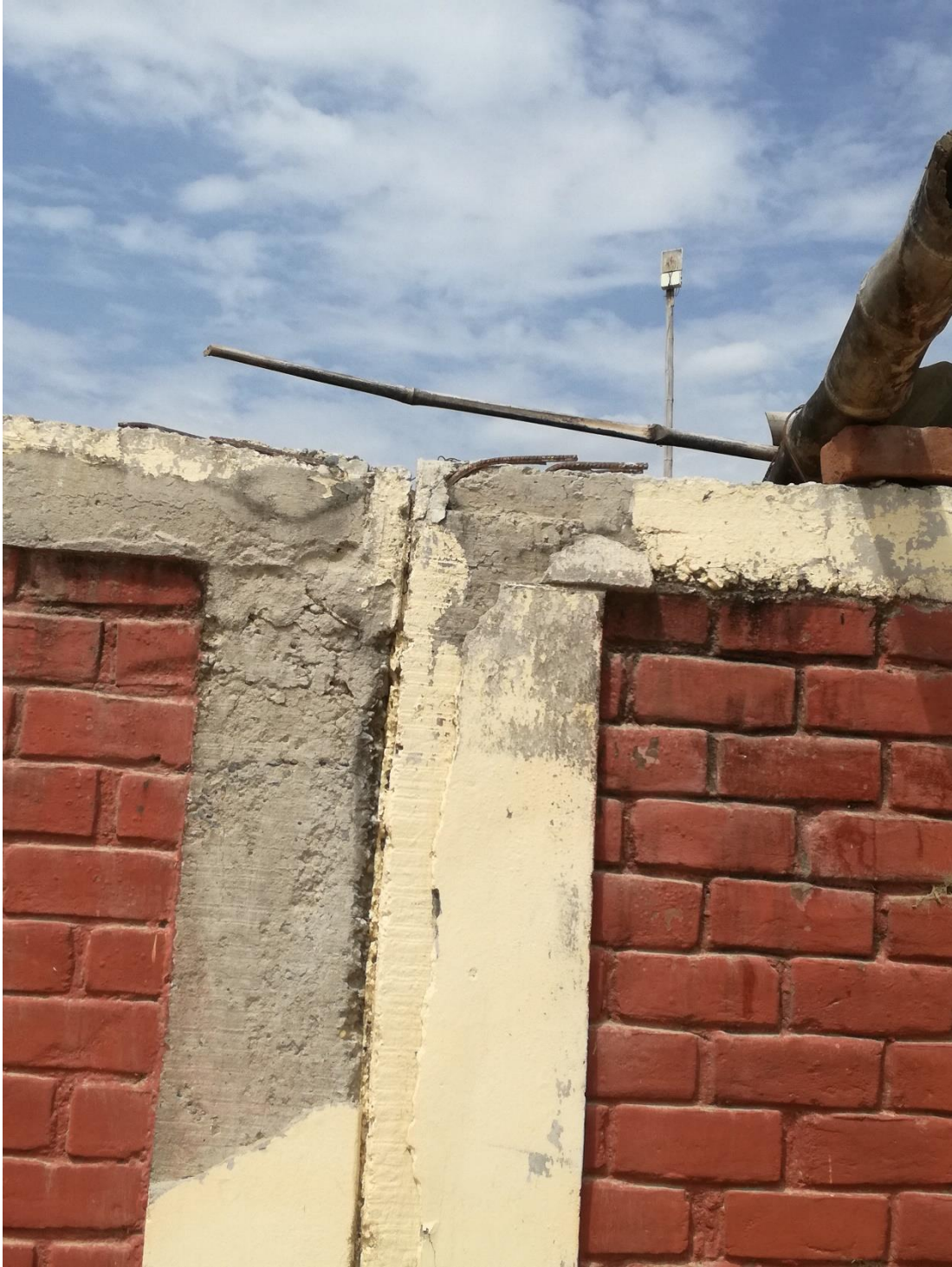
Imagen 22: Desprendimientos ubicada en la unidad de muestra 05.
