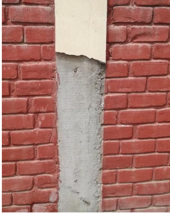
Imagen 6: Desprendimiento Fuente: Elaboración propia
