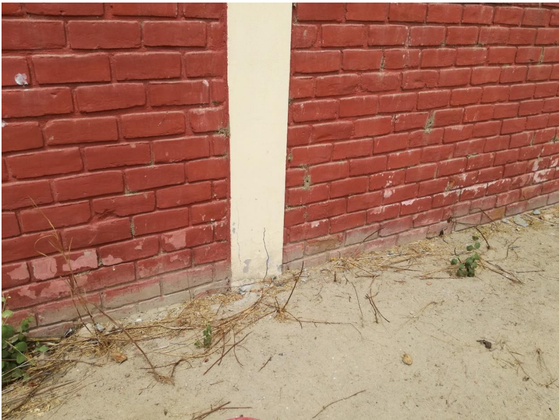
Imagen 19: Eflorescencia ubicada en la unidad de muestra 04.
