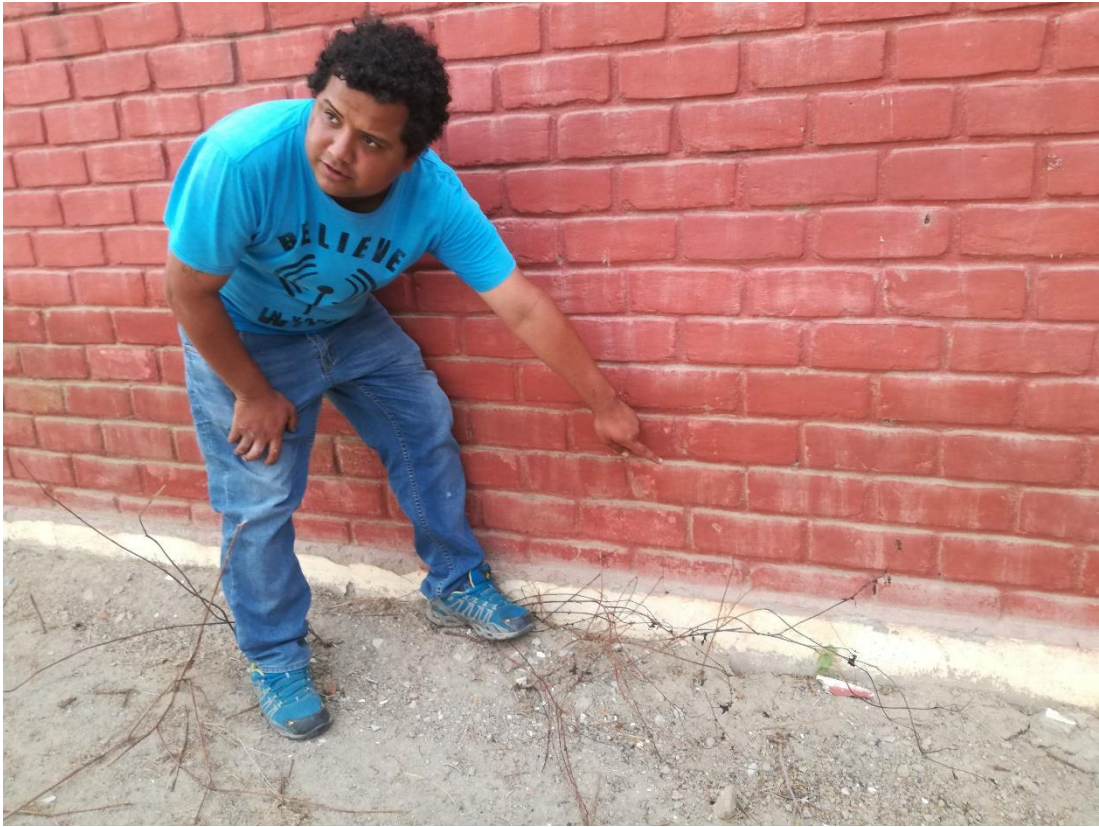
Imagen 25: Humedad ubicada en la unidad de muestra 09.
