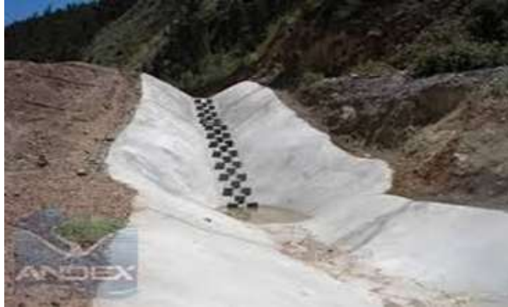
Imagen 03: Canal revestido con mortero.
