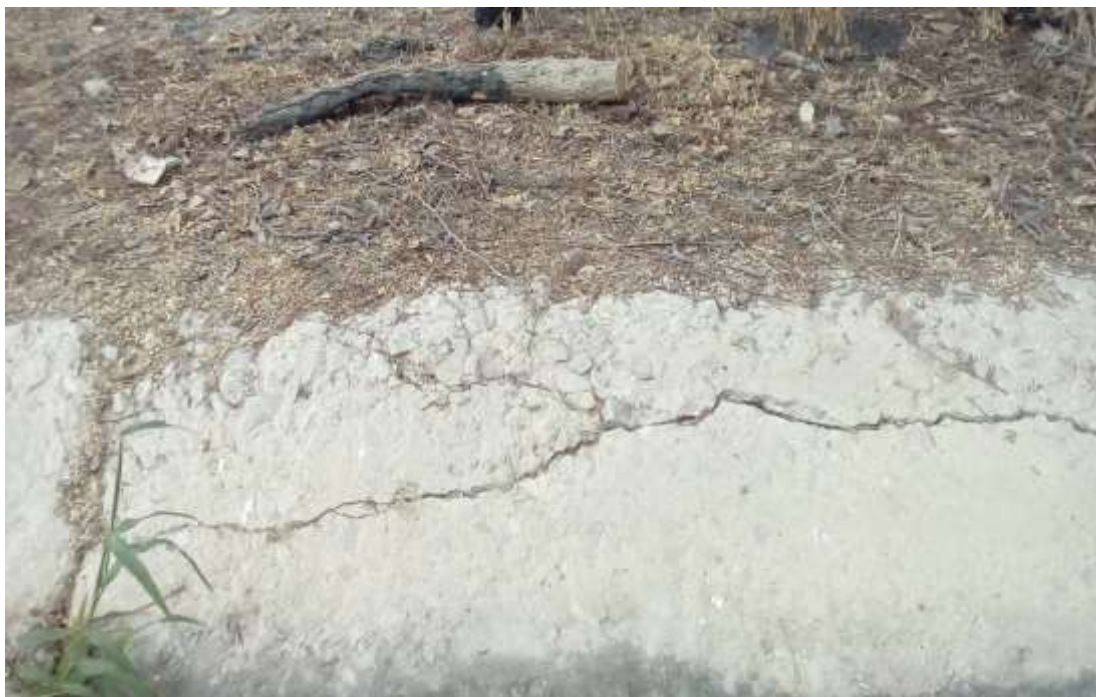
Imagen 24. Grietas horizontal en canal sub lateral 9+265.
