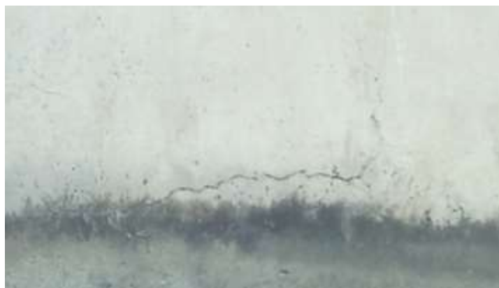
Imagen 11: Fisuras en canal de concreto.
