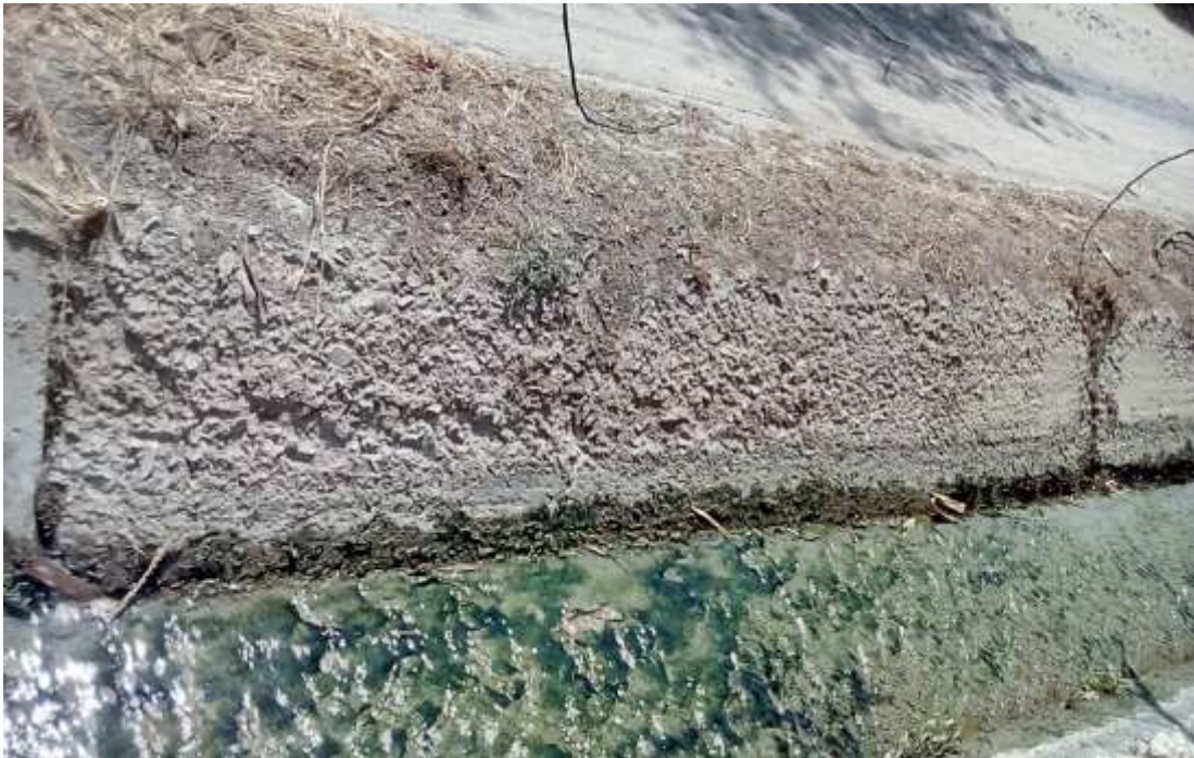
Imagen 28. Erosión presente en margen izquierdo del canal sub lateral 9+265.
