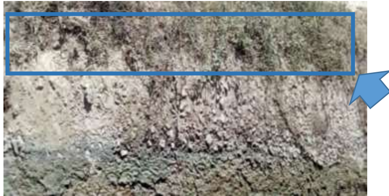
Imagen 17: Desintegración de partículas en canal de concreto.
