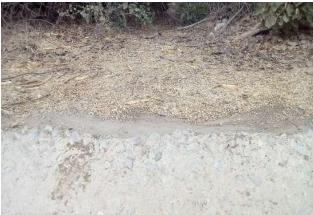
Imagen 31. Desintegración en parte superior del margen derecho del canal.
