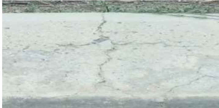
Imagen 09: Grietas vertical en canal de concreto.
