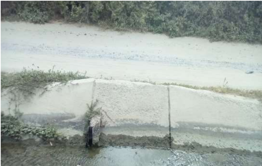
Imagen 30. Decascaramiento en margen izquierdo del canal sub lateral 9+265.
