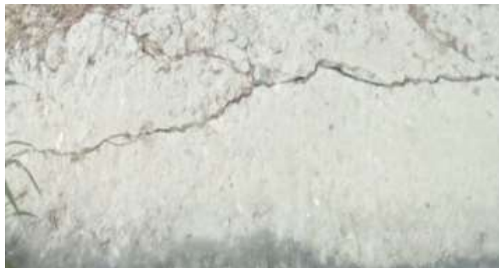
Imagen 10: Grietas horizontal en canal de concreto.
