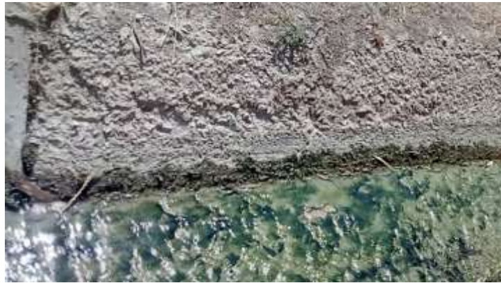
Imagen 18: Decascaramiento en canal de concreto.
