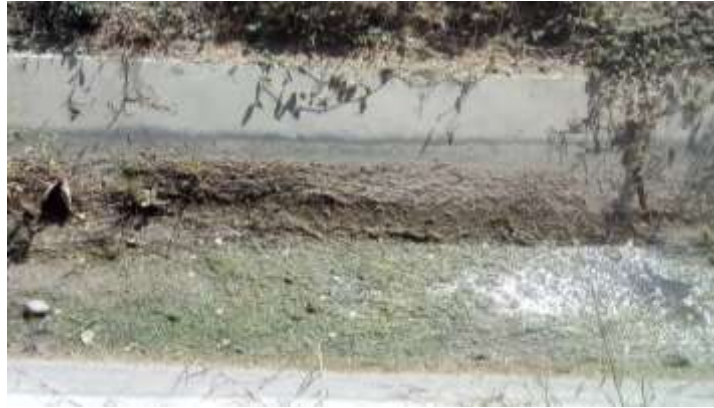
Imagen 19: Sedimentación en canal de concreto.
