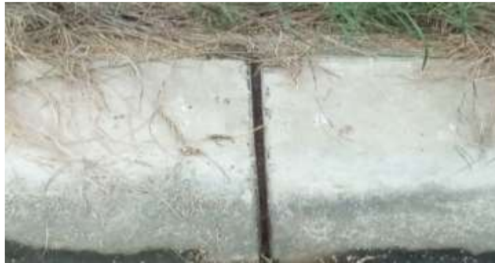
Imagen 13: Deterioro de sello de junta en canal de concreto.
