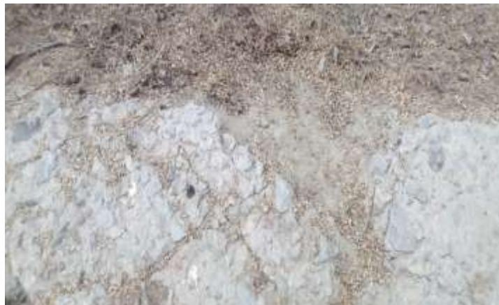
Imagen 16: Desintegración de partículas en canal de concreto.
