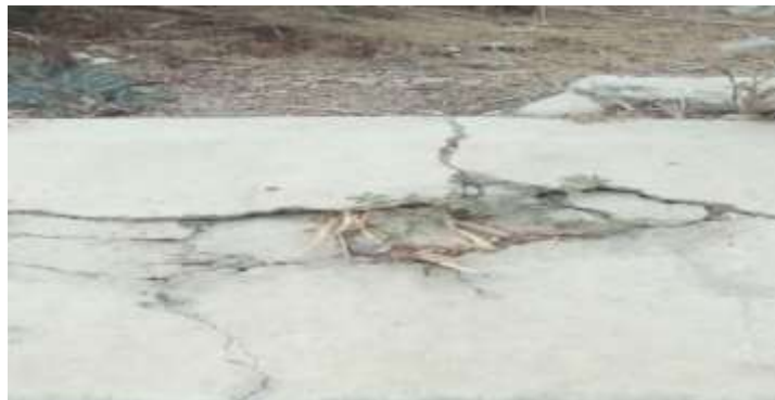
Imagen 15: Erosión en canal de concreto.
