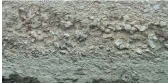
Imagen 14: Erosión en canal de concreto.
