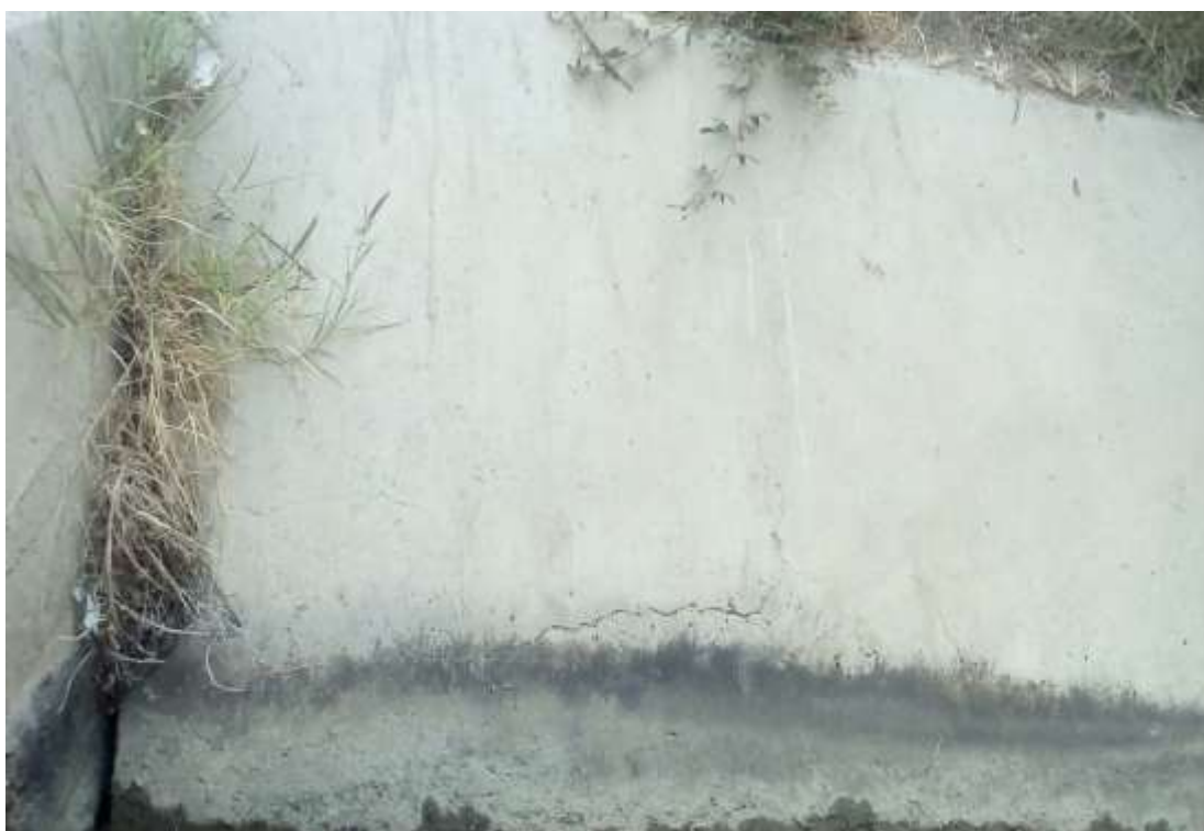
Imagen 25. Fisuras en canal sub lateral 9+265.
