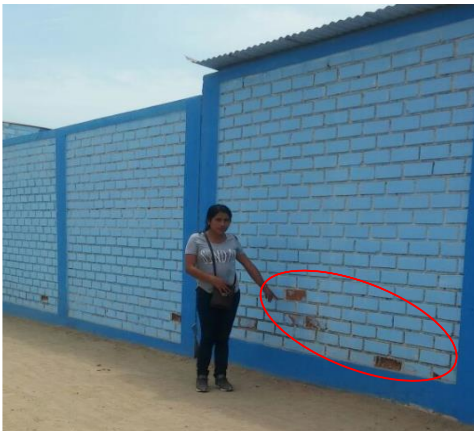
Fotografía N°02. Erosión en muros en la Unidad de Muestra N°13
