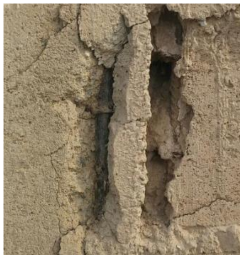
Imagen N°08: Corrosión en acero de columna
