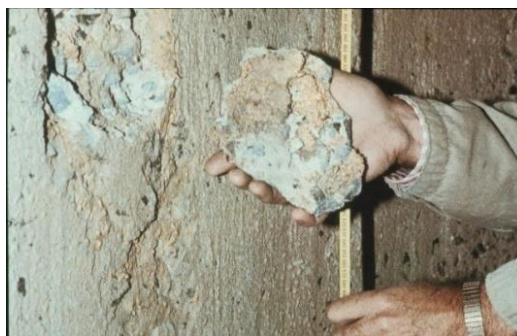
Imagen N°04: Desintegración del concreto
