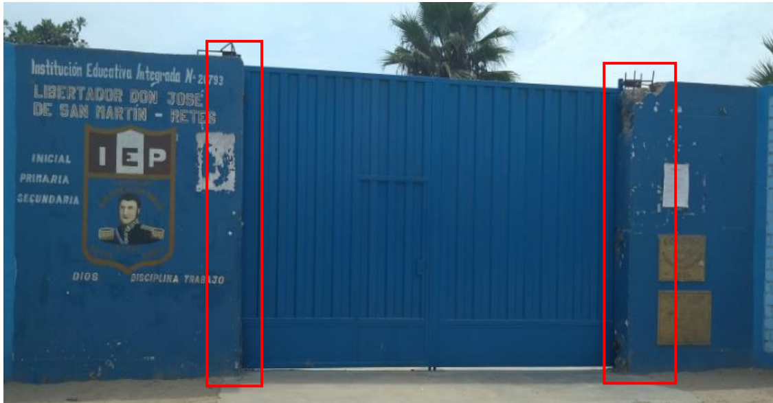
Fotografía N°03. Desintegración en columnas en la Unidad de Muestra N°08
