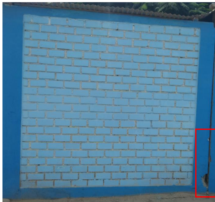
Desintegración en columnas en la Unidad de Muestra N°10
