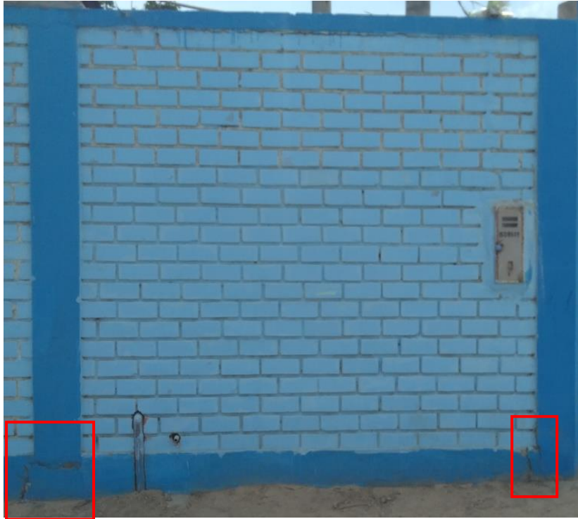
Fotografía N°04. Grietas en columnas en la Unidad de Muestra N°06.
