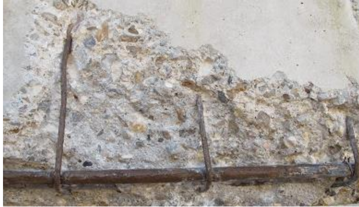
Imagen N°08: Oxidación en varillas
