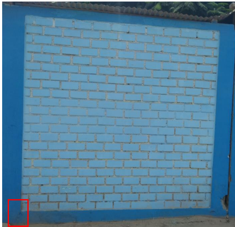
Fotografía N°05. Fisura en columna en la Unidad de Muestra N°10
