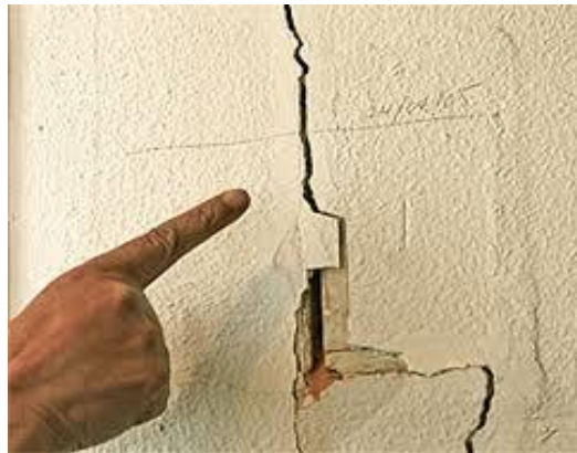
Imagen N°05: Grieta en muro.
