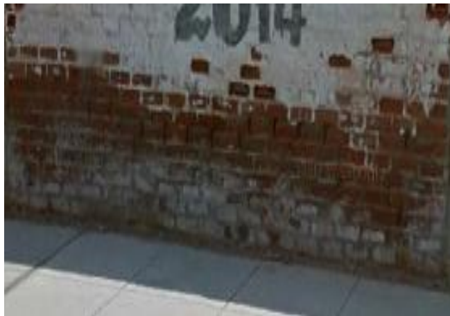
Figura 13: Eflorescencia en muros.
