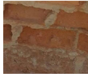
Desintegración de muro.
