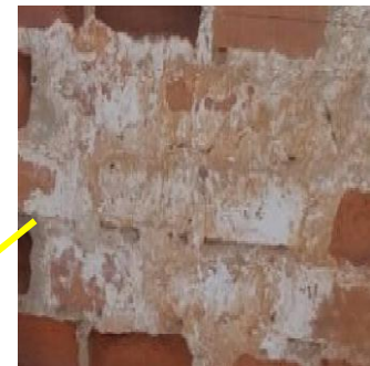
Eflorescencia en la unidad de muestra 01
