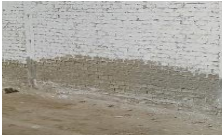
Figura 10. Erosión química en los muros
