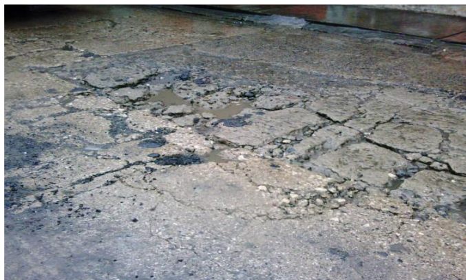
Figura 14. Desintegración en el concreto.
