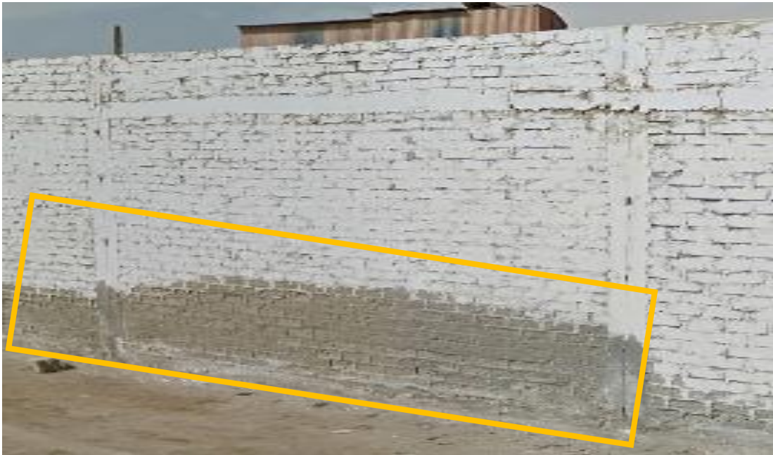
Fotografía 07: Se aprecias erosión en el cerco perimétrico del centro de producción ubicado en el pueblo joven Villa María.
