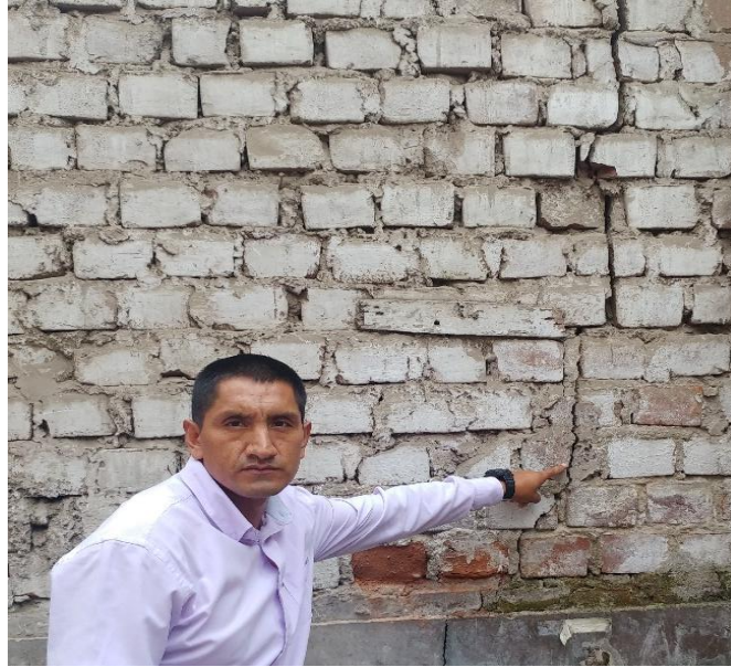
Figura 09. Grieta en muros
