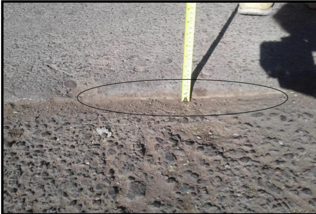
Figura 08: Patología tipo hundimiento de severidad alta ubicado en Jr. Roma.
