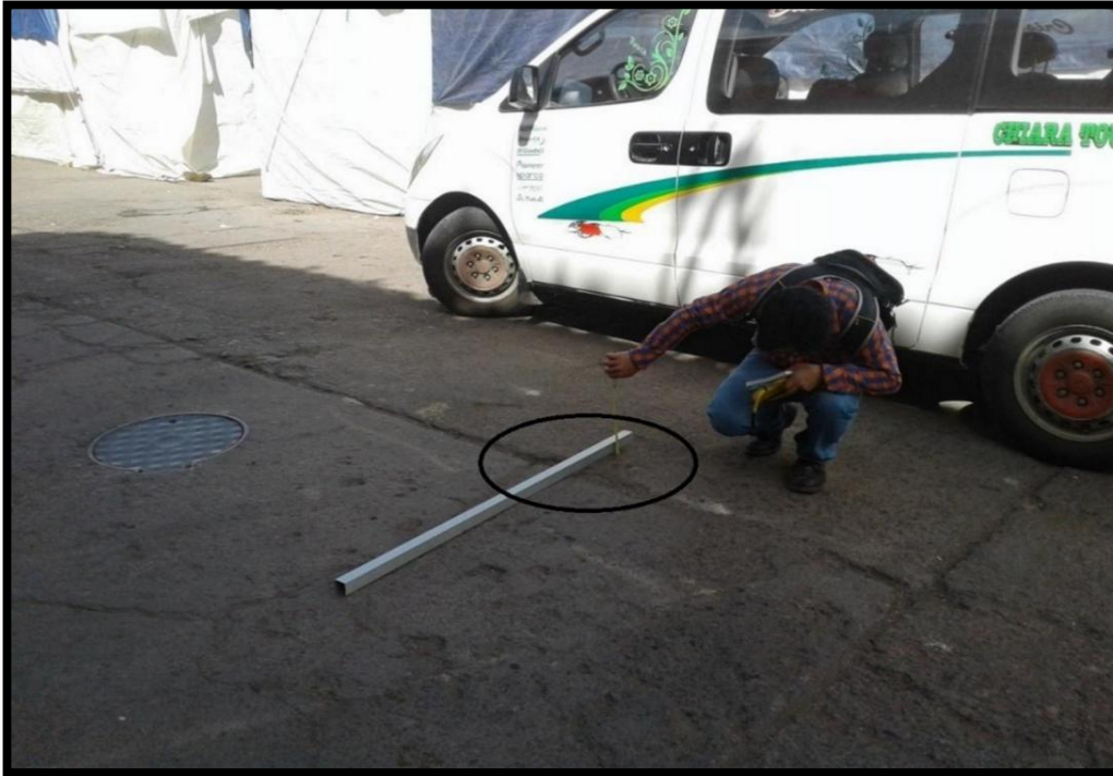
Figura 07: Patología tipo hundimiento de severidad media ubicado en Jr. La Unión.
