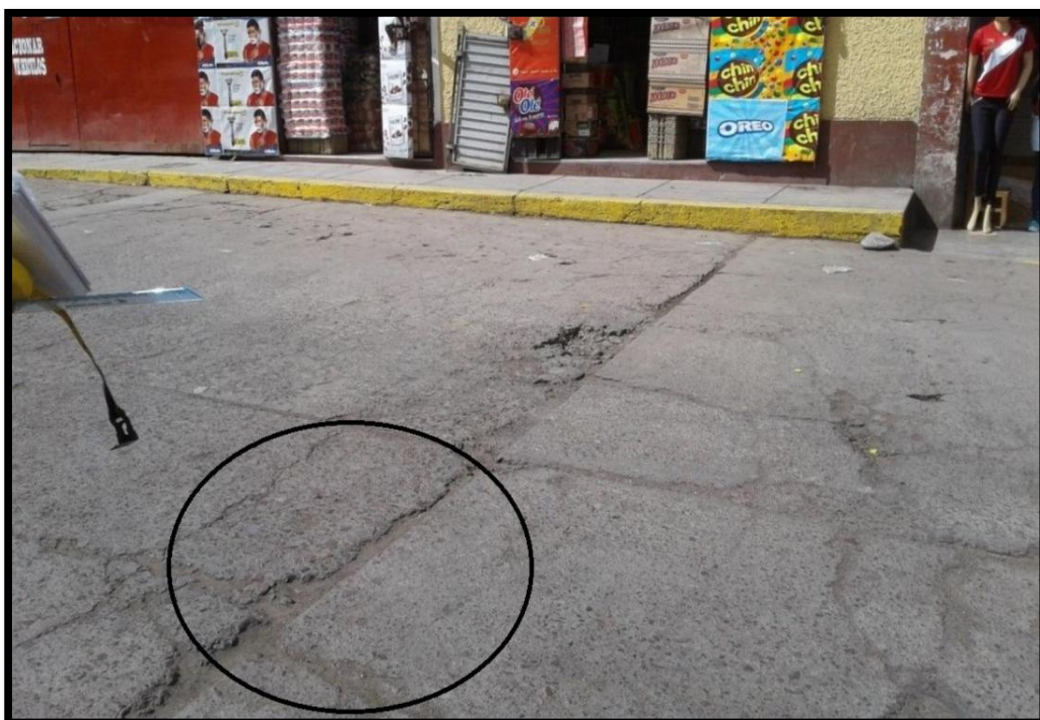
Figura 10: Patología tipo descascamiento de junta de alta severidad ubicado en Jr. Miller.
