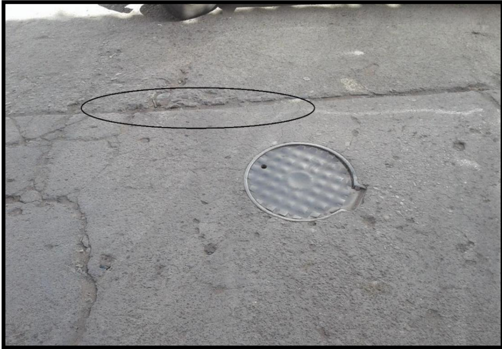
Figura 11: Patología tipo descascaramiento de junta de alta severidad ubicado en Jr. Miller.
