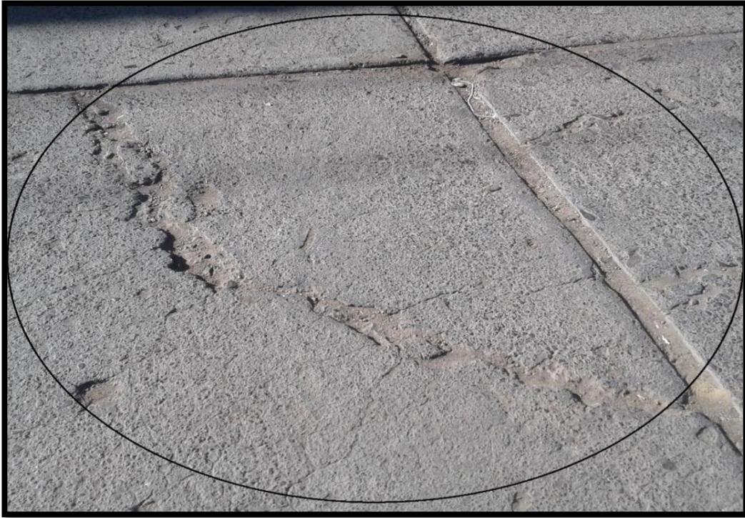
Figura 13: Descripción de las c Patología tipo grieta de esquina con severidad alta ubicado en Jr. La Unión – Barrio Magdalena.
