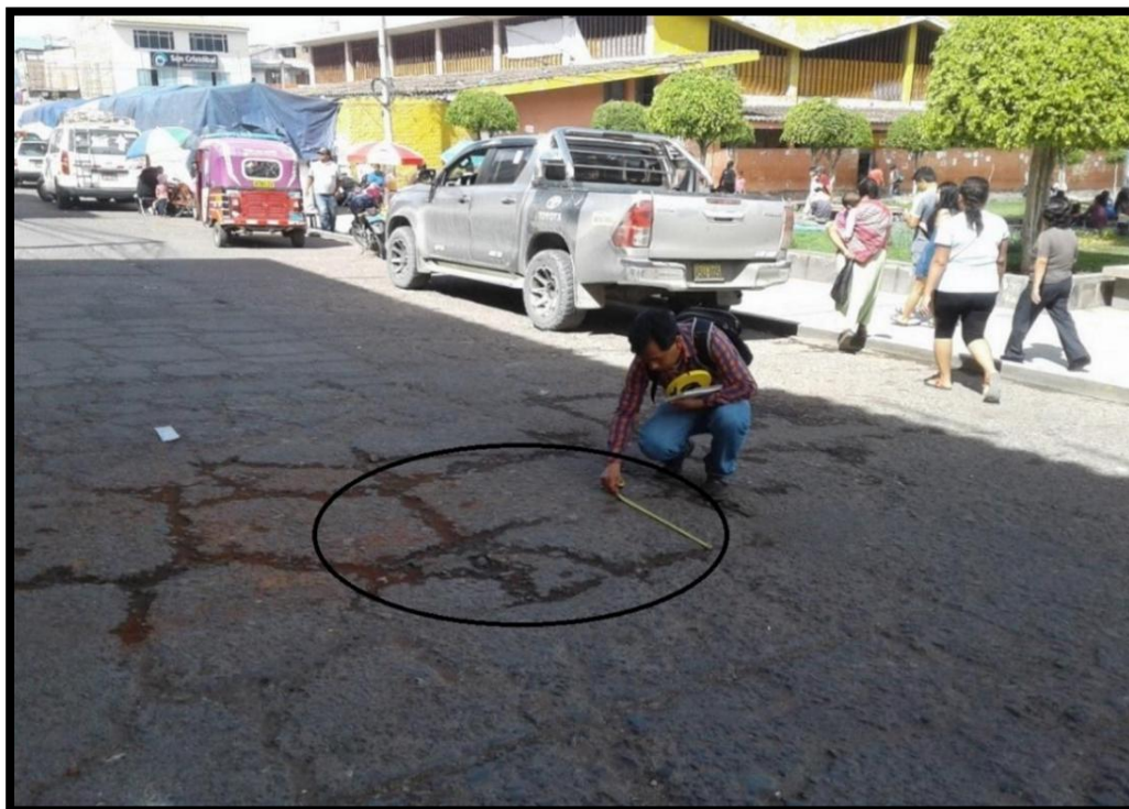
Figura 01: Patología tipo Losa dividida con severidad alta ubicado en Jr. La Unión.
