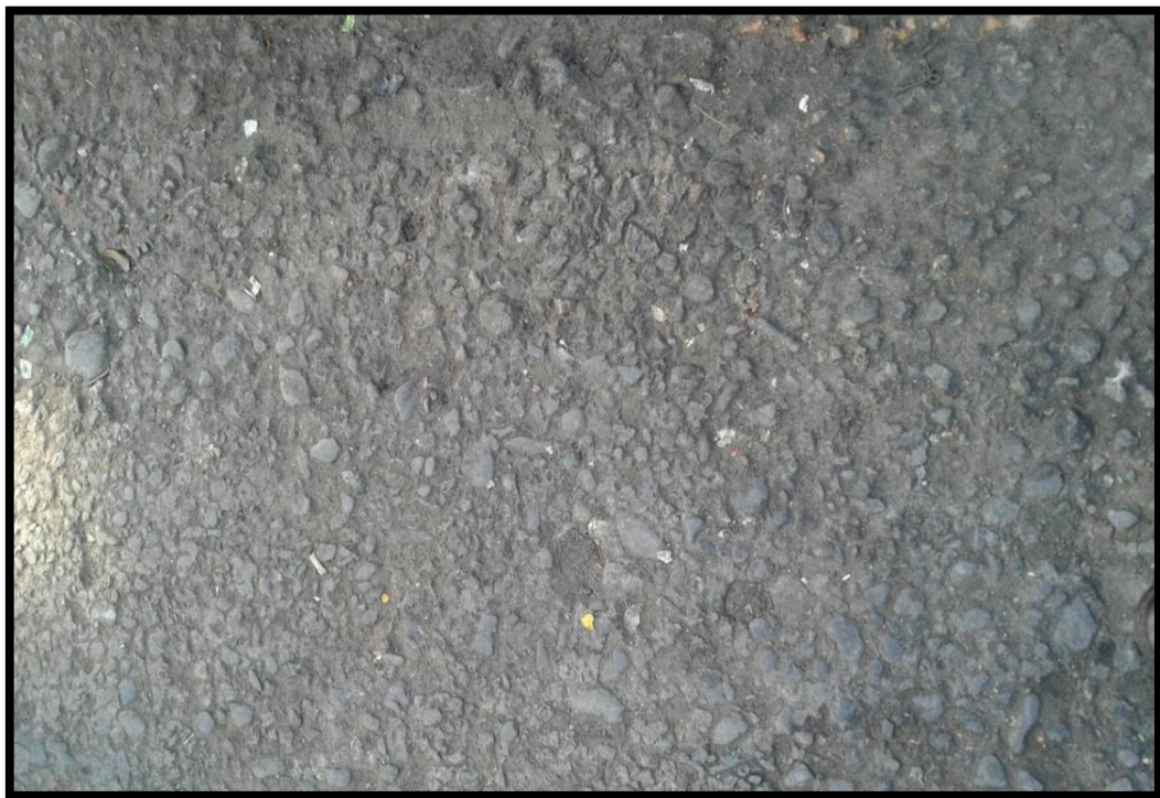
Figura 04: Patología tipo pulimiento de agregado ubicado en el Jr. Unión.
