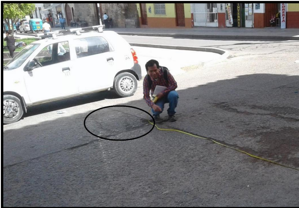
Figura 12: Patología tipo grieta de esquina con media severidad ubicado en Jr. La Unión – Barrio Magdalena.
