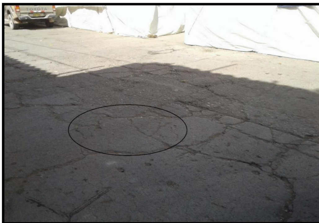
Figura 02: Patología tipo Losa dividida con severidad media ubicado en Jr. La Unión.
