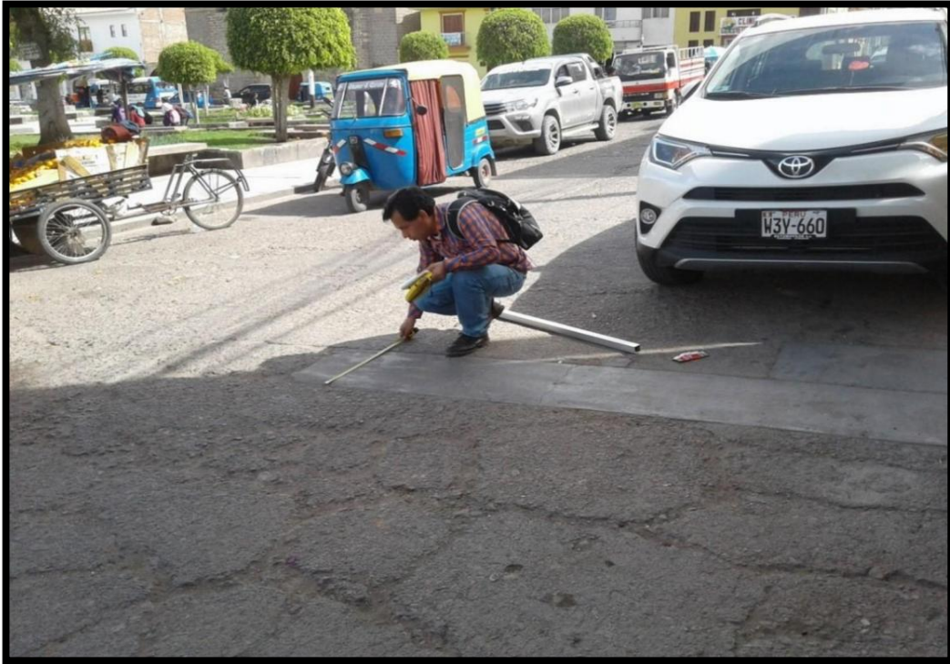
Figura 05: Patología tipo parche grande con media severidad ubicado en el Jr. La Unión.
