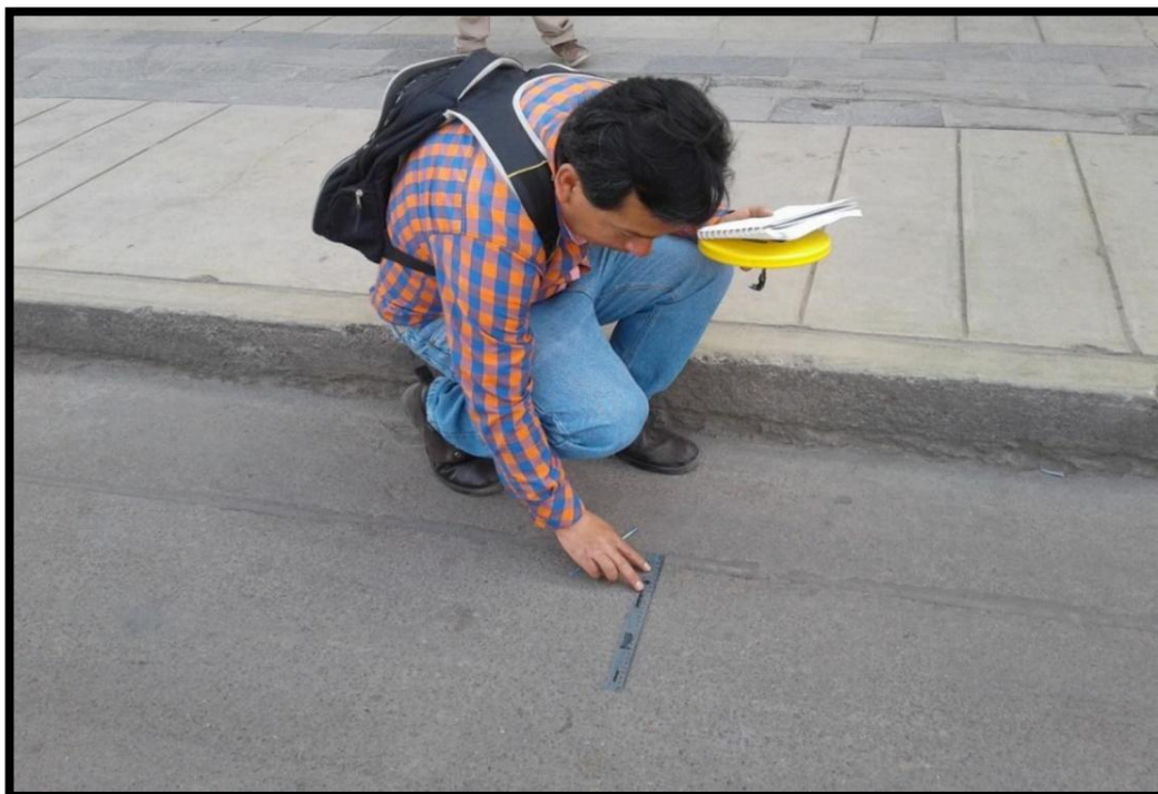
Figura 09: Parche pequeño de baja severidad ubicado en Jr. Miller.
